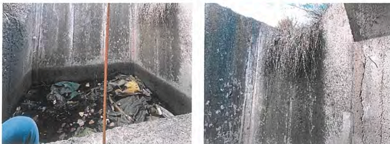
Foto 26 – Sisteme de colectare și evacuare colmatate
