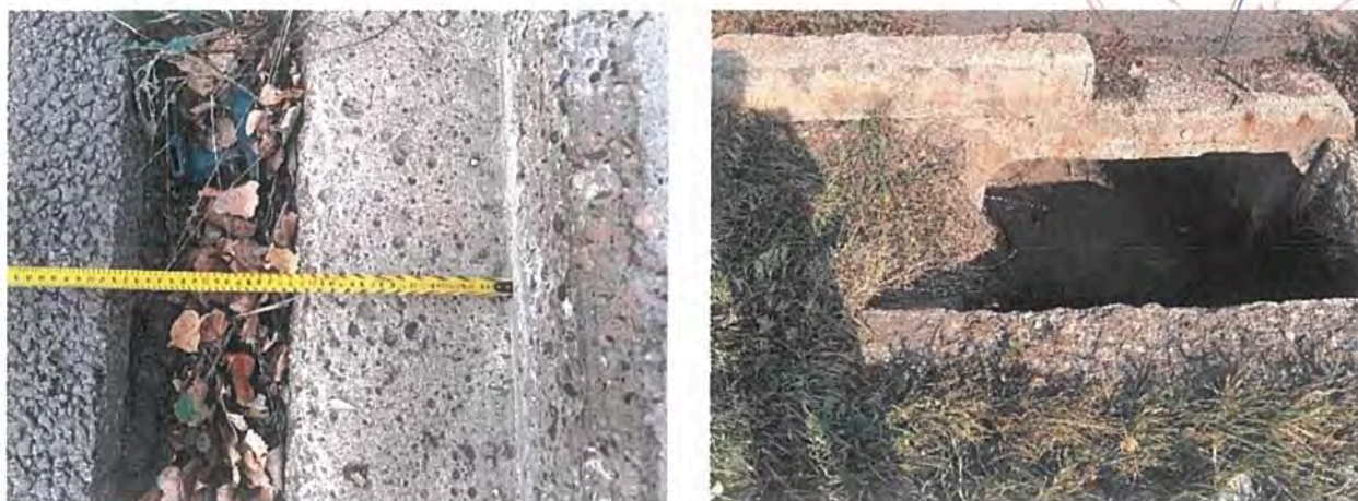
Foto 25 – Deplasări ale timpanelor
