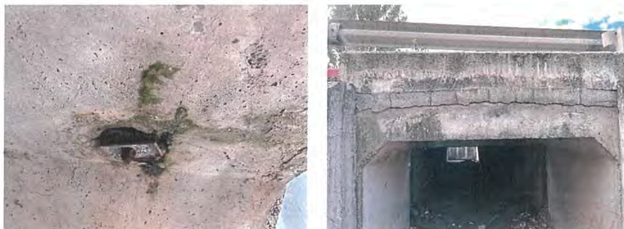
Foto 24 – Defecțiuni ale elementelor din beton
