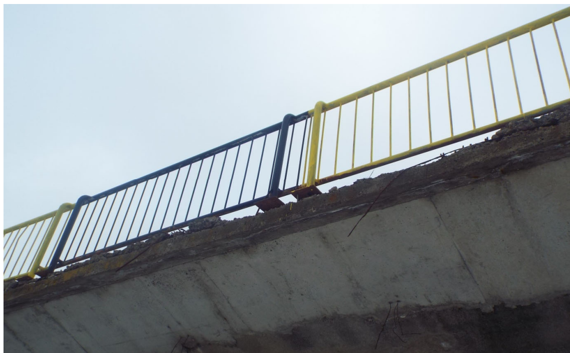
Foto 10. Vedere lisa parapet / vedere parapet pietonal - beton cazut din lisa, prinderea stalpilot de parapet necorespunzatoare, parapet metalic ruginit
