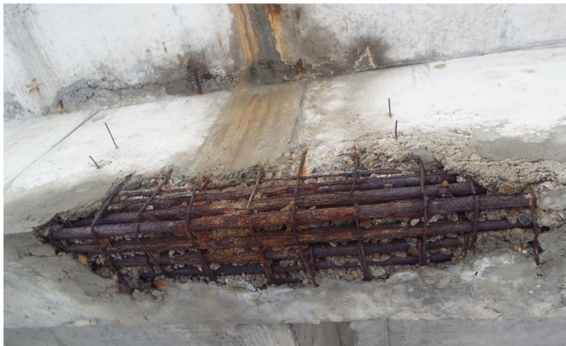
Foto 8. Vedere intrados grinda – infiltratii, armatura corodata, beton degradat
