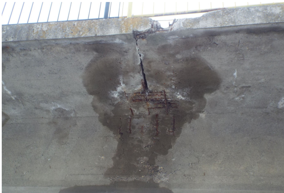
Foto 9. Vedere rost in consola trotuar – infiltratii prin rost, armatura ruginita la vedere, carbonatari, beton degradat in lisa parapet, armatura ruginita la vedere in lisa parapet
