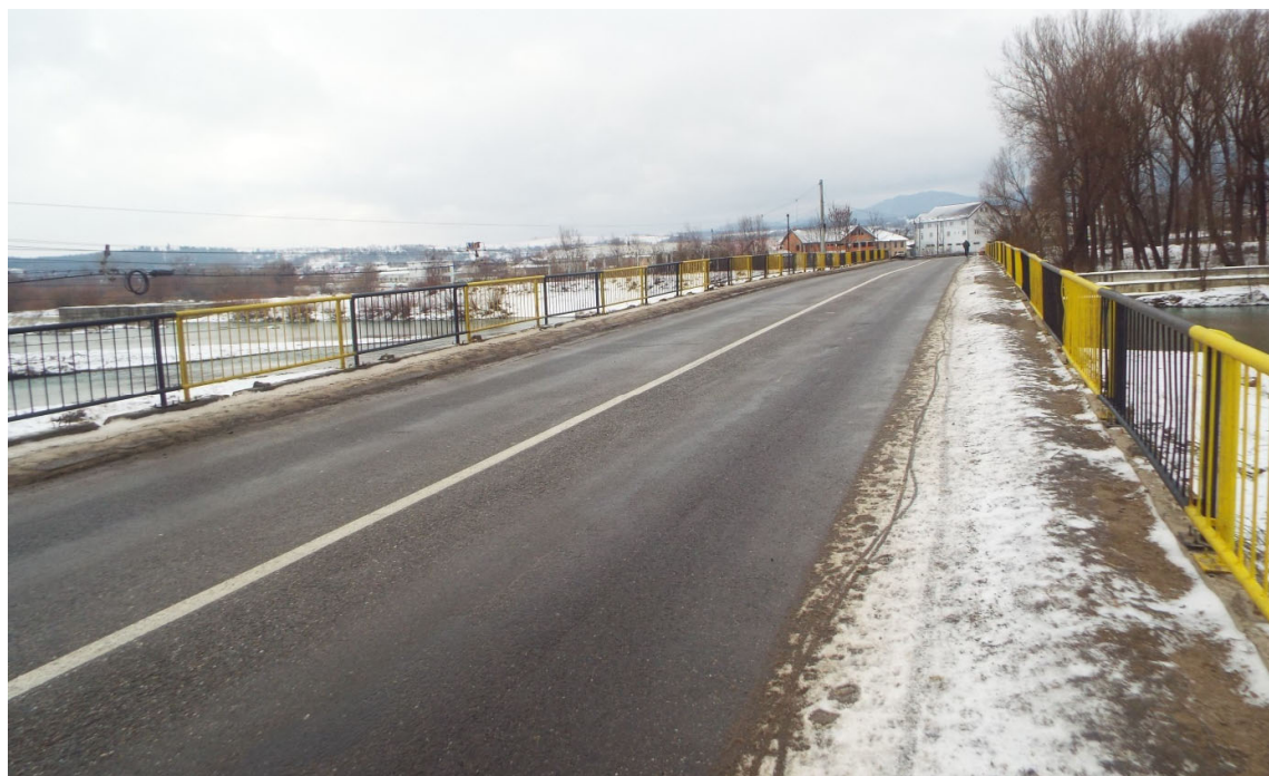
Foto 2. Vedere cale pod
