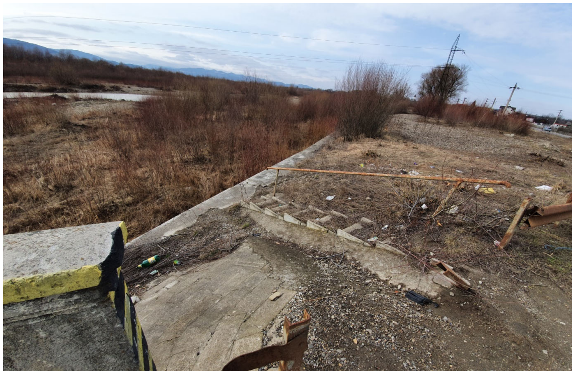
Foto 13. Vedere sfert de con, scara acces sub pod, casiu – material solid la baza pereului, scara acoperita cu vegetatie, mana curenta scara degradata, depuneri de material solid in casiu
