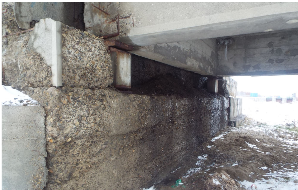
Foto 3. Vedere elevatie culee – infiltratii puternice prin rostul de dilatare, beton de slaba calitate deteriorat, agregate neinglobate in pasta de ciment, materialul metalic din penduli este ruginit, armatura ruginita in grinda in zona de rezemare
