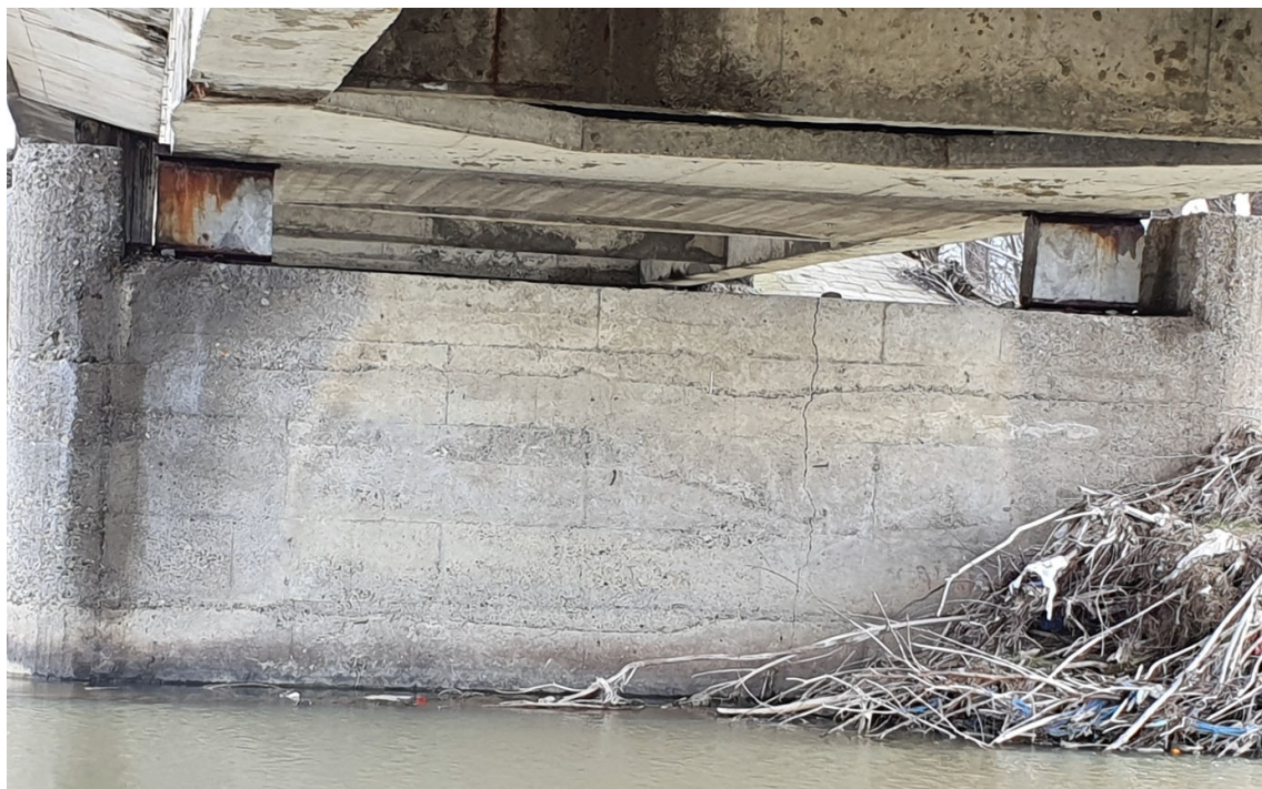
Foto 14. Vedere pila in albie – fisura in elevatie, depuneri de aluviuni pe capat amonte pila
