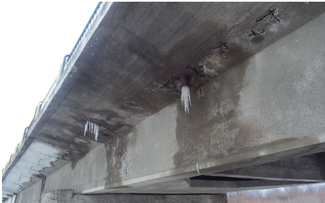
Foto 7. Vedere grinda si consola – infiltratii prin rostul din consola, infiltratii puternice in zona gurilor de scurgere, beton degradat, armatura ruginita la vedere, carbonatari, lipsa tubprelungitor gura de scurgere
