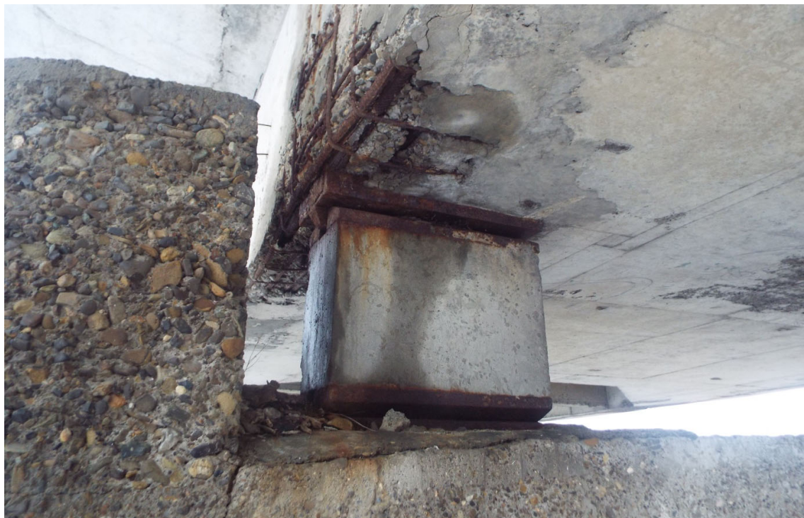
Foto 5. Vedere rezemare suprastructura pe pila – beton de slaba calitate in elevatie pila, material metalic ruginit la aparatul de reazem, armatura corodata intrados grinda, beton degradat in grinda
