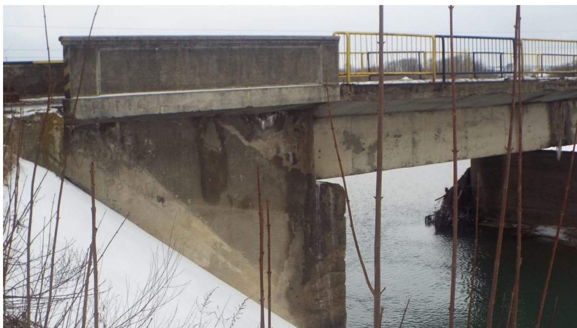
Foto 4. Vedere zid intors culee - infiltratii puternice, beton degradat, culoare neuniforma a betonului
