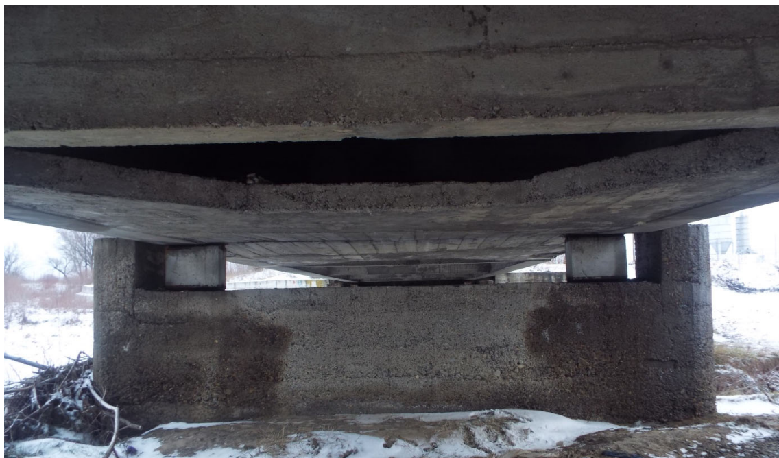
Foto 6. Vedere elevatie pila – infiltratii in bancheta si elevatie prin rosturile din consola, suprafata neuniforma a betonului, fisuri
