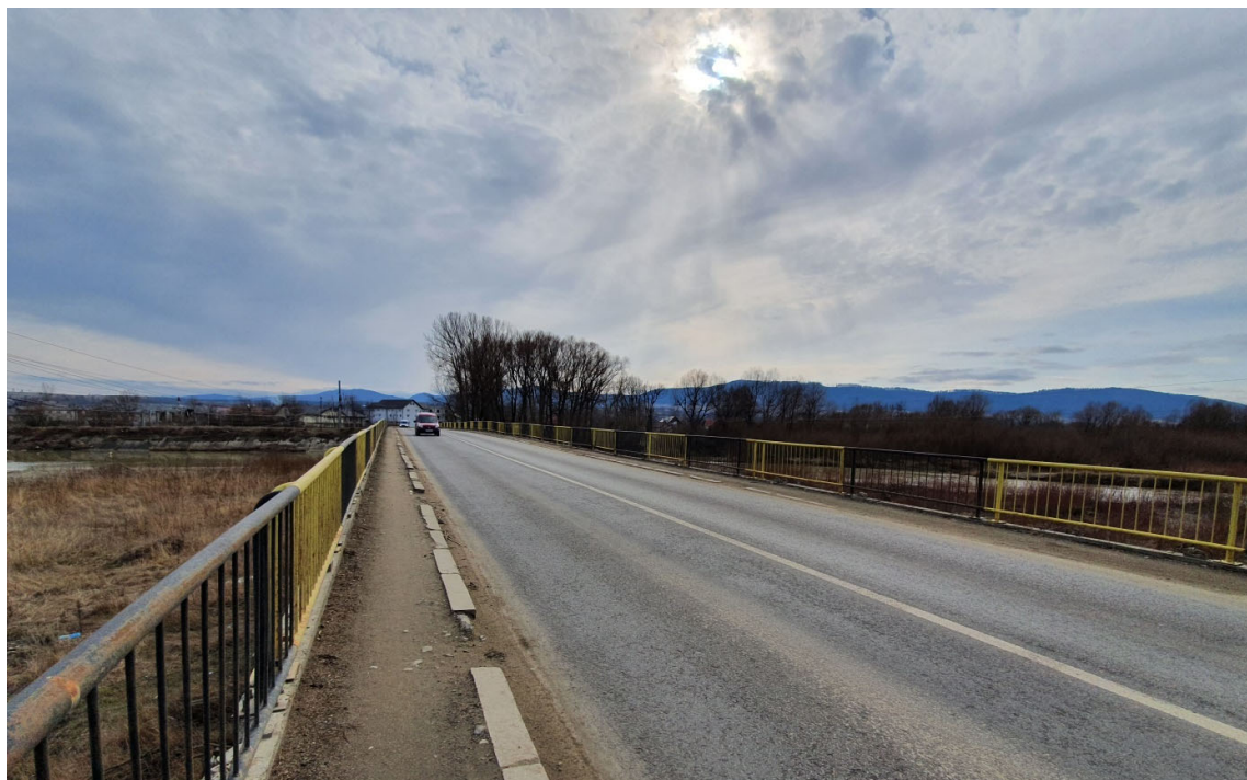
Foto 12. Vedere cale, rotuar, parapet – cale in stare relativ buna, bordura deteriorata, depuneri de material solid pe trotuar si la marginea caii, parapet pietonal ruginit
