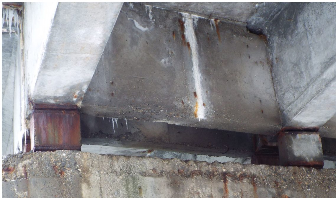
Foto 8. Vedere bancheta pila - beton deteriorat, material metalic aparate de reazem ruginit, penduli din beton armat acoperiti cu oxizi de fier, infiltratii in antretoaza
