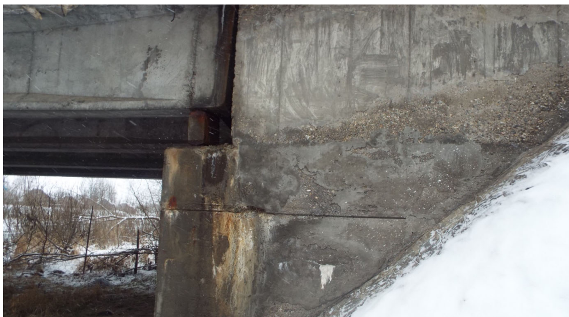
Foto 4. Vedere laterala culee - infiltratii puternice in bancheta si elevatie, pete de rugina, pete negre, suprafata neuniforma a betonului, pendul din beton armat acoperit cu oxizi de fier
