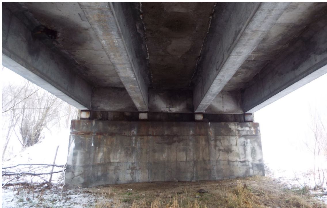
Foto 3. Vedere elevatie culee / vedere intrados suprastructura – infiltratii puternice in elevatie, beton deteriorat, pete de rugina / infiltratii in placile monolite, infiltratii in grinzi in dreptul gurilor de scurgere, pete de rugina la intradosul grinzilor, rost neetans intre placa monolita si grinzi
