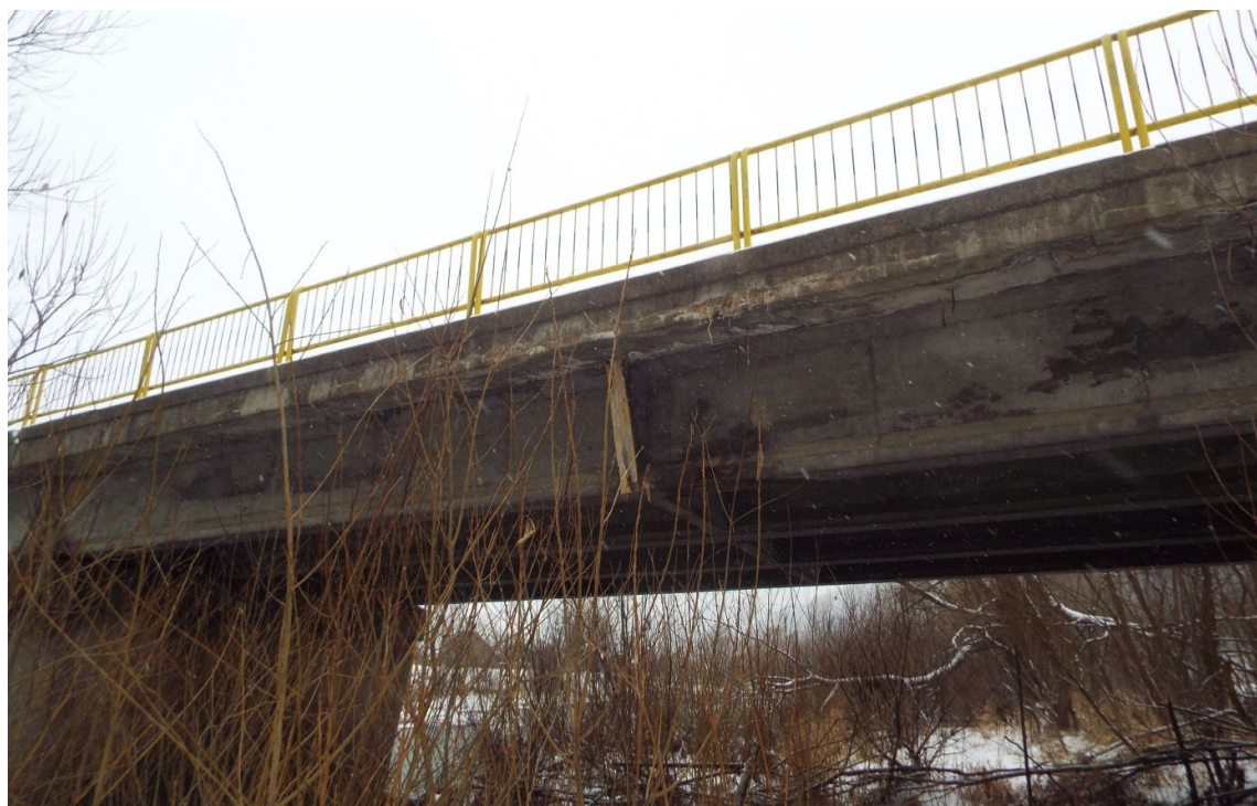
Foto 9. Vedere grinda marginala si consola trotuar – infiltratii in grinda si consola, beton deteriorat in lisa
