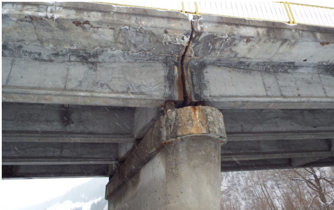
Foto 7. Vedere laterala pila / vedere intrados consola trotuar – infiltratii prin rostul de dilatatie / infiltratii la intradosul consolelor, carbonatari, beton degradat pe capetele grinzilor si in lisele de parapet
