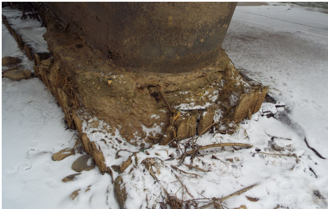
Foto 5. Vedere fundatie pila – beton de slaba calitate in fundatie puternic erodat
