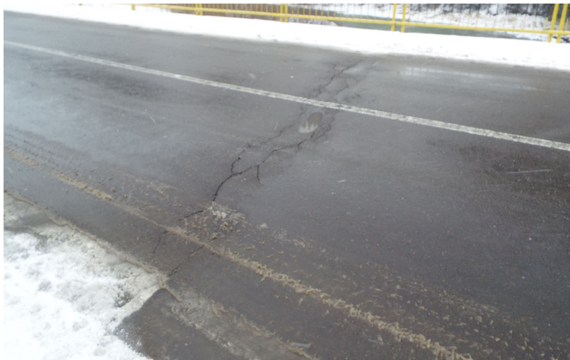
Foto 10. Vedere rost de dilatare – lipsa dispozitiv de acoperire a rostului, asfalt crapat in zona rostului
