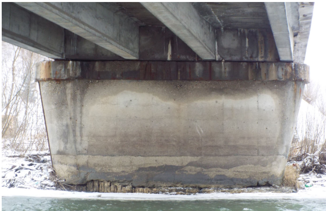
Foto 6. Vedere elevatie pila – rost elevatie-fundatie deteriorat, infiltratii in bancheta si elevatie, infiltratii in antretoazele de capat, pete de rugina
