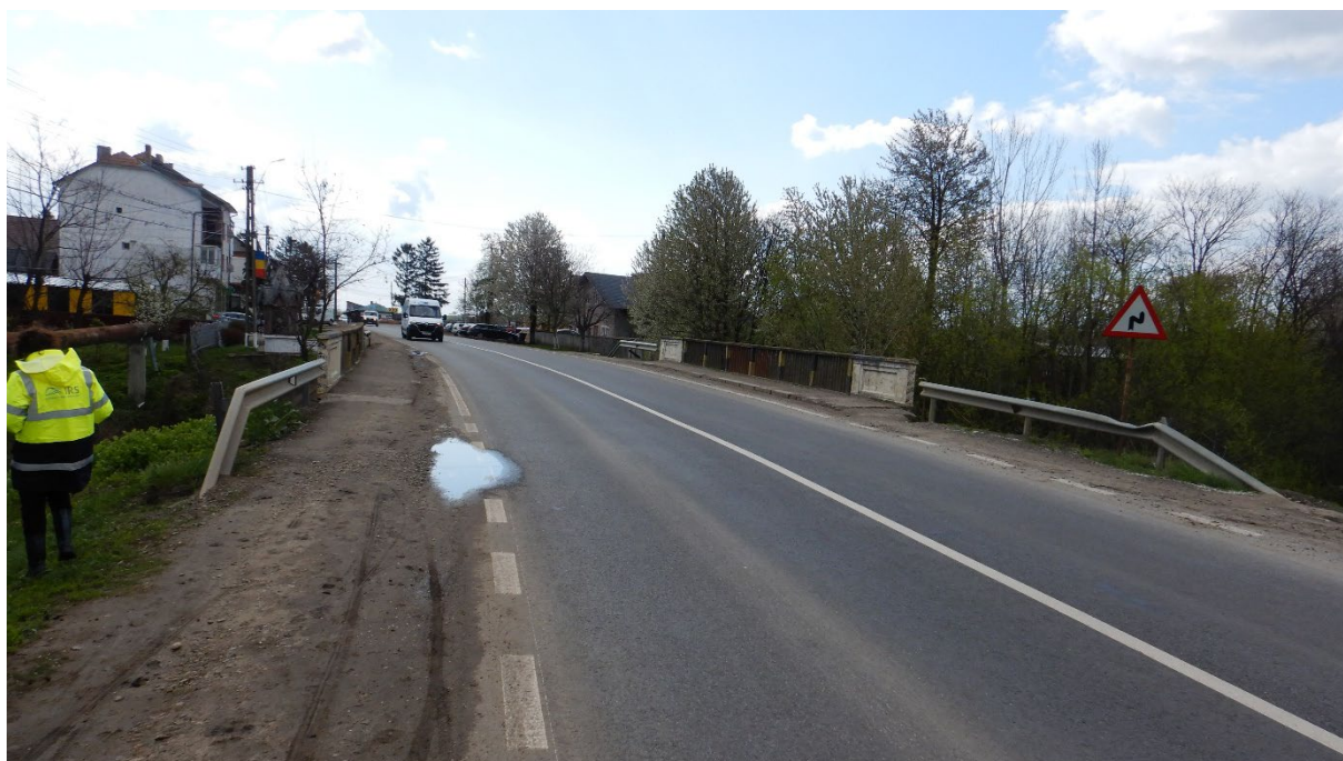
Foto 2. Vedere transversala pod – imbracaminte asfaltica in stare buna, imbracaminte deteriorata pe trotuare, parapet pietonal degradat
