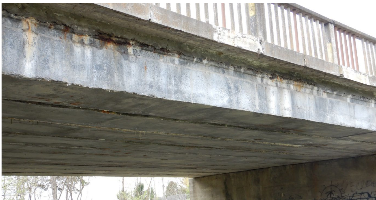
Foto 4. Vedere intrados suprastructura – infiltratii la intrados grinzi, pete de rugina, carbonatari, stalactite, rosturi intre grinzi tratate necorespunzator, infiltratii puternice in grinda marginala prin consola de trotuar
