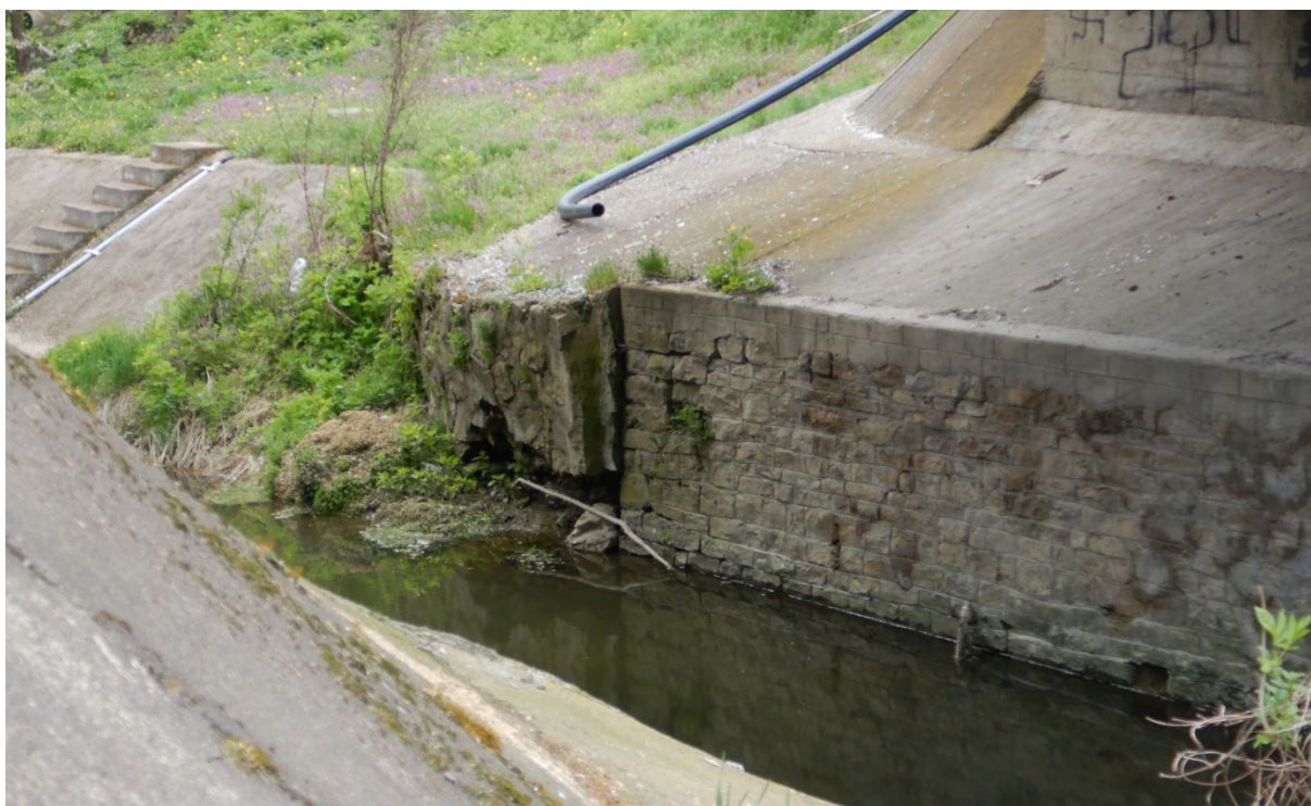
Foto 5. Vedere zid de protectie fundatii (1) - infiltratii in zid, blocuri de piatra dislocate, blocuri desprinse din zidarie, depuneri de aluviuni in albie
