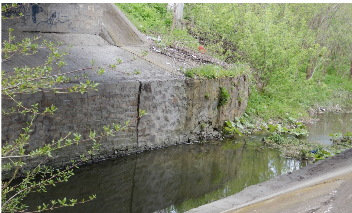
Foto 5. Vedere zid de protectie fundatii (2) - vegetatie si depuneri de resturi vegetale pe pereul sfertului de con, blocuri de piatra dislocate in zidul de protectie al fundatiei sfertului de con, depuneri de aluviuni in albie
