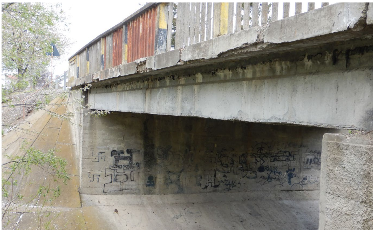
Foto 3. Vedere culee / vedere grinda marginala si lisa – infiltratii in elevatie culee, pete de rugina, pete negre / infiltratii in grinda marginala prin consola de trotuar, beton exfoliat si armatura ruginita la vedere in lisa parapet, parapet pietonal deteriorat
