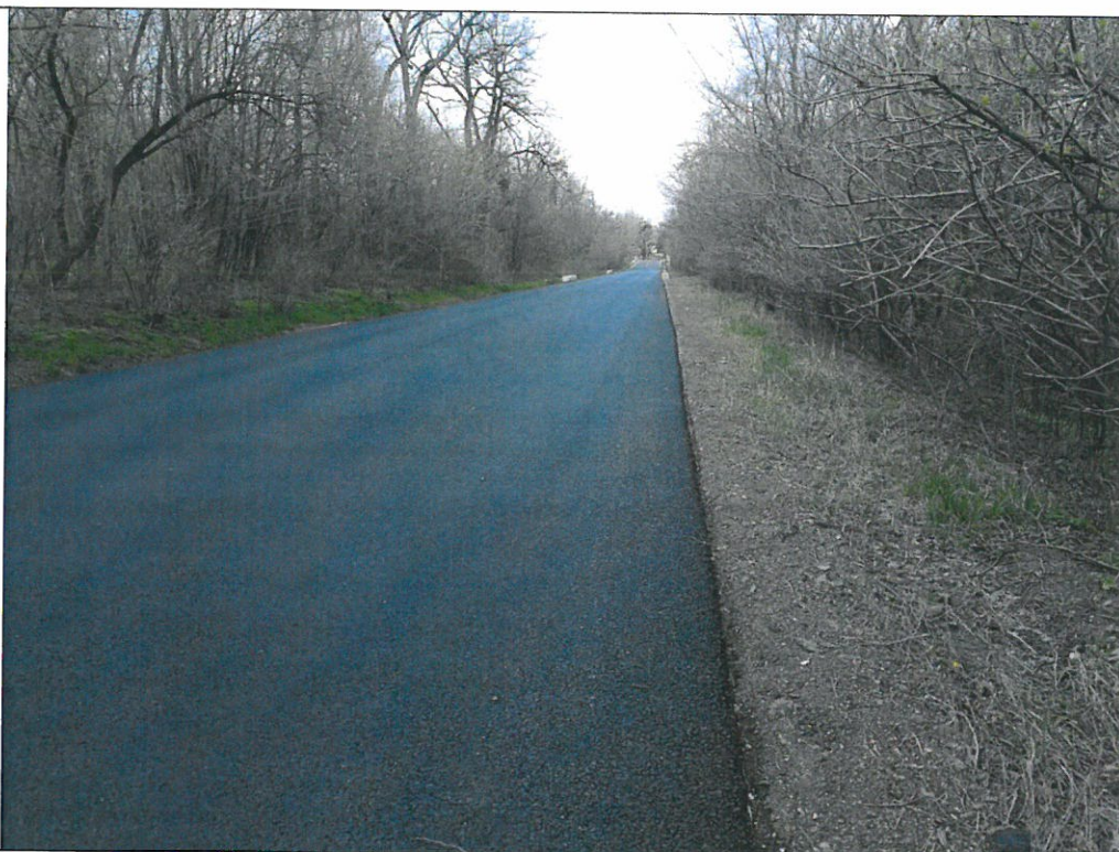
Drumul National DN 28, km 18+270 – taluz de rambleu vegetalizat; lipsa parapetelor de siguranta; tasari la nivelul partii carosabile
