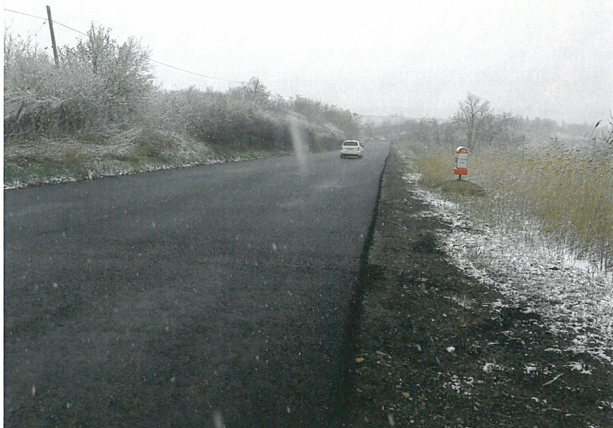
Foto 11: Drumul National DN 28, km 20+000 – denivelari la nivelul partii carosabile; taluz de rambleu cu vegetatie abundenta.
