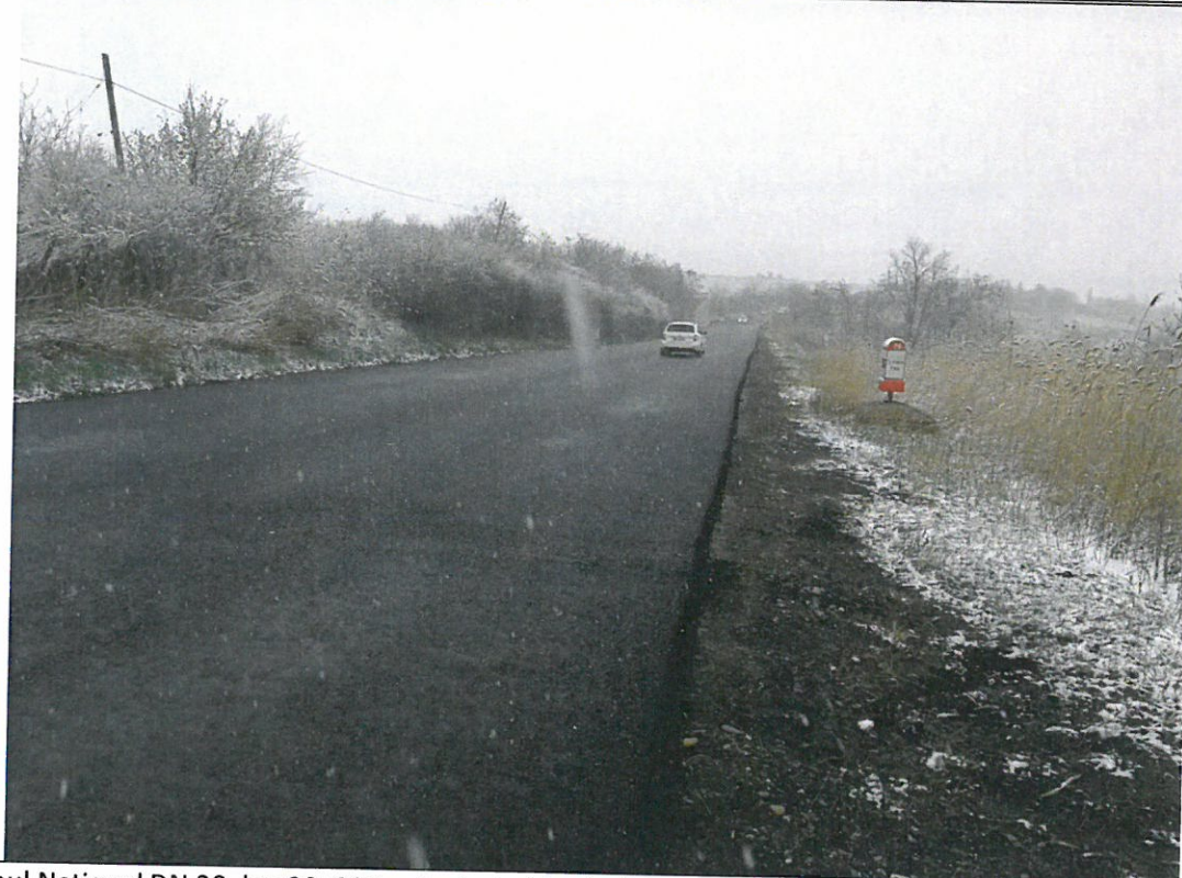
Drumul National DN 28, km 20+000 – denivelari la nivelul partii carosabile; taluz de rambleu cu vegetatie abundenta.
