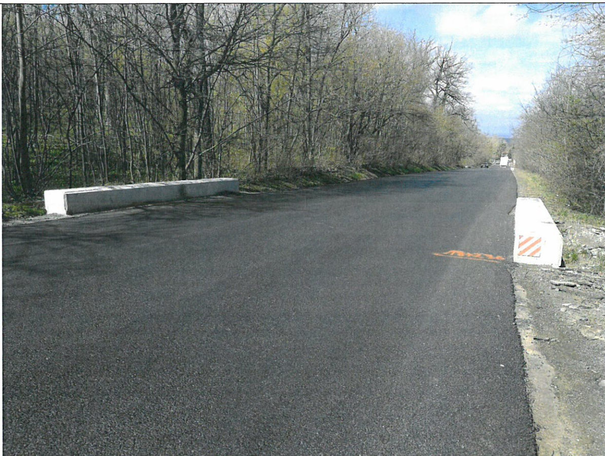
Foto 3: Drumul National DN 28, km 18+240 – podet transversal; lipsa parapete de siguranta la nivelul timpanelor.
