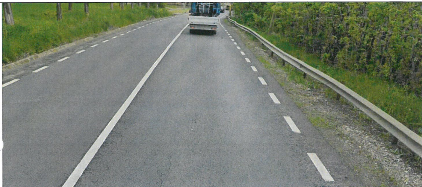
Foto 22: Drumul National DN 28, km 18+600 – tasari accentuate; parapet deplasat de la pozitie
