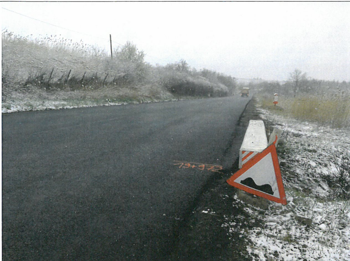
Foto 7: Drumul National DN 28, km 19+973.50 – podet transversal; lipsa parapetleor de siguranta la nivelul timpanelor;
