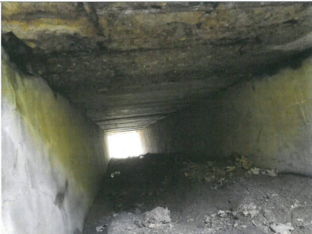
Foto 13: Drumul National DN 28, km 18+347 – podet transversal – sectiune colmatata; dale cu armaturi la vedere.
