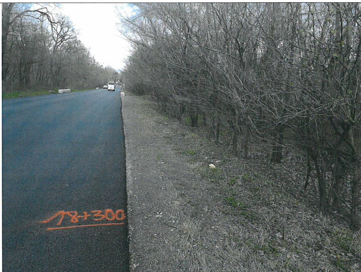
Foto 9: Drumul National DN 28, km 18+300 – taluz de rambleu vegetalizat; lipsa parapetelor de siguranta; tasari la nivelul partii carosabile; usoare forme de alunecare a taluzului.
