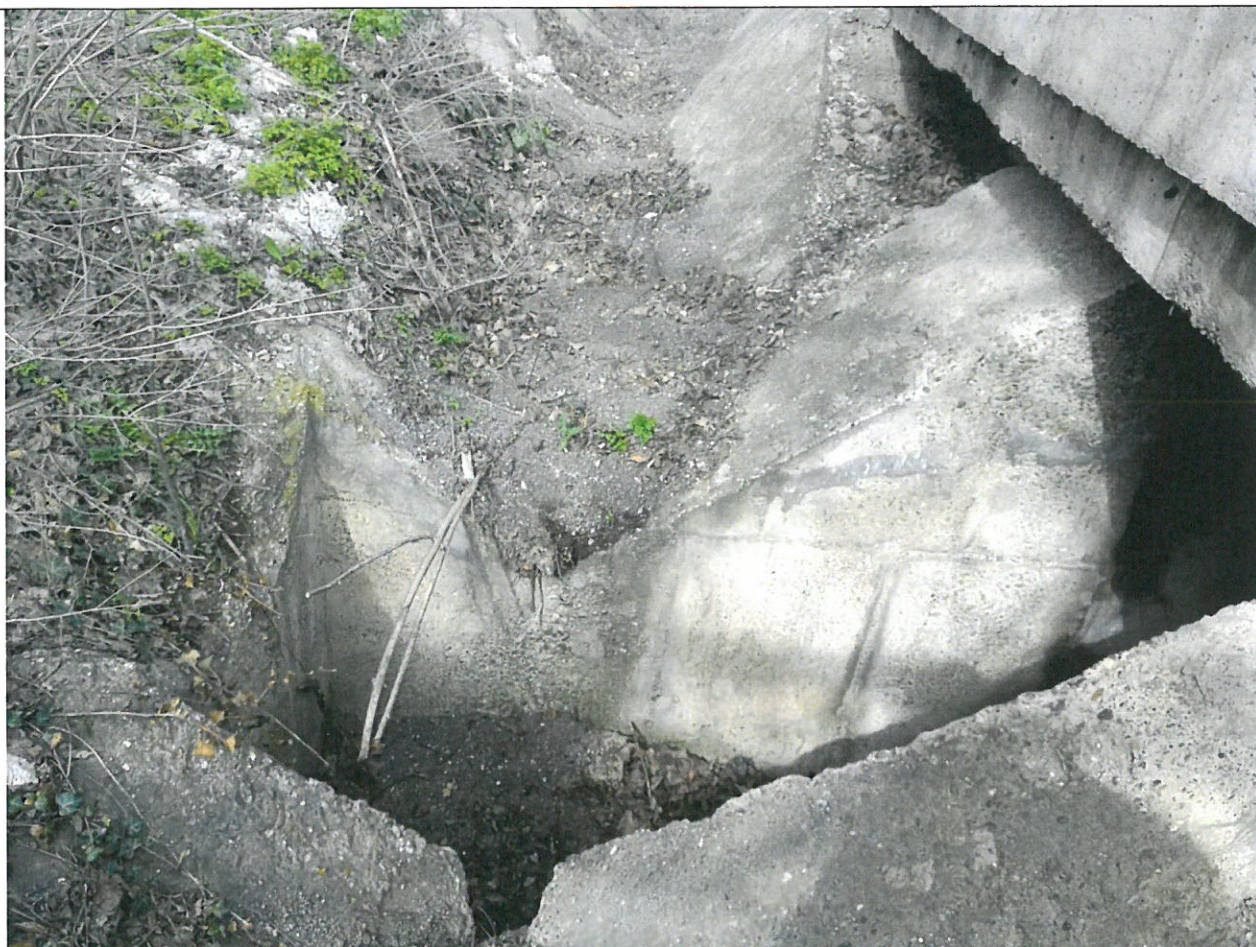
Foto 5: Drumul National DN 28, km 18+240 – podet transversal; camera de cadere amonte partial colmatata cu material granular de pe partea carosabila si resturi vegetale
