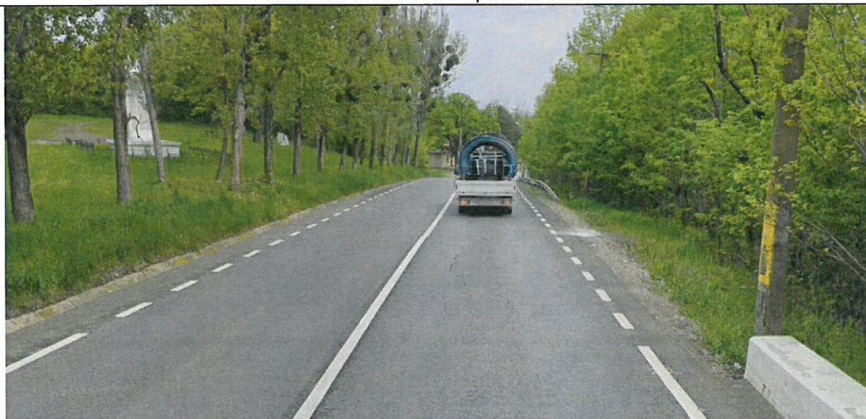
Foto 20: Drumul National DN 28, km 18+575 – treapta de rupere in lungul drumului national cu posibilitate de cedare a terasamentului de rambleu.
