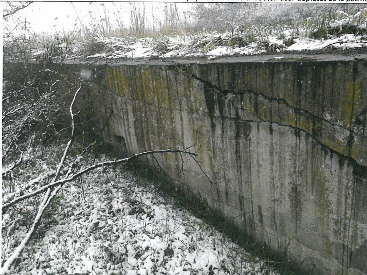
Foto 16: Drumul National DN 28, km 20+085 – zid de sprijin de rambleu – rupturi longitudinale cu posibilitate de cedare;
