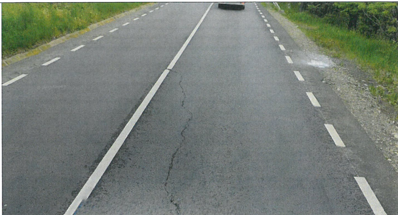
Foto 21: Drumul National DN 28, km 18+575 – treapta de rupere in lungul drumului national cu posibilitate de cedare a terasamentului de rambleu.
