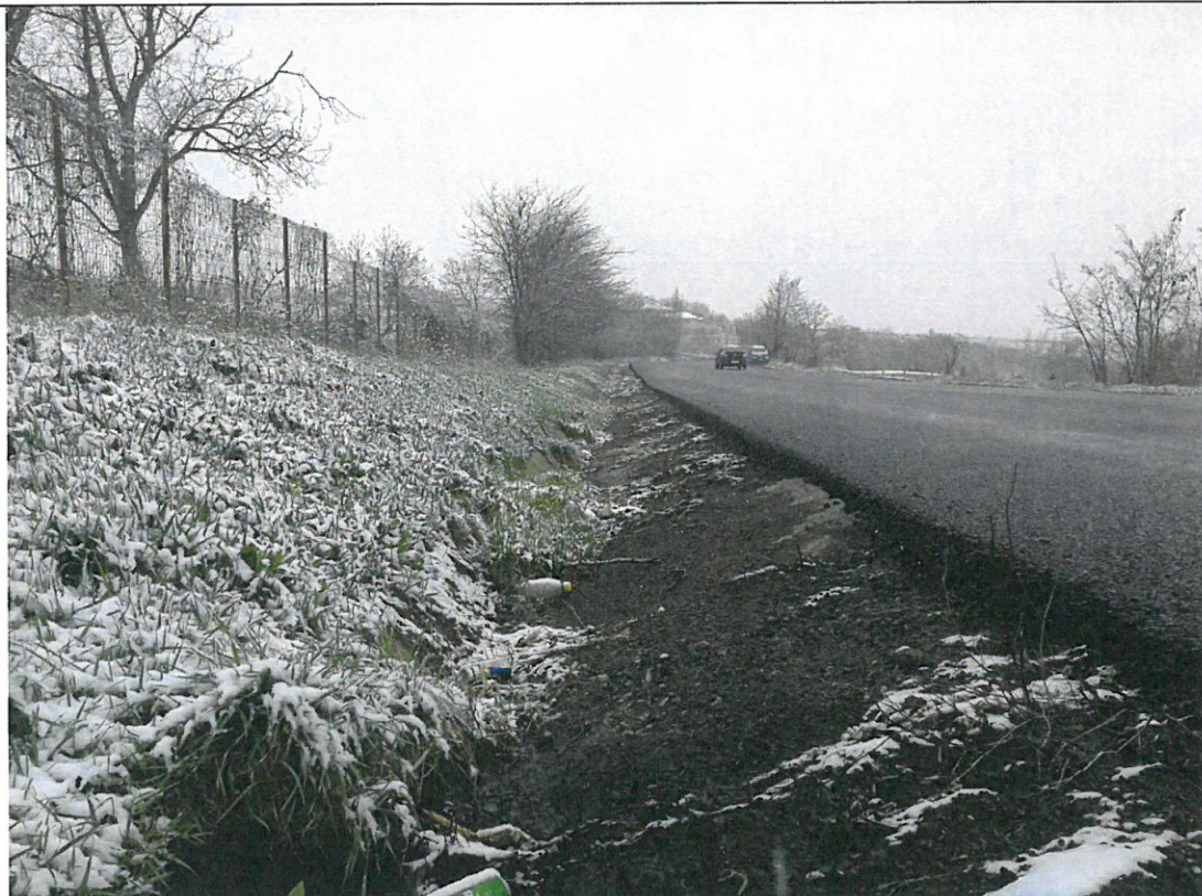
Foto 2: Drumul National DN 28, km 19+700 – sisteme de preluare si evacuare a apelor din beton aflate intr-o stare mediocra de exploatare.
