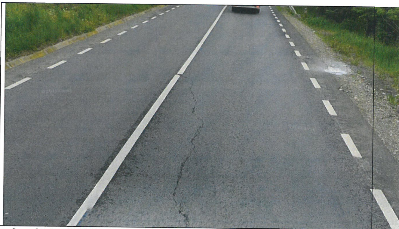
Drumul National DN 28, km 18+575 – treapta de rupere in lungul drumului national cu posibilitate de cedare a terasamentului de rambleu.
