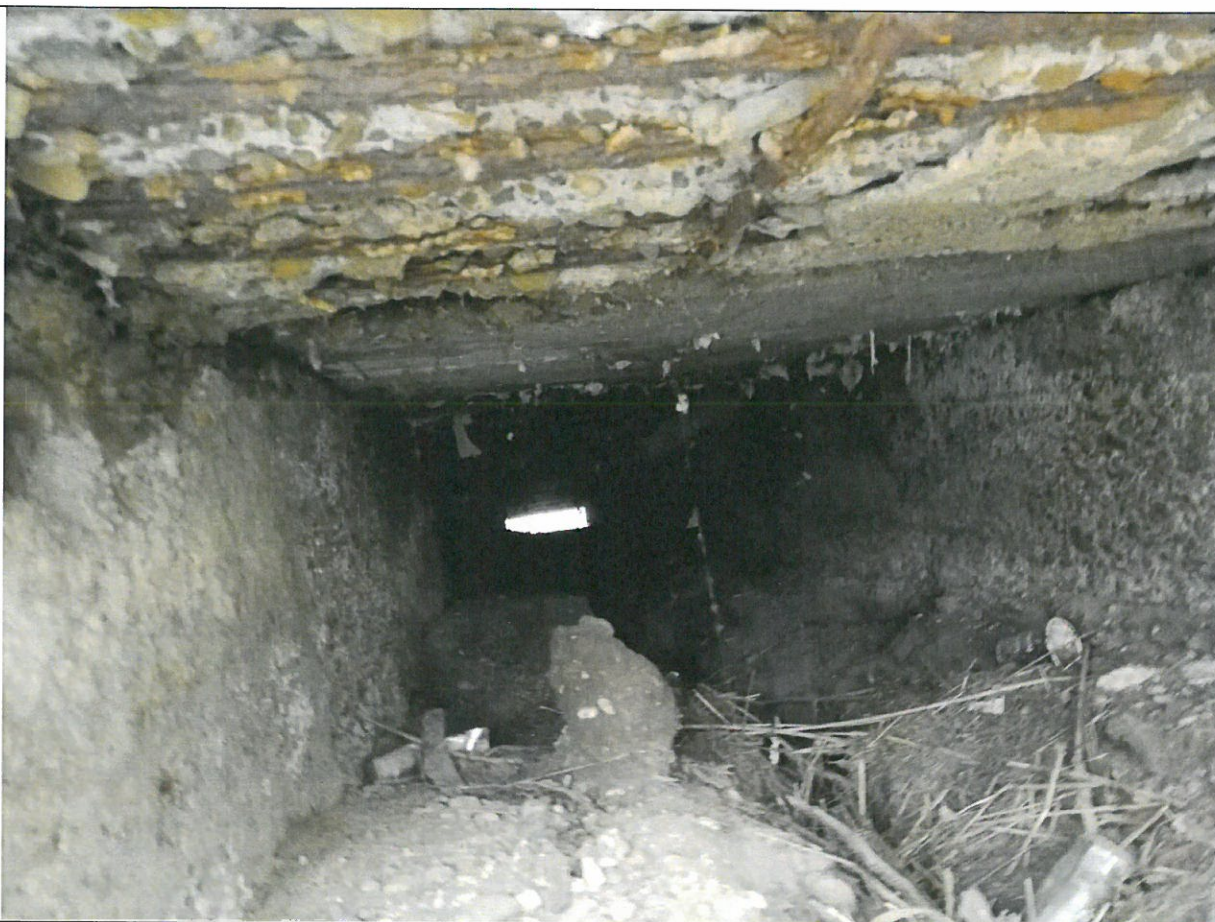
Foto 9: Drumul National DN 28, km 19+973.50 – podet transversal – secțiune centrala colmatata; beton corodat la vedere.
