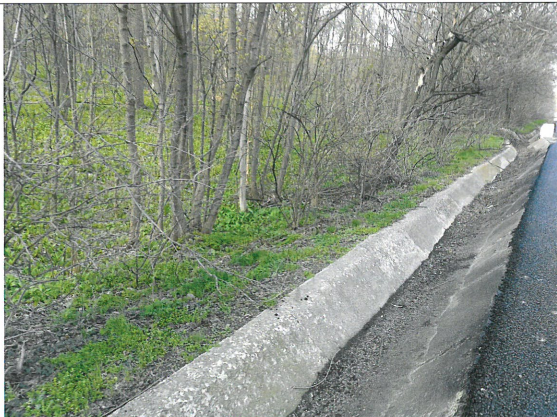
Foto 2: Drumul National DN 28, km 18+200 – sisteme de preluare si evacuare a apelor din beton aflate intr-o stare mediocra de exploatare
