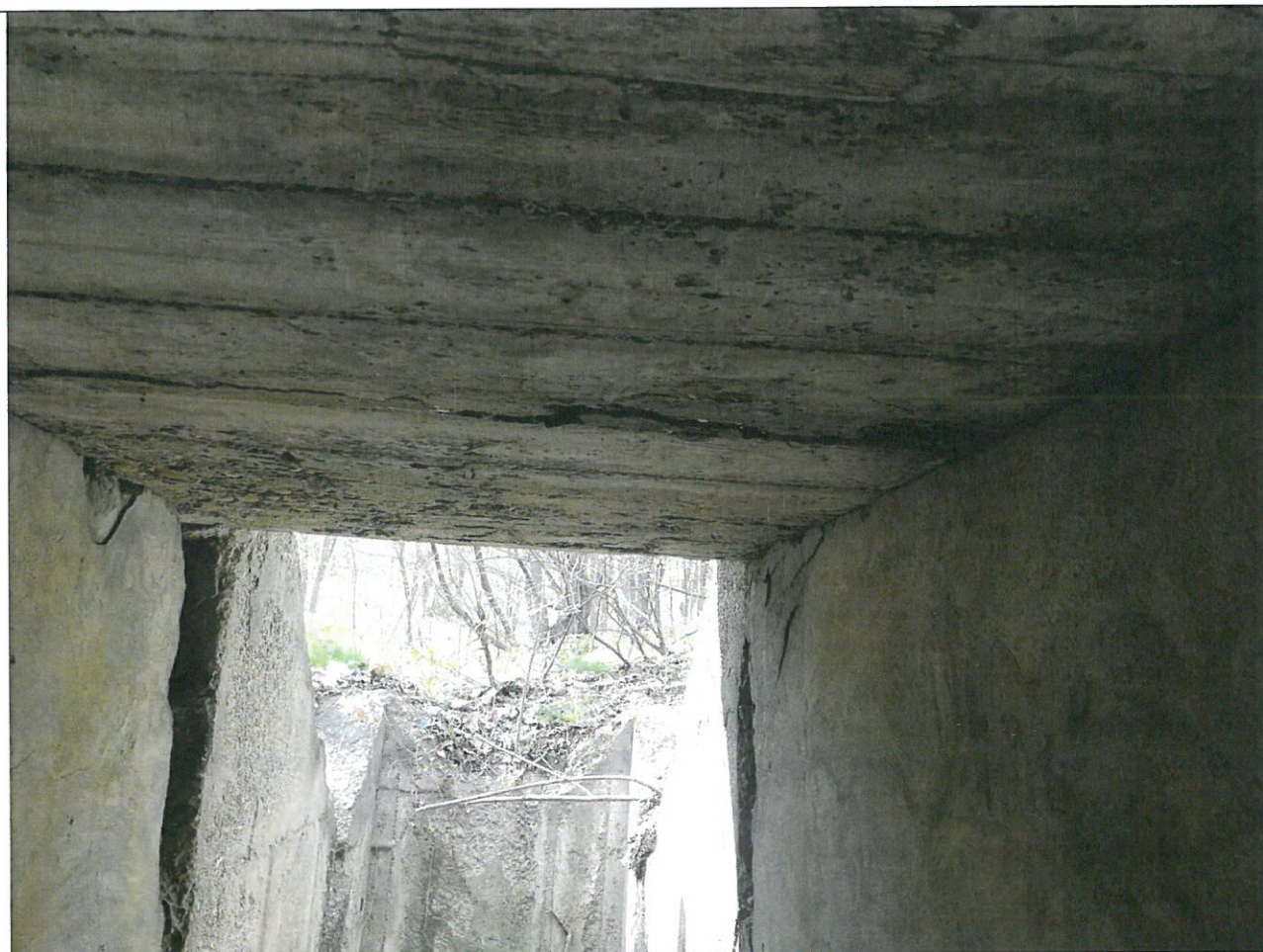
Foto 7: Drumul National DN 28, km 18+240 – podet transversal; desprinderi ale camerei de cadere de corpul podetului; crapaturi la nivelul dalelor.
