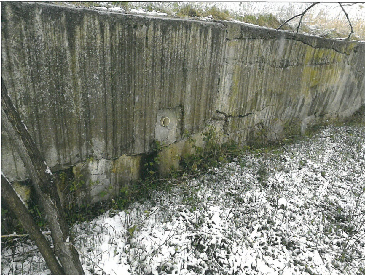
Foto 18: Drumul National DN 28, km 20+090 – zid de sprijin de rambleu – rupturi longitudinale cu posibilitate de cedare;
