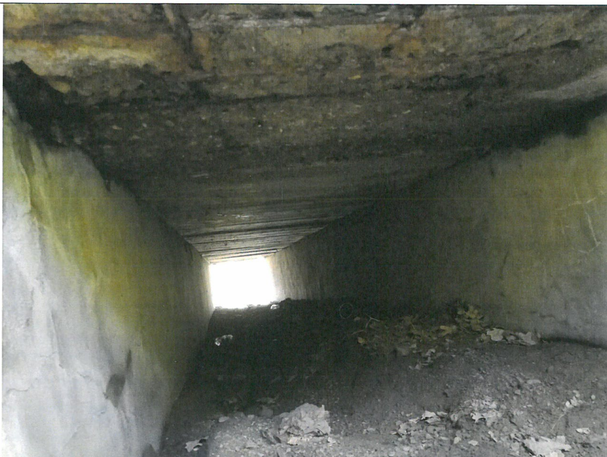
Foto 13: Drumul National DN 28, km 18+347 – podet transversal – secțiune colmatata; dale cu armături la vedere.
