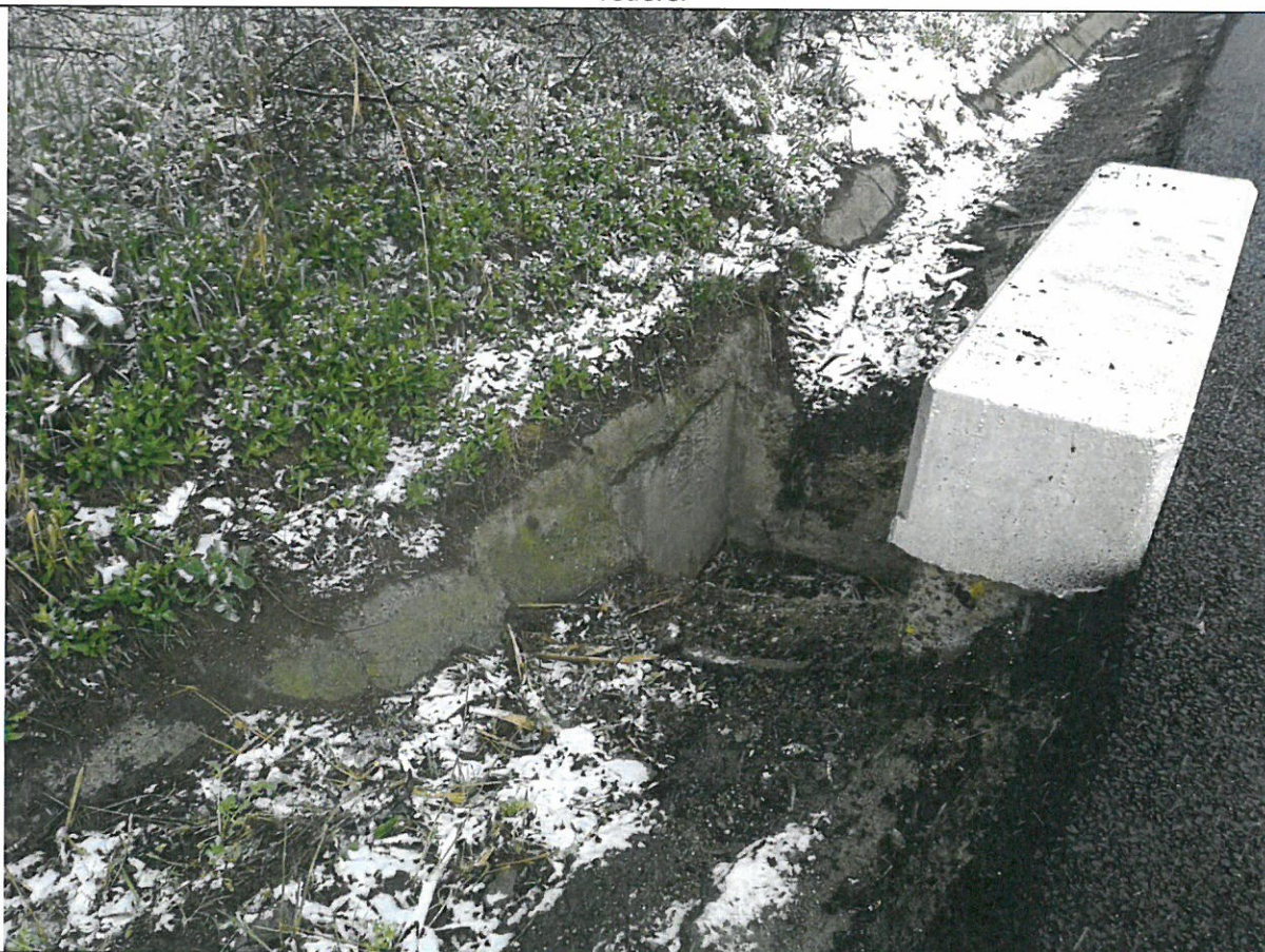
Foto 10: Drumul National DN 28, km 19+973.50 – podet transversal – camera de cadere amonte partial colmatata; santuri colmate cu material granular de la nivelul partii carosabile.
