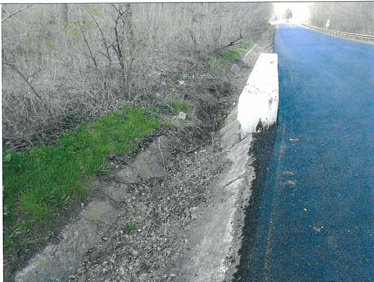
Foto 17: Drumul National DN 28, km 18+416 – podet transversal; sant din beton colmatat cu material granular; camera de cadere colmatata.
