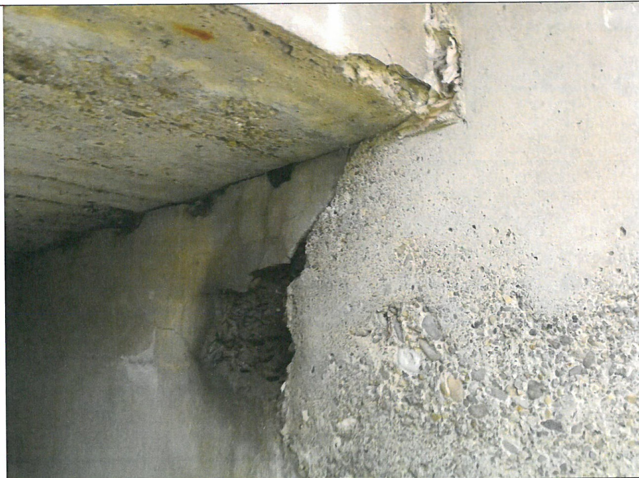
Foto 18: Drumul National DN 28, km 18+416 – podet transversal; desprindere elemente marginale.
