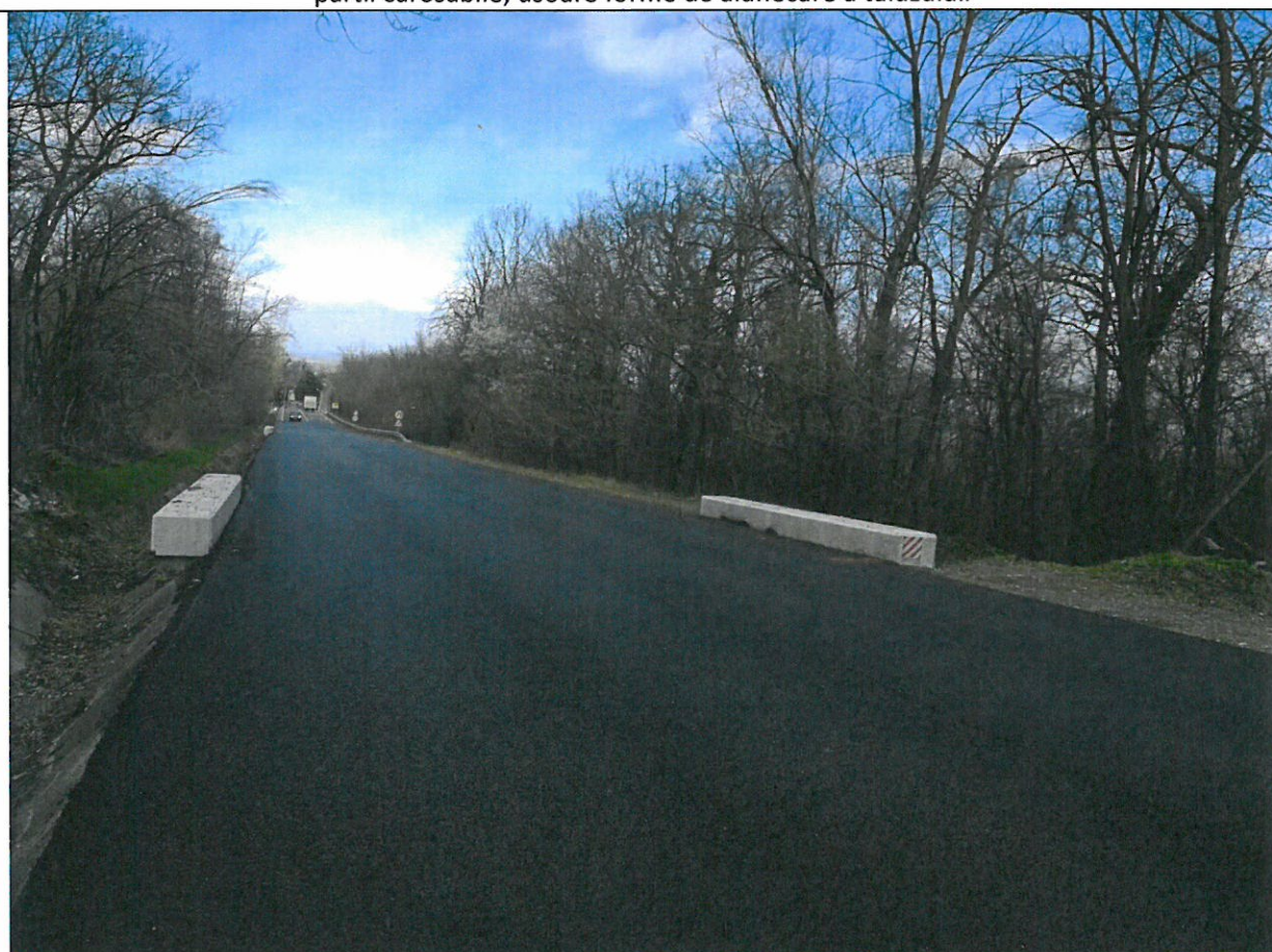
Foto 10: Drumul National DN 28, km 18+347 – podet transversal – lipsa parapetelor de siguranta la nivelul podetului.
