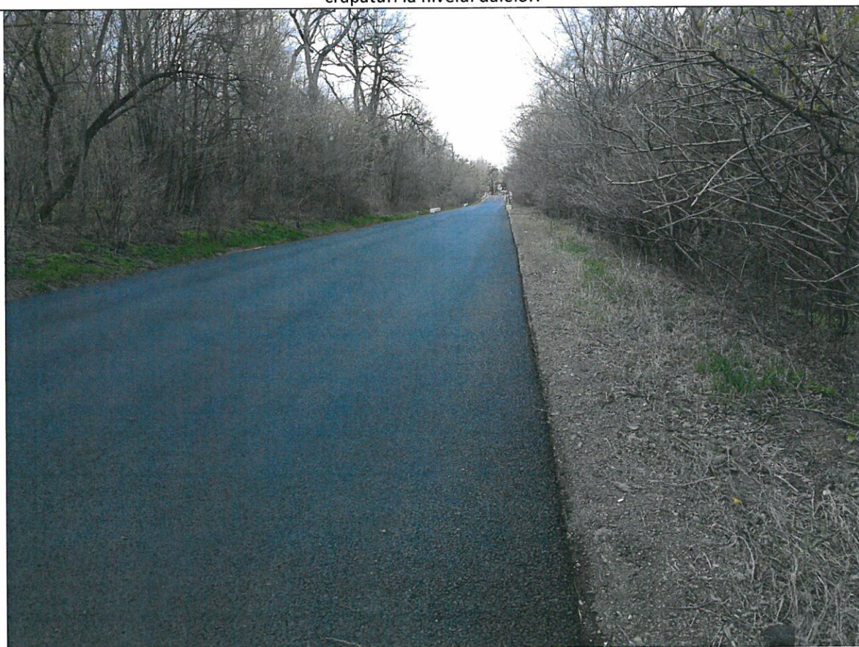
Foto 8: Drumul National DN 28, km 18+270 – taluz de rambleu vegetalizat; lipsa parapetelor de siguranta; tasari la nivelul partii carosabile
