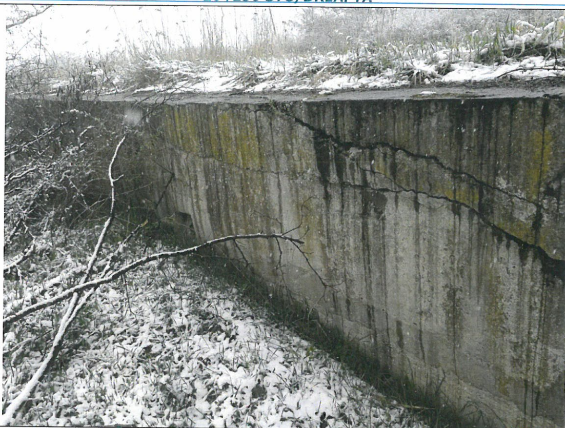
Drumul National DN 28, km 20+085 – zid de sprijin de rambleu – rupturi longitudinale cu posibilitate de cedare;
