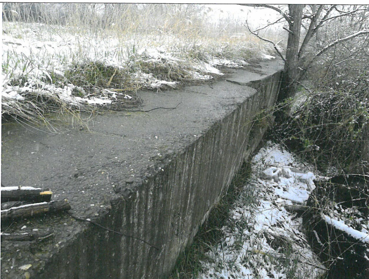
Foto 15: Drumul National DN 28, km 20+075 – zid de sprijin de rambleu din beton usor deplasat de la pozitie.
