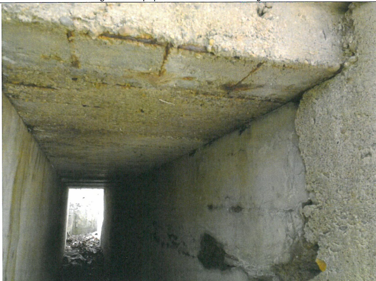
Foto 6: Drumul National DN 28, km 18+240 – podet transversal; sectiune centrala – armaturi la vedere ale dalelor, infiltratii de apa la nivelul culeelor; beton degradat.
