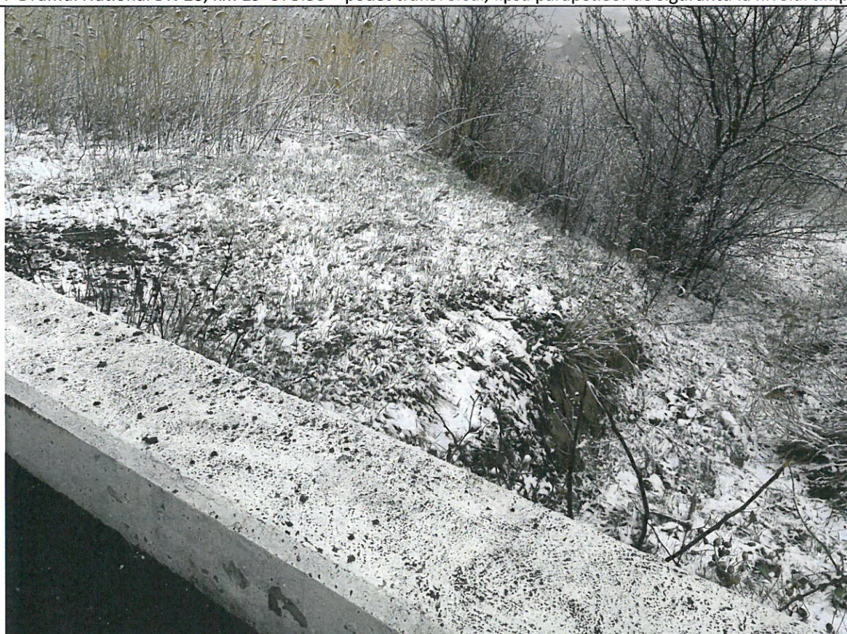
Foto 8: Drumul National DN 28, km 19+973.50 – podet transversal – vedere aval; evacuare inierbata si colmatata care impiedica scurgerea apelor in mod corespunzator
