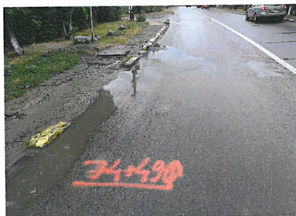
Foto 64: Drumul National DN 24C, km 74+000 – 75+000; 2 benzi de circulatie; imbracaminte asfaltica in stare mediocra/rea.
