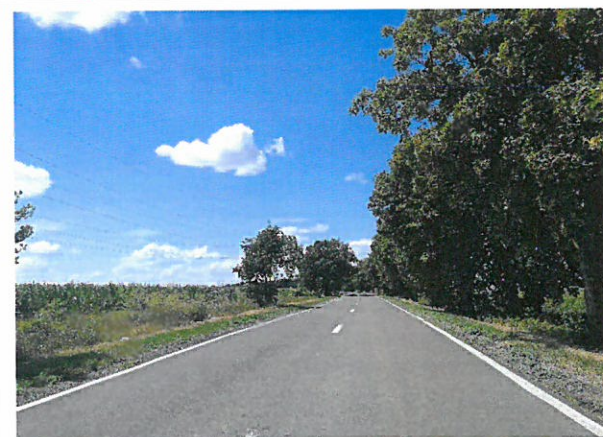
Foto 89: Drumul National DN 24C, km 87+000 – 88+000; 2 benzi de circulatie; imbracaminte asfaltica in stare mediocra.
