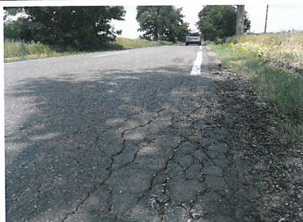
Foto 41: Drumul National DN 24C, km 63+000 – 64+000; 2 benzi de circulatie; imbracaminte asfaltica in stare mediocra.
