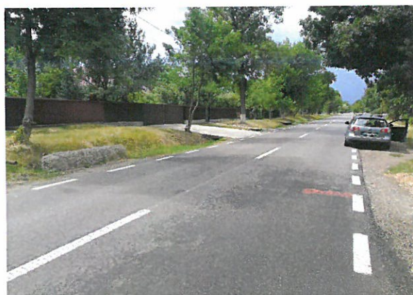
Foto 51: Drumul National DN 24C, km 68+000 – 69+000; 2 benzi de circulatie; imbracaminte asfaltica in stare mediocra.
