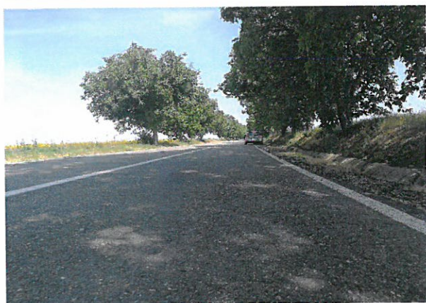
Foto 35: Drumul National DN 24C, km 60+000 – 61+000; 2 benzi de circulatie; imbracaminte asfaltica in stare mediocra.
