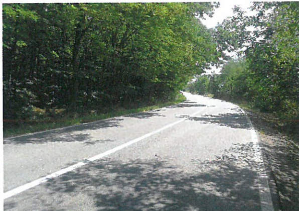
Foto 20: Drumul National DN 24C, km 52+000 – 53+000; 2 benzi de circulatie; imbracaminte asfaltica in stare mediocra.
