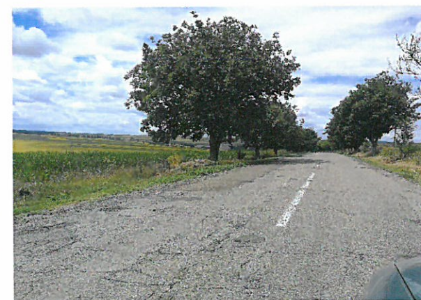
Foto 119: Drumul National DN 24C, km 102+000 – 103+000; 2 benzi de circulatie; imbracaminte asfaltica in stare rea.
