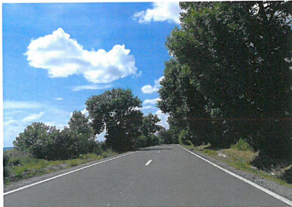
Foto 92: Drumul National DN 24C, km 88+000 – 89+000; 2 benzi de circulatie; imbracaminte asfaltica in stare mediocra.
