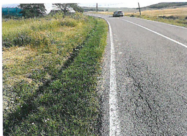
Foto 30: Drumul National DN 24C, km 57+000 – 58+000; 2 benzi de circulatie; imbracaminte asfaltica in stare rea.
