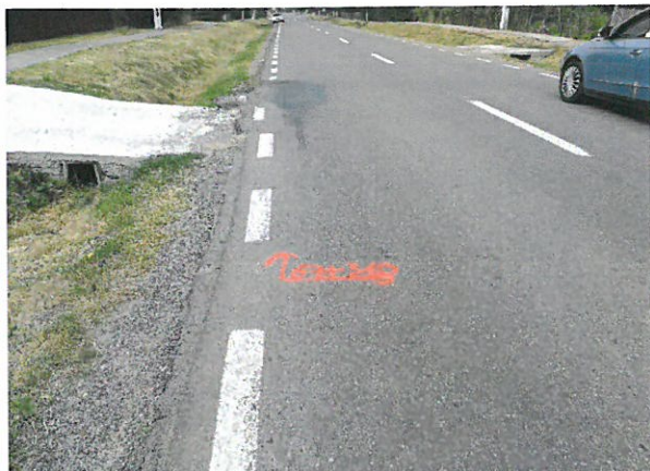
Foto 49: Drumul National DN 24C, km 67+000 – 68+000; 2 benzi de circulatie; imbracaminte asfaltica in stare mediocra.
