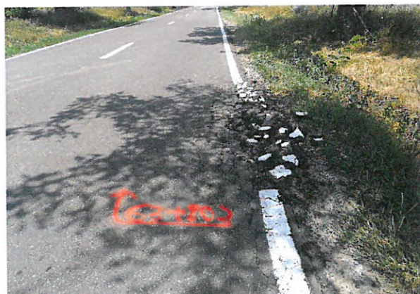
Foto 42: Drumul National DN 24C, km 63+000 – 64+000; 2 benzi de circulatie; imbracaminte asfaltica in stare mediocra.
