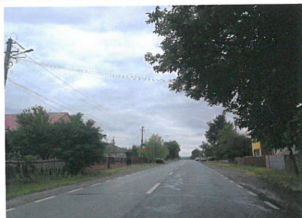
Foto 66: Drumul National DN 24C, km 75+000 – 76+000; 2 benzi de circulatie; imbracaminte asfaltica in stare mediocra.
