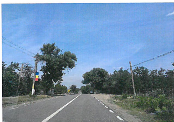
Foto 39: Drumul National DN 24C, km 62+000 – 63+000; 2 benzi de circulatie; imbracaminte asfaltica in stare mediocra.
