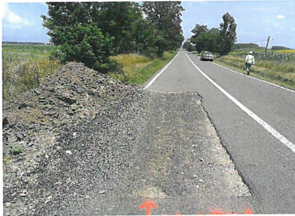
Foto 44: Drumul National DN 24C, km 64+000 – 65+000; 2 benzi de circulatie; imbracaminte asfaltica in stare mediocra.
