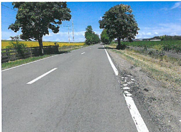
Foto 85: Drumul National DN 24C, km 85+000 – 86+000; 2 benzi de circulatie; imbracaminte asfaltica in stare mediocra.
