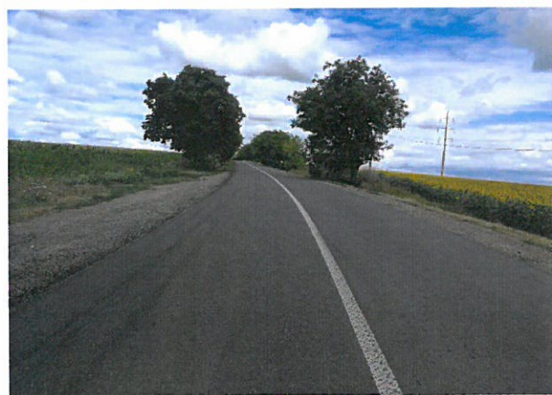
Foto 117: Drumul National DN 24C, km 101+000 – 102+000; 2 benzi de circulatie; imbracaminte asfaltica in stare mediocra.
