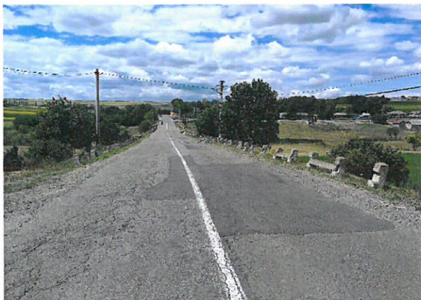
Foto 121: Drumul National DN 24C, km 103+000 – 104+000; 2 benzi de circulatie; imbracaminte asfaltica in stare rea.
