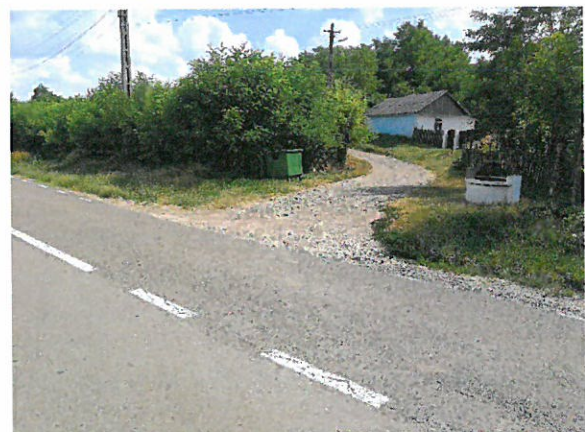
Foto 6: Drumul National DN 24C, km 45+000 – 46+000; 2 benzi de circulatie; imbracaminte asfaltica in stare mediocra.
