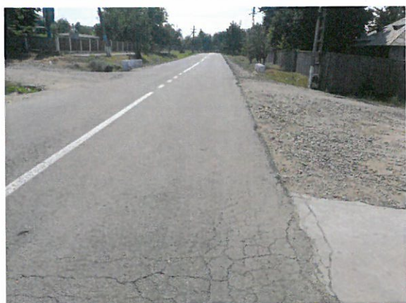
Foto 9: Drumul National DN 24C, km 47+000 – 48+000; 2 benzi de circulatie; imbracaminte asfaltica in stare rea.
