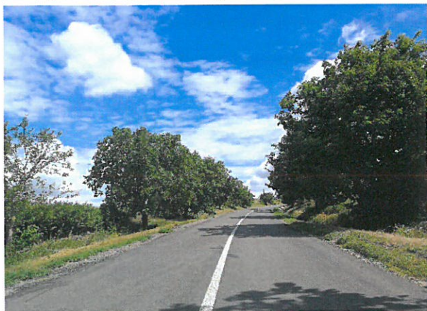
Foto 115: Drumul National DN 24C, km 100+000 – 101+000; 2 benzi de circulatie; imbracaminte asfaltica in stare mediocra.
