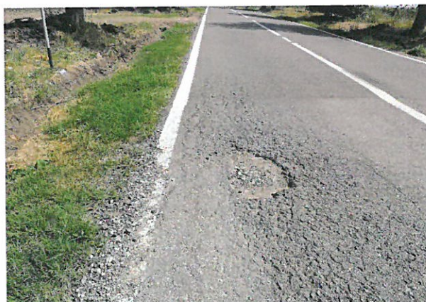
Foto 36: Drumul National DN 24C, km 60+000 – 61+000; 2 benzi de circulatie; imbracaminte asfaltica in stare mediocra.
