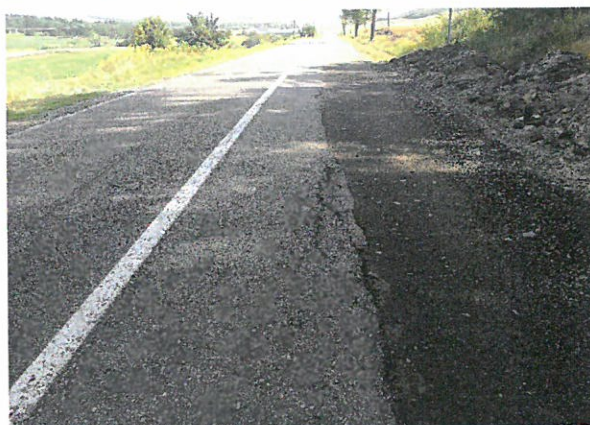
Foto 28: Drumul National DN 24C, km 56+000 – 57+000; 2 benzi de circulatie; imbracaminte asfaltica in stare mediocra.
