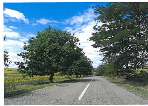
Foto 120: Drumul National DN 24C, km 102+000 – 103+000; 2 benzi de circulatie; imbracaminte asfaltica in stare rea.
