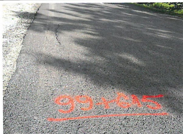
Foto 114: Drumul National DN 24C, km 99+000 – 100+000; 2 benzi de circulatie; imbracaminte asfaltica in stare mediocra .
