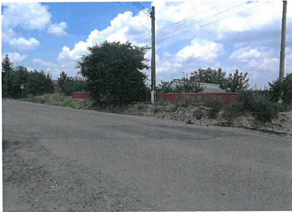
Foto 1: Drumul National DN 24C, km 43+850 – 44+000; 2 benzi de circulatie; imbracaminte asfaltica in stare mediocra.
