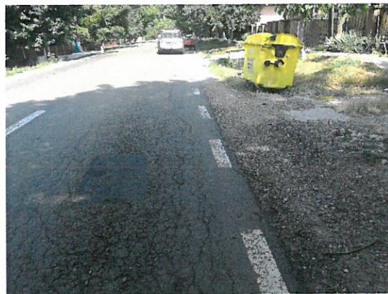
Foto 8: Drumul National DN 24C, km 46+000 – 47+000; 2 benzi de circulatie; imbracaminte asfaltica in stare rea.
