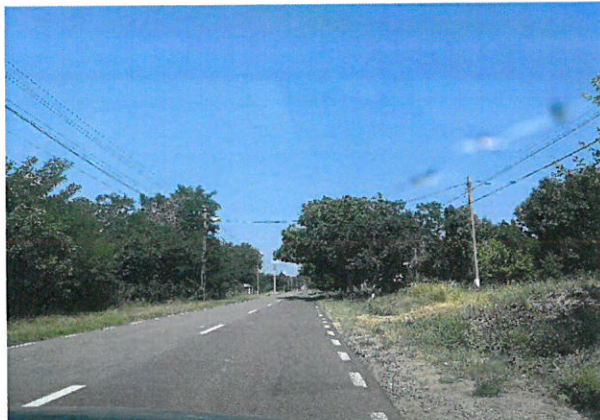
Foto 14: Drumul National DN 24C, km 49+000 – 50+000; 2 benzi de circulatie; imbracaminte asfaltica in stare mediocra.
