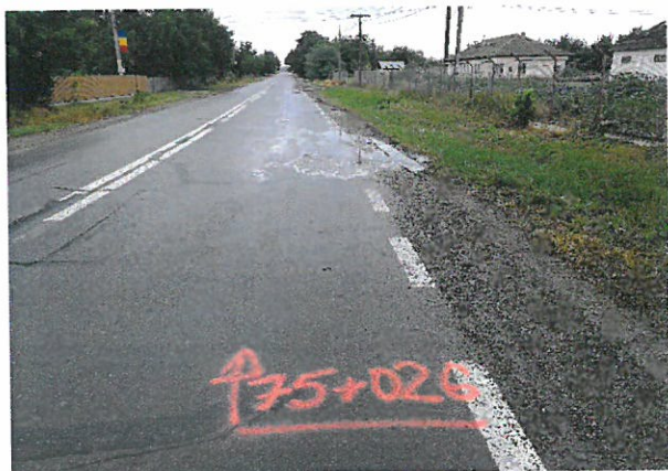
Foto 65: Drumul National DN 24C, km 75+000 – 76+000; 2 benzi de circulatie; imbracaminte asfaltica in stare mediocra.
