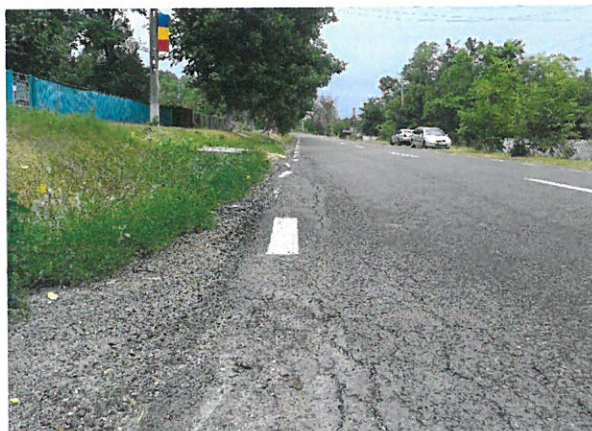
Foto 50: Drumul National DN 24C, km 67+000 – 68+000; 2 benzi de circulatie; imbracaminte asfaltica in stare mediocra.
