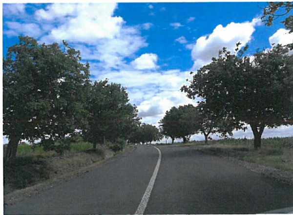
Foto 116: Drumul National DN 24C, km 100+000 – 101+000; 2 benzi de circulatie; imbracaminte asfaltica in stare mediocra.
