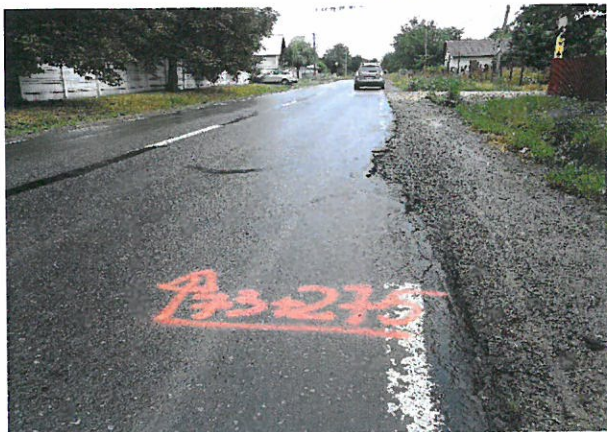
Foto 61: Drumul National DN 24C, km 73+000 – 74+000; 2 benzi de circulatie; imbracaminte asfaltica in stare mediocra.
