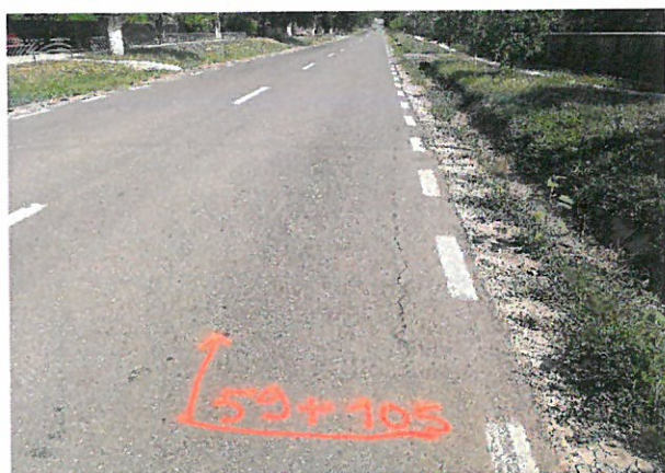
Foto 33: Drumul National DN 24C, km 59+000 – 60+000; 2 benzi de circulatie; imbracaminte asfaltica in stare mediocra.
