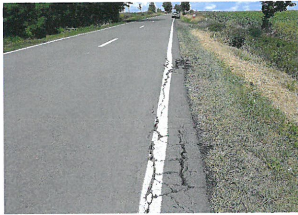
Foto 86: Drumul National DN 24C, km 85+000 – 86+000; 2 benzi de circulatie; imbracaminte asfaltica in stare mediocra.
