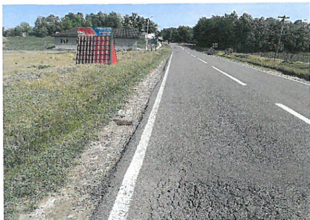
Foto 31: Drumul National DN 24C, km 58+000 – 59+000; 2 benzi de circulatie; imbracaminte asfaltica in stare mediocra.
