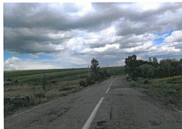
Foto 126: Drumul National DN 24C, km 105+000 – 106+000; 2 benzi de circulatie; imbracaminte asfaltica in stare rea.
