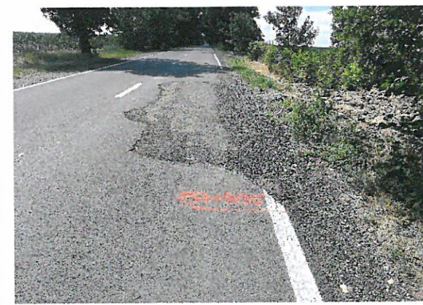
Foto 90: Drumul National DN 24C, km 87+000 – 88+000; 2 benzi de circulatie; imbracaminte asfaltica in stare mediocra.
