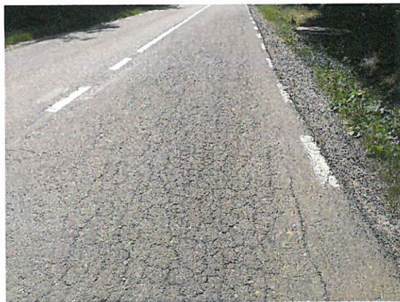
Foto 10: Drumul National DN 24C, km 47+000 – 48+000; 2 benzi de circulatie; imbracaminte asfaltica in stare rea.
