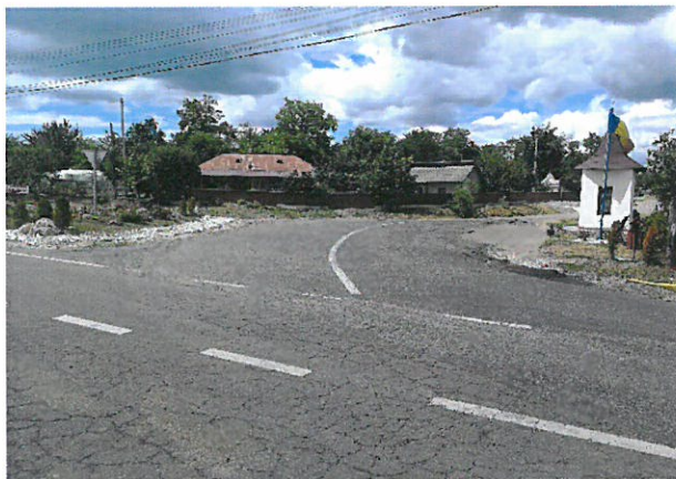
Foto 122: Drumul National DN 24C, km 103+000 – 104+000; 2 benzi de circulatie; imbracaminte asfaltica in stare rea.
