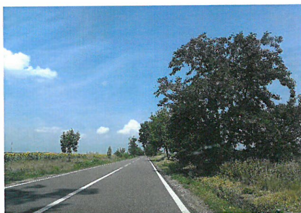
Foto 40: Drumul National DN 24C, km 62+000 – 63+000; 2 benzi de circulatie; imbracaminte asfaltica in stare mediocra.
