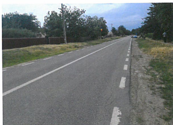
Foto 52: Drumul National DN 24C, km 68+000 – 69+000; 2 benzi de circulatie; imbracaminte asfaltica in stare mediocra.
