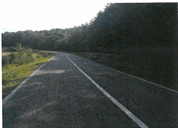
Foto 27: Drumul National DN 24C, km 56+000 – 57+000; 2 benzi de circulatie; imbracaminte asfaltica in stare mediocra.
