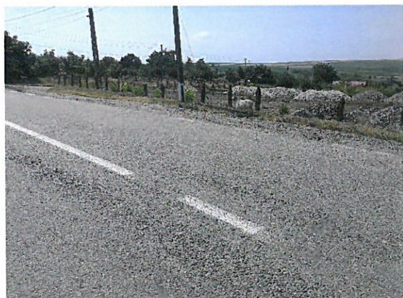
Foto 11: Drumul National DN 24C, km 48+000 – 49+000; 2 benzi de circulatie; imbracaminte asfaltica in stare mediocra.
