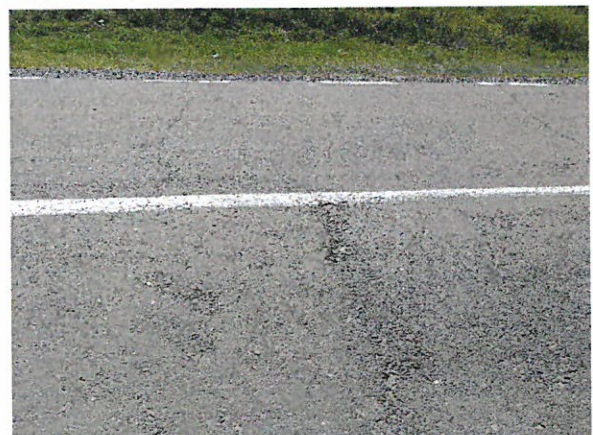
Foto 4: Drumul National DN 24C, km 44+000 – 45+000; 2 benzi de circulatie; imbracaminte asfaltica in stare mediocra.
