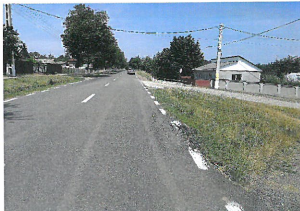
Foto 38: Drumul National DN 24C, km 61+000 – 62+000; 2 benzi de circulatie; imbracaminte asfaltica in stare mediocra.
