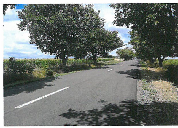
Foto 118: Drumul National DN 24C, km 101+000 – 102+000; 2 benzi de circulatie; imbracaminte asfaltica in stare mediocra.
