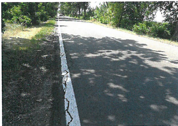
Foto 91: Drumul National DN 24C, km 88+000 – 89+000; 2 benzi de circulatie; imbracaminte asfaltica in stare mediocra.
