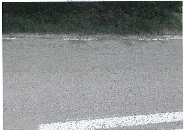
Foto 2: Drumul National DN 24C, km 43+850 – 44+000; 2 benzi de circulatie; imbracaminte asfaltica in stare mediocra.
