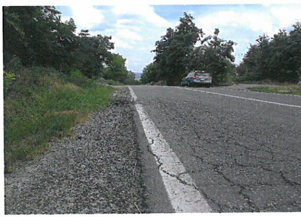
Foto 46: Drumul National DN 24C, km 65+000 – 66+000; 2 benzi de circulatie; imbracaminte asfaltica in stare mediocra.
