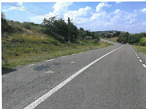
Foto 3: Drumul National DN 24C, km 44+000 – 45+000; 2 benzi de circulatie; imbracaminte asfaltica in stare mediocra.
