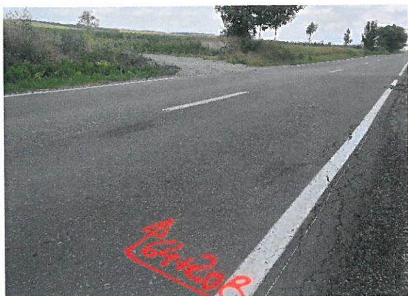
Foto 43: Drumul National DN 24C, km 64+000 – 65+000; 2 benzi de circulatie; imbracaminte asfaltica in stare mediocra.
