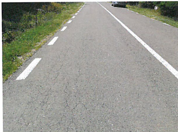
Foto 5: Drumul National DN 24C, km 45+000 – 46+000; 2 benzi de circulatie; imbracaminte asfaltica in stare mediocra.
