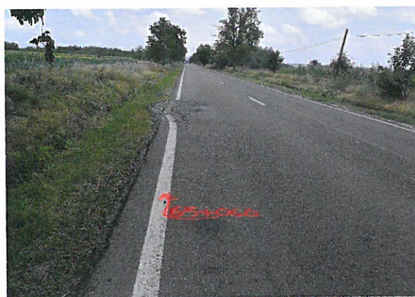
Foto 45: Drumul National DN 24C, km 65+000 – 66+000; 2 benzi de circulatie; imbracaminte asfaltica in stare mediocra.
