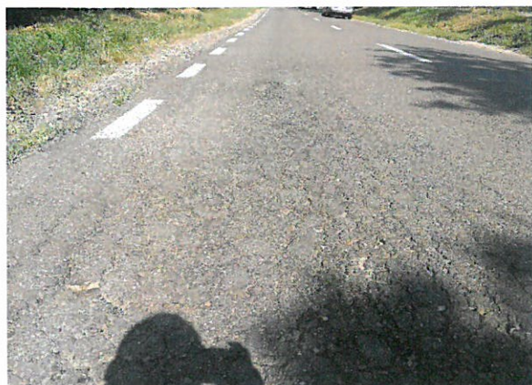
Foto 7: Drumul National DN 24C, km 46+000 – 47+000; 2 benzi de circulatie; imbracaminte asfaltica in stare rea.
