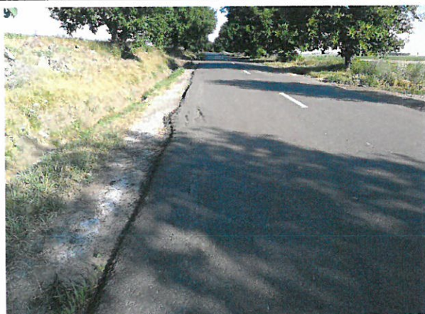
Foto 113: Drumul National DN 24C, km 99+000 – 100+000; 2 benzi de circulatie; imbracaminte asfaltica in stare mediocra.
