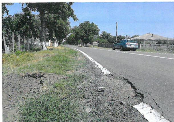
Foto 37 Drumul National DN 24C, km 61+000 – 62+000; 2 benzi de circulatie; imbracaminte asfaltica in stare mediocra.
