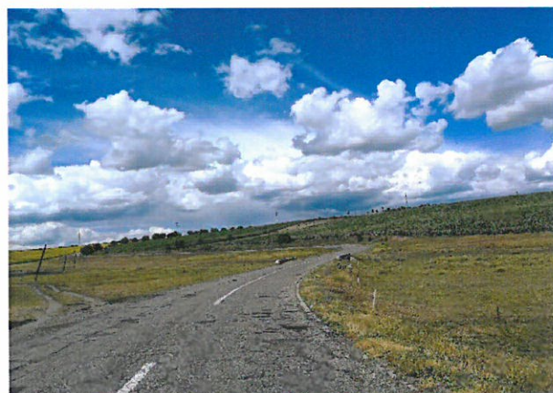
Foto 123: Drumul National DN 24C, km 104+000 – 105+000; 2 benzi de circulatie; imbracaminte asfaltica in stare rea.
