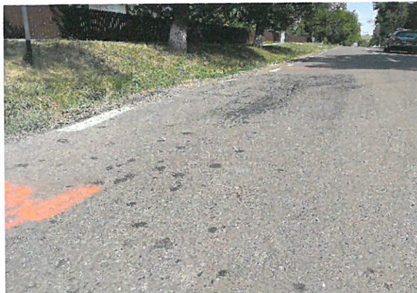
Foto 32: Drumul National DN 24C, km 58+000 – 59+000; 2 benzi de circulatie; imbracaminte asfaltica in stare mediocra.
