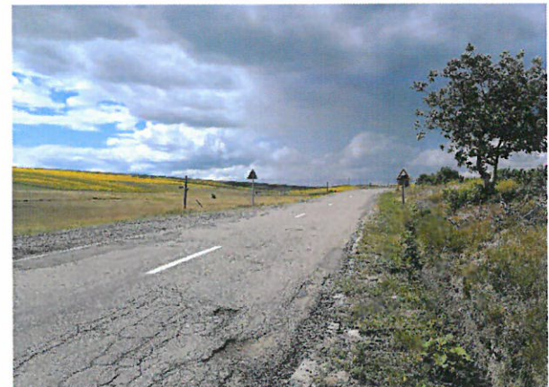
Foto 124: Drumul National DN 24C, km 104+000 – 105+000; 2 benzi de circulatie; imbracaminte asfaltica in stare rea.
