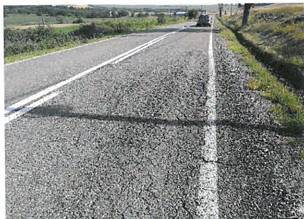
Foto 29: Drumul National DN 24C, km 57+000 – 58+000; 2 benzi de circulatie; imbracaminte asfaltica in stare rea.
