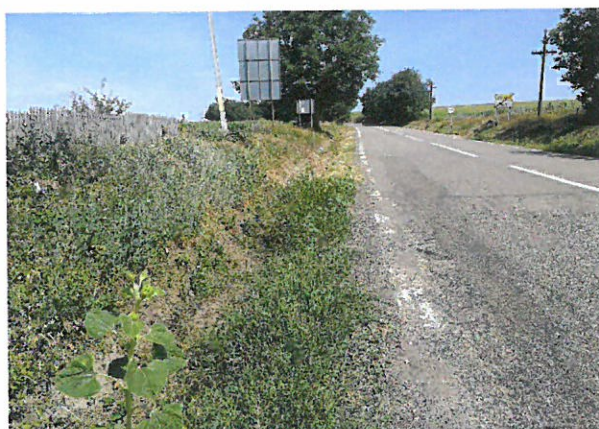
Foto 34: Drumul National DN 24C, km 59+000 – 60+000; 2 benzi de circulatie; imbracaminte asfaltica in stare mediocra.
