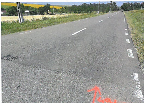
Foto 13: Drumul National DN 24C, km 49+000 – 50+000; 2 benzi de circulatie; imbracaminte asfaltica in stare mediocra.
