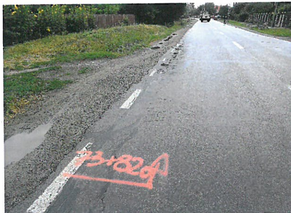
Foto 62: Drumul National DN 24C, km 73+000 – 74+000; 2 benzi de circulatie; imbracaminte asfaltica in stare mediocra.
