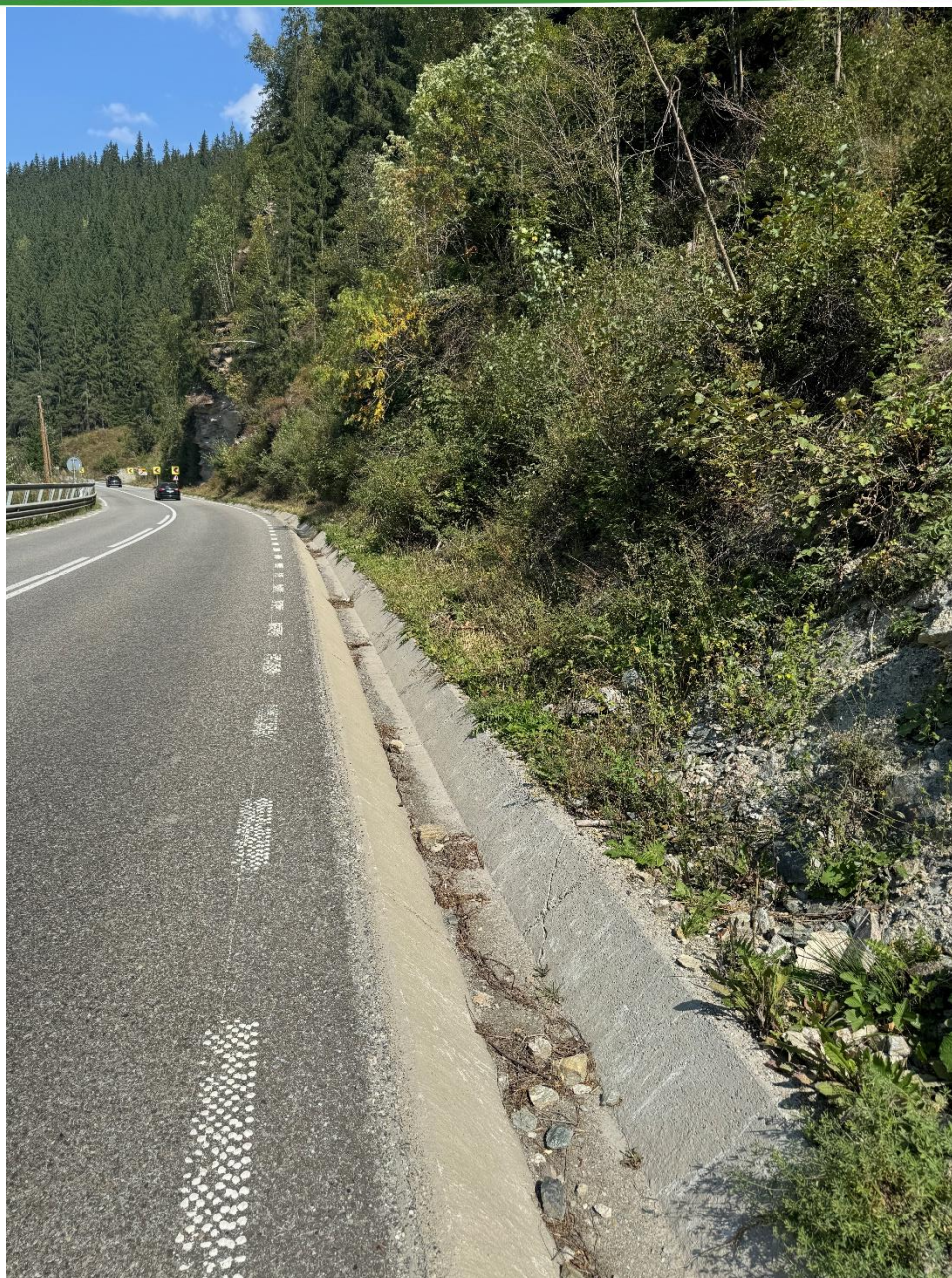
Fig. 5. Situația existentă la momentul expertizării tehnice
