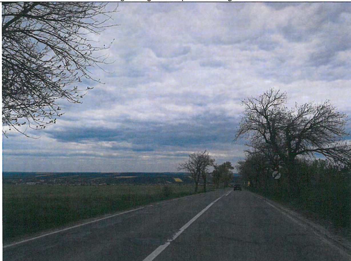
Foto 114: Drumul National DN 29, km 73+000 - 74+000 – Multiple fisuri la nivelul partii carosabile colmatate cu mastic bituminos. Fagase longitudinale pe zonele marginale. Usoare valuriri.
