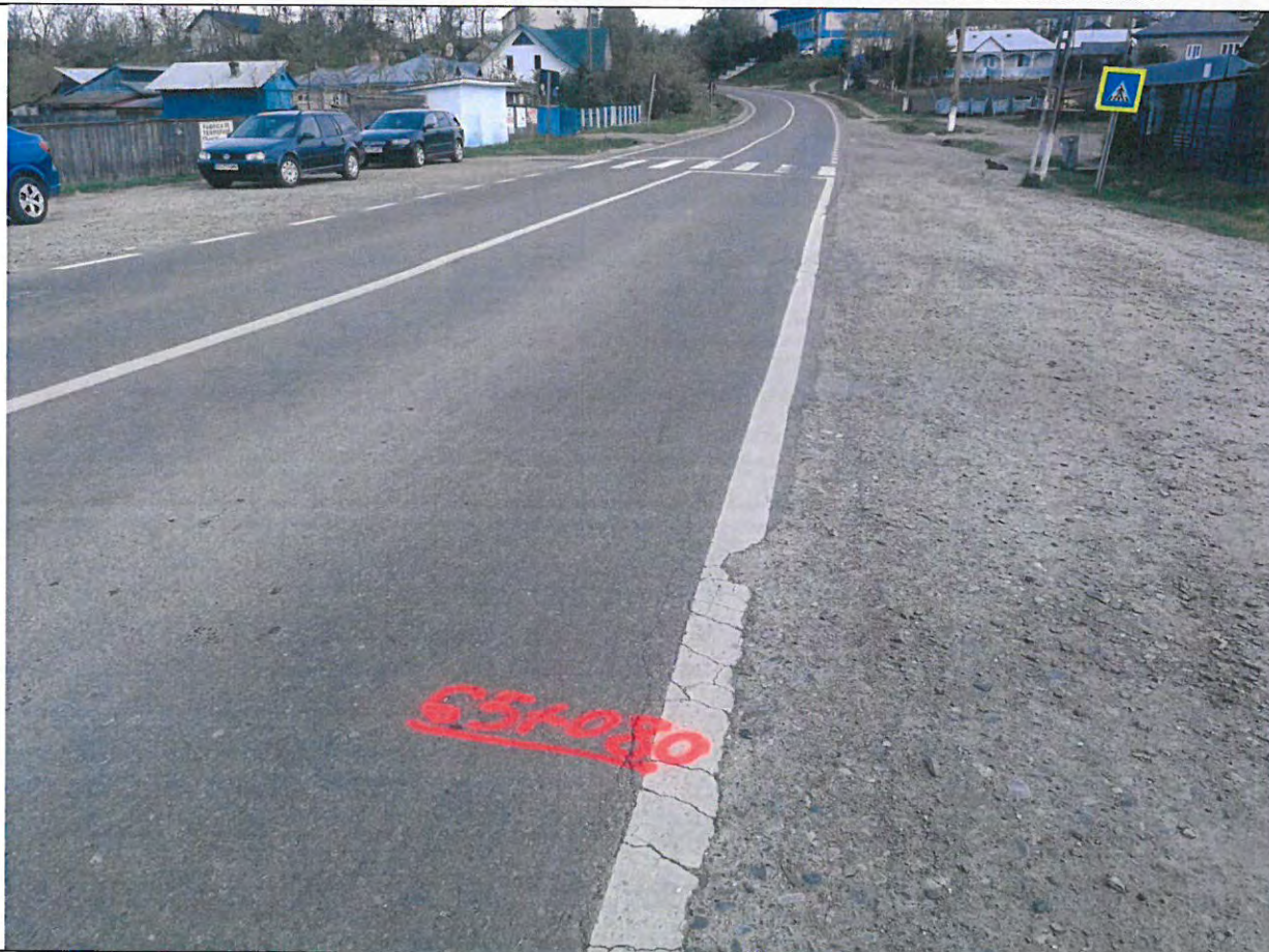
Foto 86: Drumul National DN 29, km 65+000 - 66+000 – Rupturi ale mixturii asfaltice pe zonele marginale. Fagase longitudinale.
