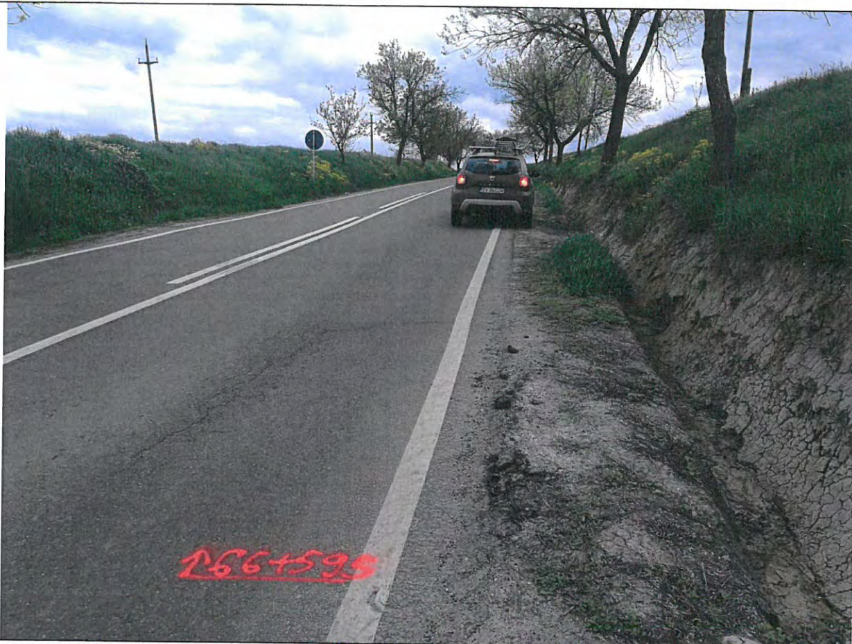
Foto 91: Drumul National DN 29, km 66+000 - 67+000 – Acostamente din pamant La nivel carosabile sunt prezente fagase longitudinale si fisuri.
