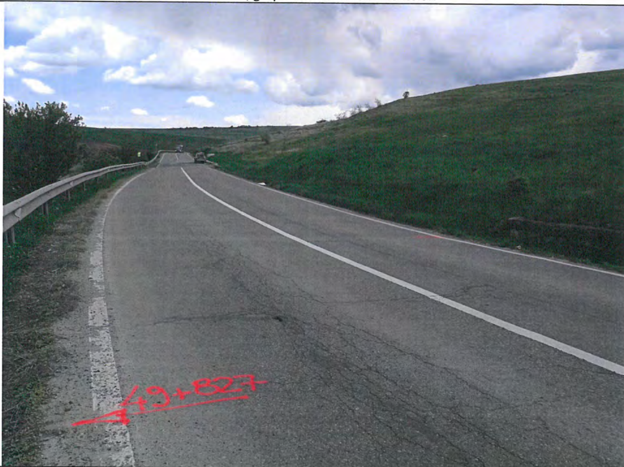
Foto 24: Drumul National DN 29, km 49+000 - 50+000– Faientari pe suprafete extinse.
