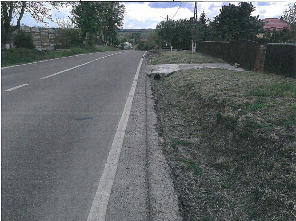
Foto 88: Drumul National DN 29, km 65+000 - 66+000 – Subpalari in zona acostamentelor cu posibilitate de avansare la nivelul partii carosabile.
