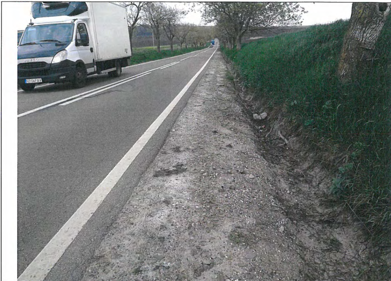
Foto 103: Drumul National DN 29B, km 31+000 -31+500 – Acostament din pamant degradat. Fagase si valuriri de la nvelul partii carosabile.
