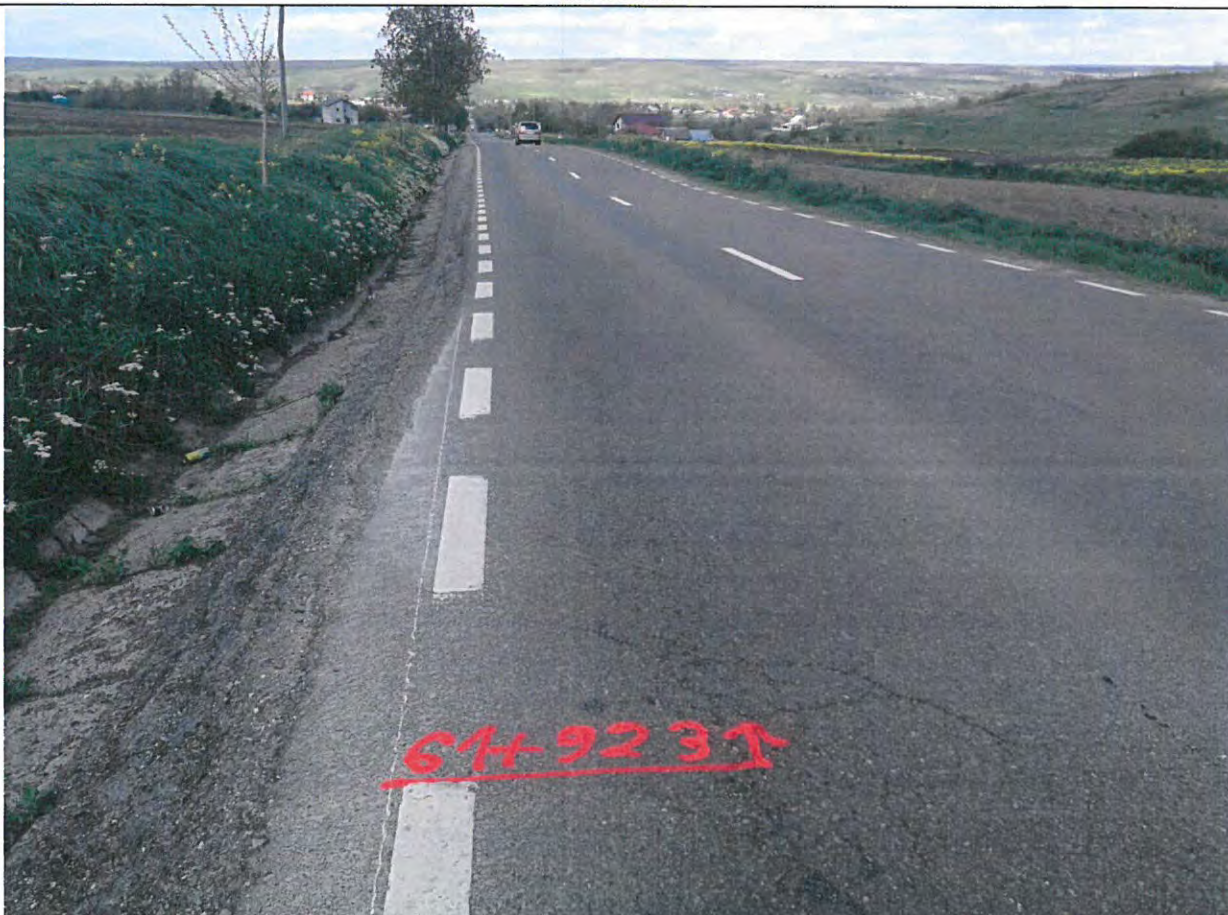
Foto 72: Drumul National DN 29, km 61+000 - 62+000 – Fagase longitudinale. Usoare denivelari la nivelul partii carosabile. Acostamente cu latimi variabile.
