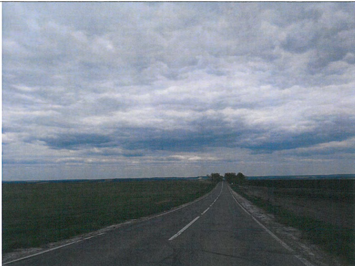
Foto 113: Drumul National DN 29, km 73+000 - 74+000 – Multiple fisuri la nivelul partii carosabile colmatate cu mastic bituminos. Fagase longitudinale pe zonele marginale. Usoare valuriri.
