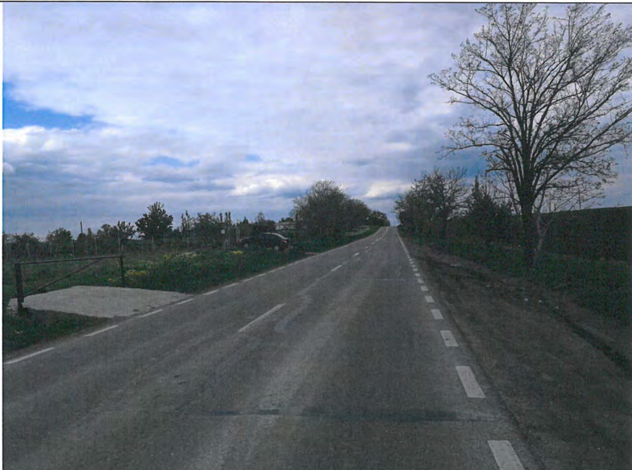
Foto 12: Drumul National DN 29, km 46+000 -47+000– Fisuri longitudinale și transversale colmate cu mastic bituminos.
