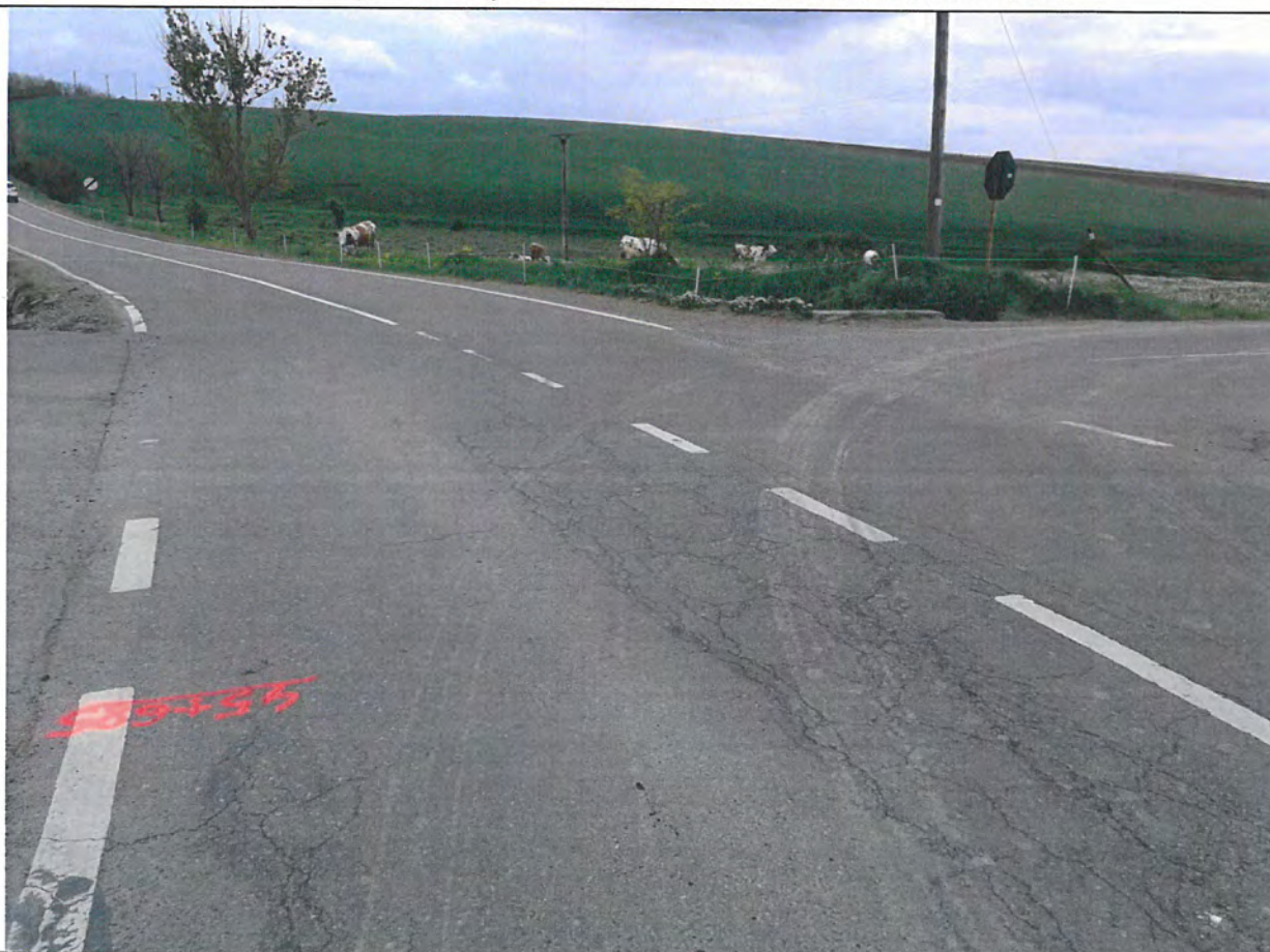
Foto 8: Drumul National DN 29, km 45+000 -46+000– Intersectie la nivel DN 29 – DJ 296A. Multiple fisuri si faiantari pe zona mediana a drumului national.
