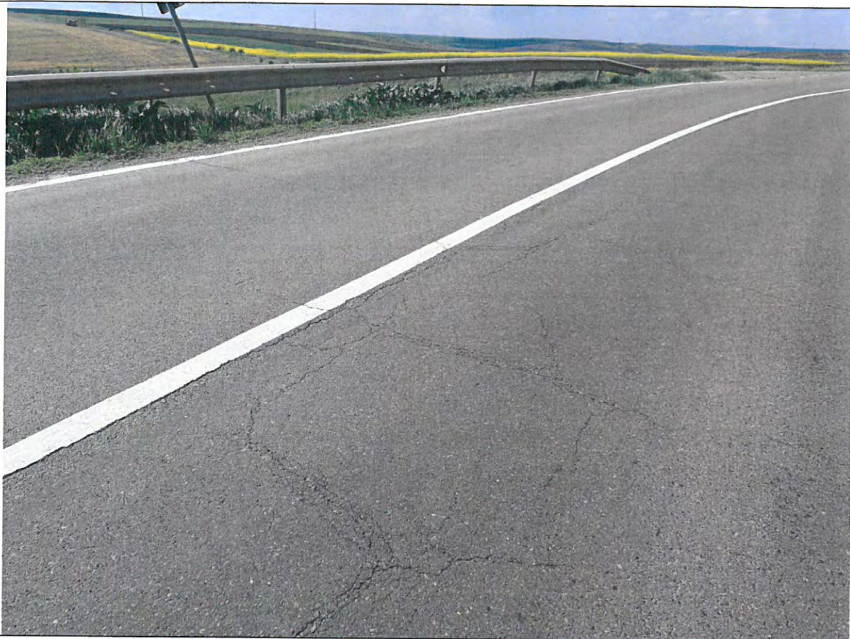
Foto 63: Drumul National DN 29, km 59+000 - 60+000 – Fisuri longitudinale si transversale.
