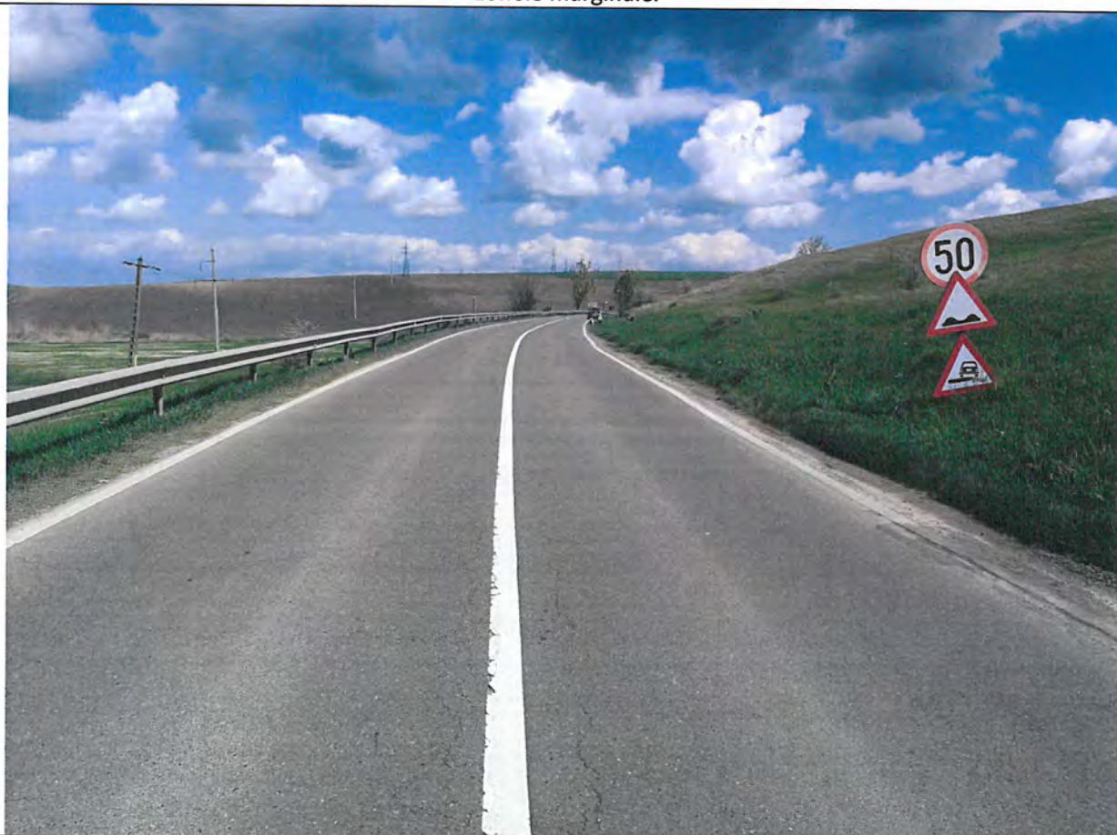
Foto 22: Drumul National DN 29, km 49+000 - 50+000— Sector de drum caracterizat de denivelari ale partii carosabile. Lipsa santurilor pe zona de debleu.
