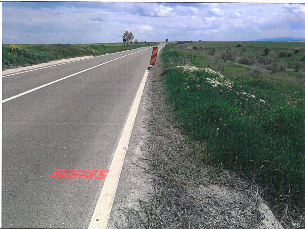
Foto 58: Drumul National DN 29, km 58+000 - 59+000 – Zona cu probleme de stabilitate.
