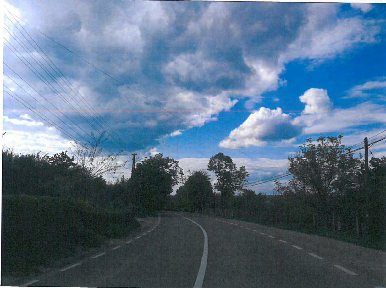
Foto 80: Drumul National DN 29, km 63+000 - 64+000 – Parte carosabila aflata intr-o stare tehnica corespunzatoare. Lipsa santurilor pe zona de debleu.
