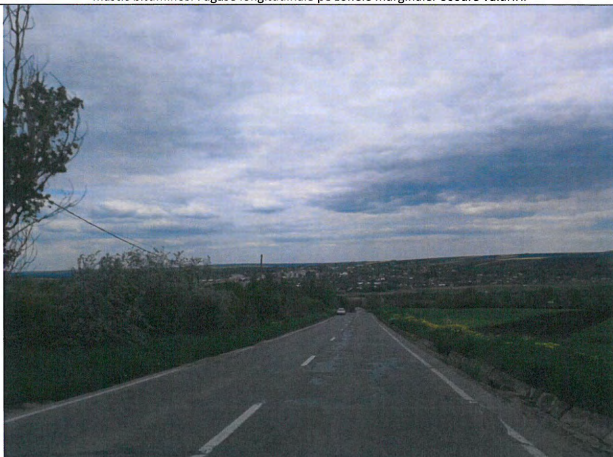
Foto 118: Drumul National DN 29, km 74+000 - 75+000 – Multiple fisuri la nivelul partii carosabile colmatate cu mastic bituminos. Fagase longitudinale pe zonele marginale. Usoare valuriri.
