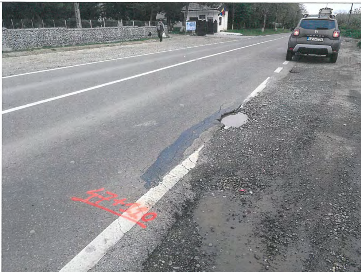
Foto 13: Drumul National DN 29, km 47+000 -48+000– Gropi marginale, fisuri longitudinale.
