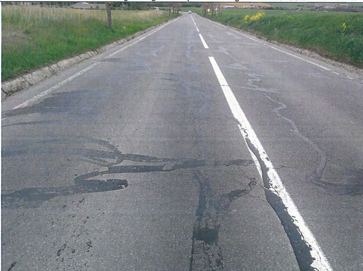
Foto 116: Drumul National DN 29, km 73+000 - 74+000 – Multiple fisuri la nivelul partii carosabile colmatate cu mastic bituminos. Fagase longitudinale pe zonele marginale. Usoare valuriri.
