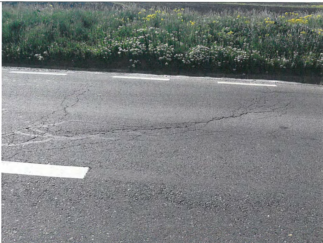
Foto 73: Drumul National DN 29, km 62+000 - 63+000 – Fisuri pe mai multe directii, faientari.
