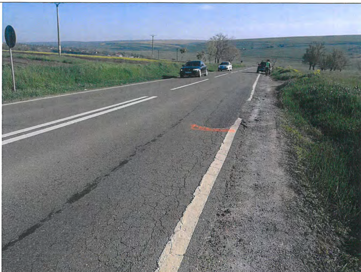
Foto 37: Drumul National DN 29, km 53+000 - 54+000 - Rupturi de margine a mixturii asfaltice, tasari si fagase longitudinale. Lucrari de reparatie prin plombari.
