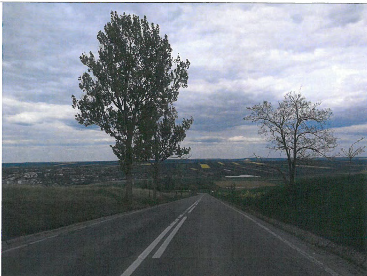
Foto 115: Drumul National DN 29, km 73+000 - 74+000 – Multiple fisuri la nivelul partii carosabile colmatate cu mastic bituminos. Fagase longitudinale pe zonele marginale. Usoare valuriri.
