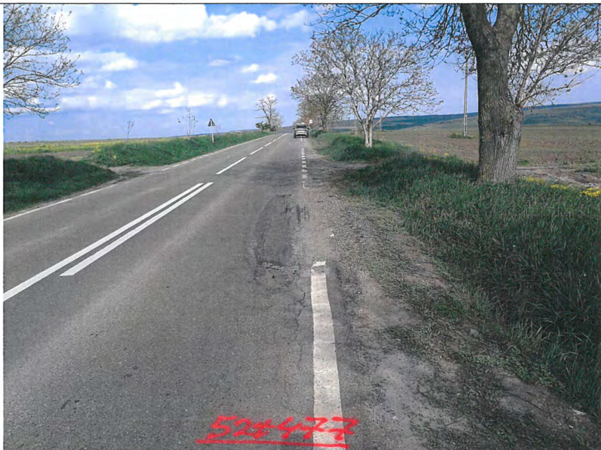
Foto 35: Drumul National DN 29, km 52+000 - 53+000 - Refulari de margine, fagase longitudinale, fisuri longitudinale.
