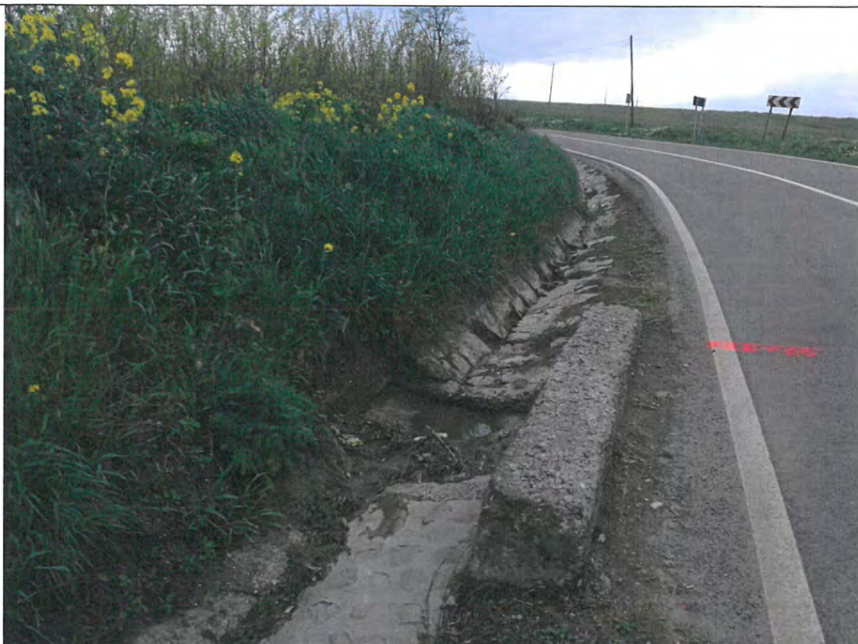
Foto 15: Drumul National DN 29, km 47+000 - 48+000— Santuri cu sectiune pavata, camera de cadere complet colmatata.
