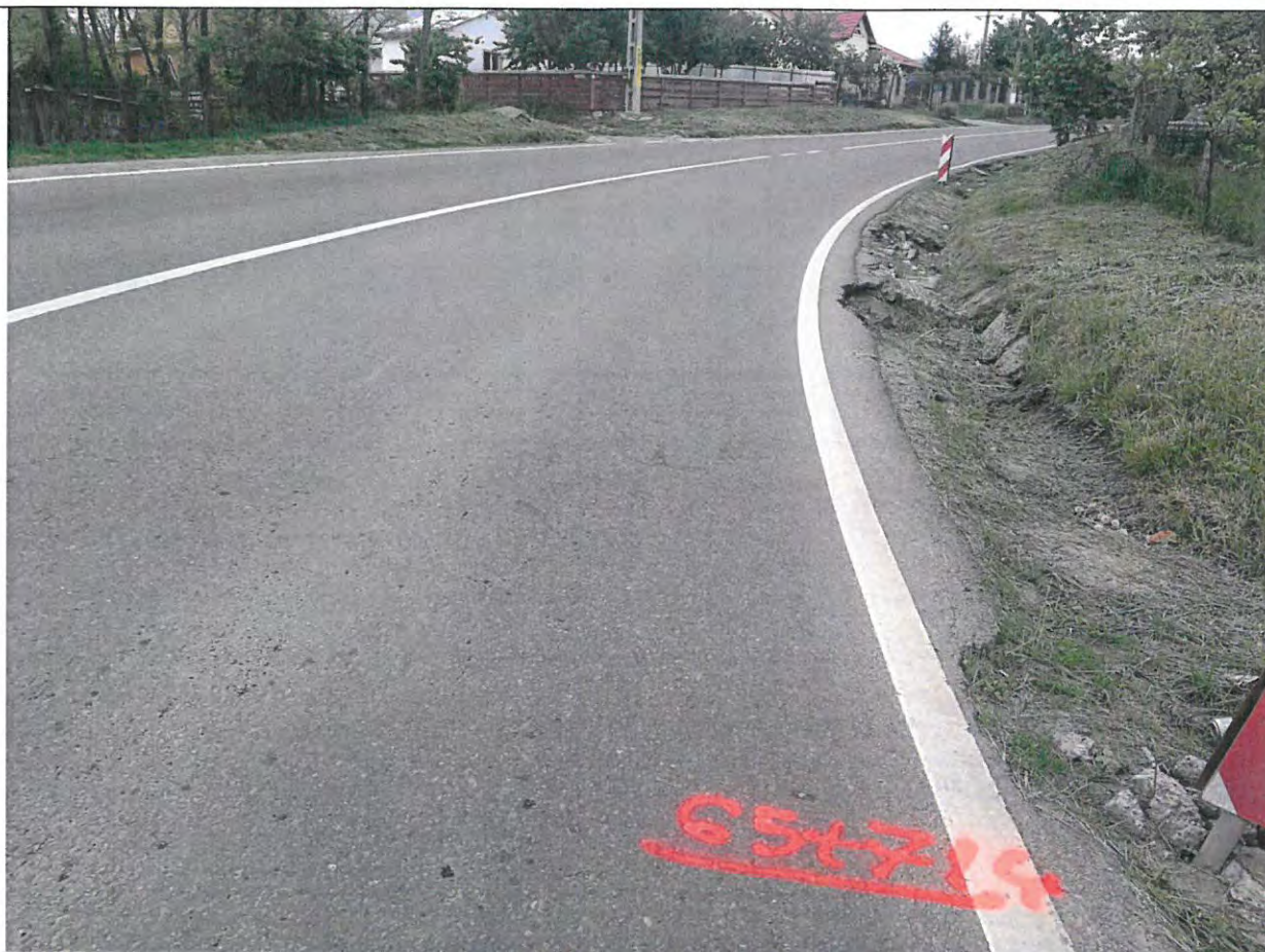
Foto 87: Drumul National DN 29, km 65+000 - 66+000 – Rupturi si subpalari in zona acostamentelor cu posibilitate de avansare la nivelul partii carosabile.
