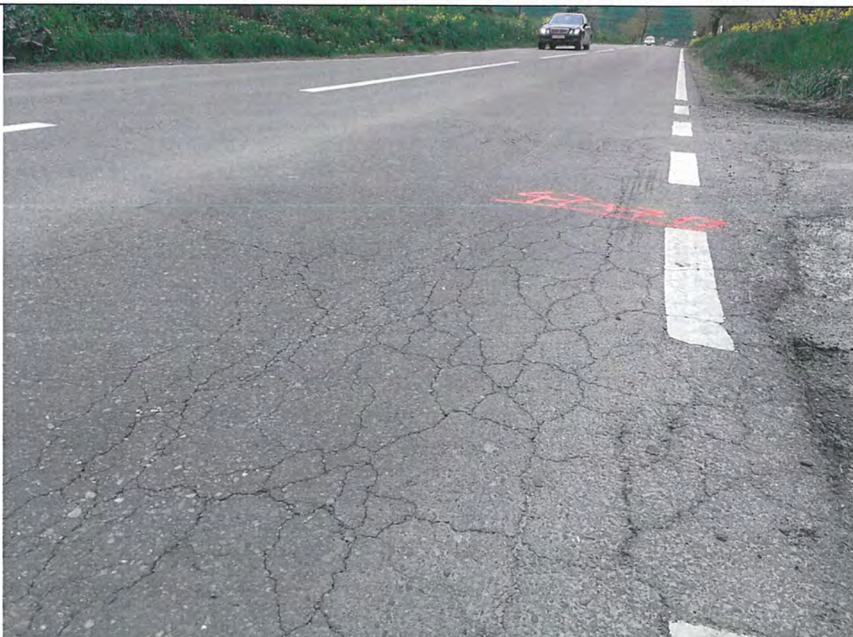
Foto 14: Drumul National DN 29, km 47+000 - 48+000– Faientari in panza de paianjen si in placi pe suprafete extinse.
