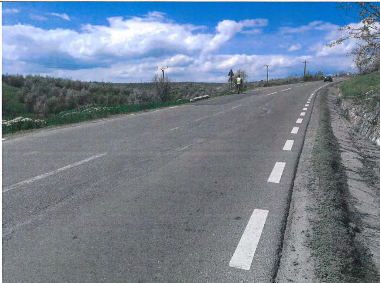
Foto 28: Drumul National DN 29, km 50+000 - 51+000– Zona afectata de tasari, denivelari datorate cedarii taluzului de rambleu.
