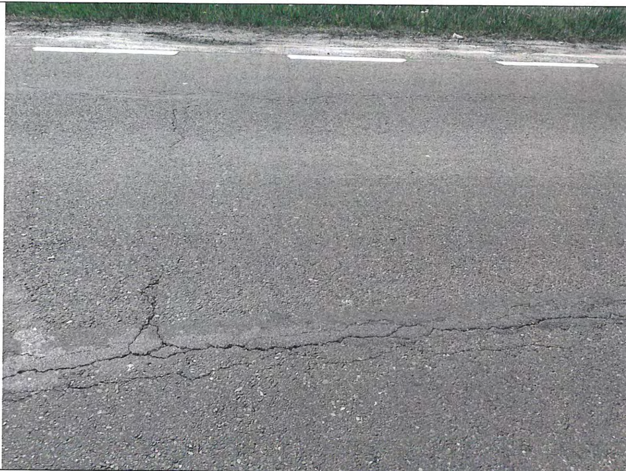
Foto 65: Drumul National DN 29, km 60+000 - 61+000 – Fisuri longitudinale pe zona mediana a drumului national.
