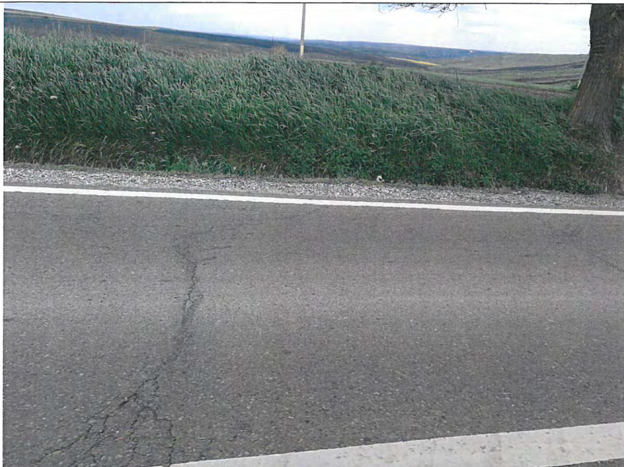
Foto 107: Drumul National DN 29, km 71+000 - 72+000 – Fisuri transversale si fagase longitudinale.
