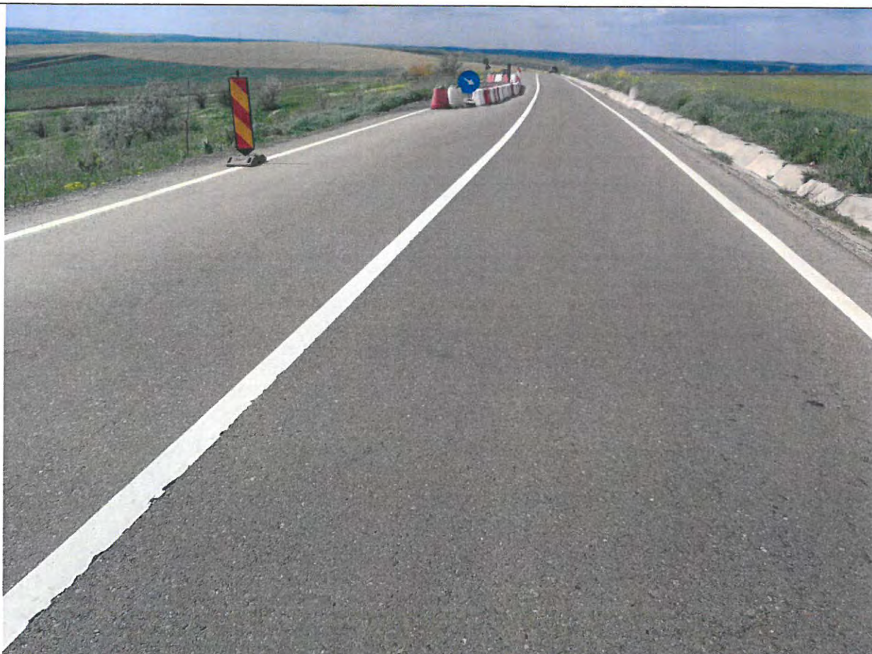
Foto 59: Drumul National DN 29, km 58+000 - 59+000 – Zona cu probleme de stabilitate partea stanga. Datorita cedarii taluzului de rambleu banda de circulatie este restrictionata.
