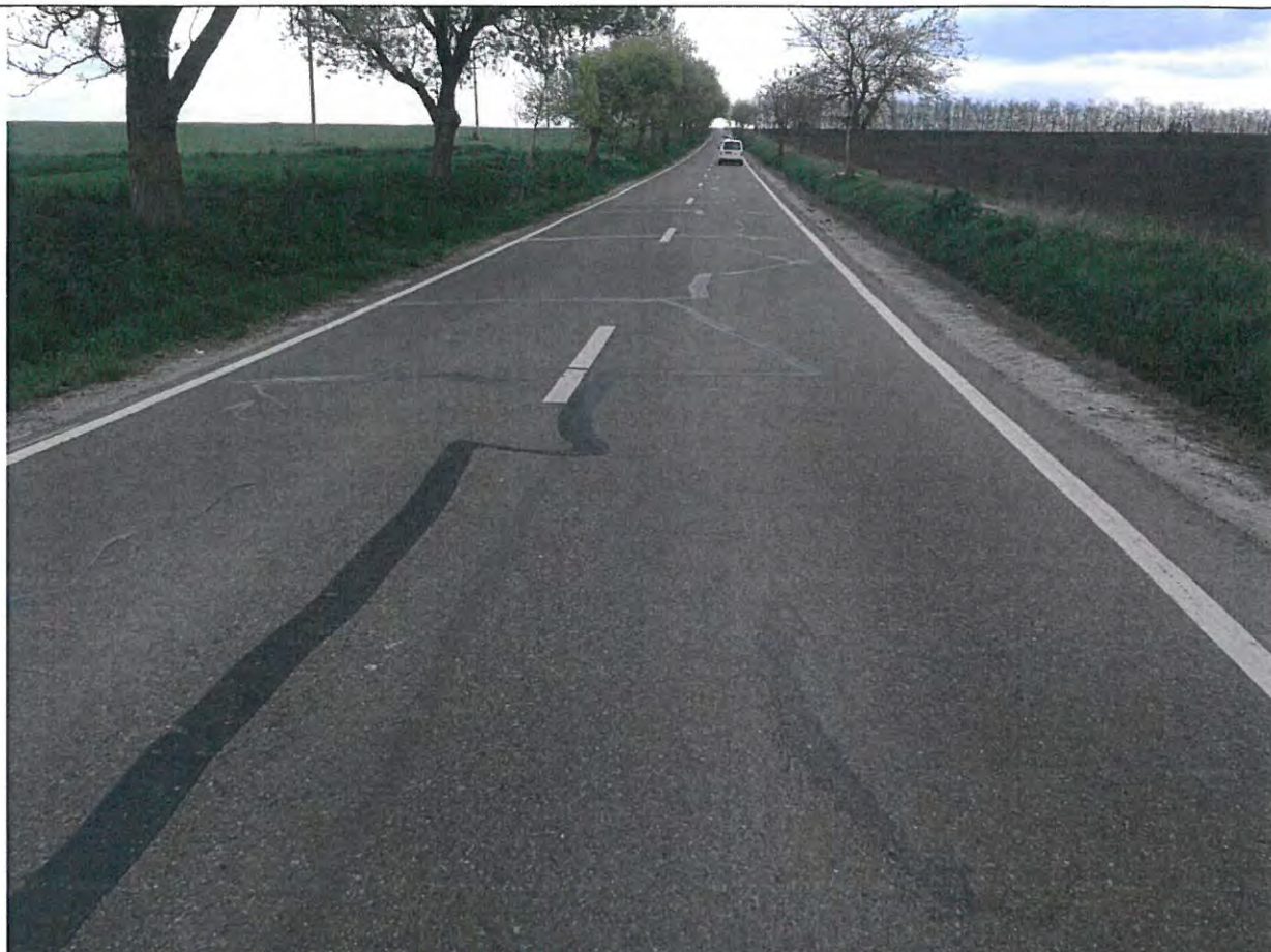
Foto 105: Drumul National DN 29, km 70+000 - 71+000 – Multiple fisuri la nivelul partii carosabile colmatate cu mastic bituminos. Fagase longitudinale pe zonele marginale.
