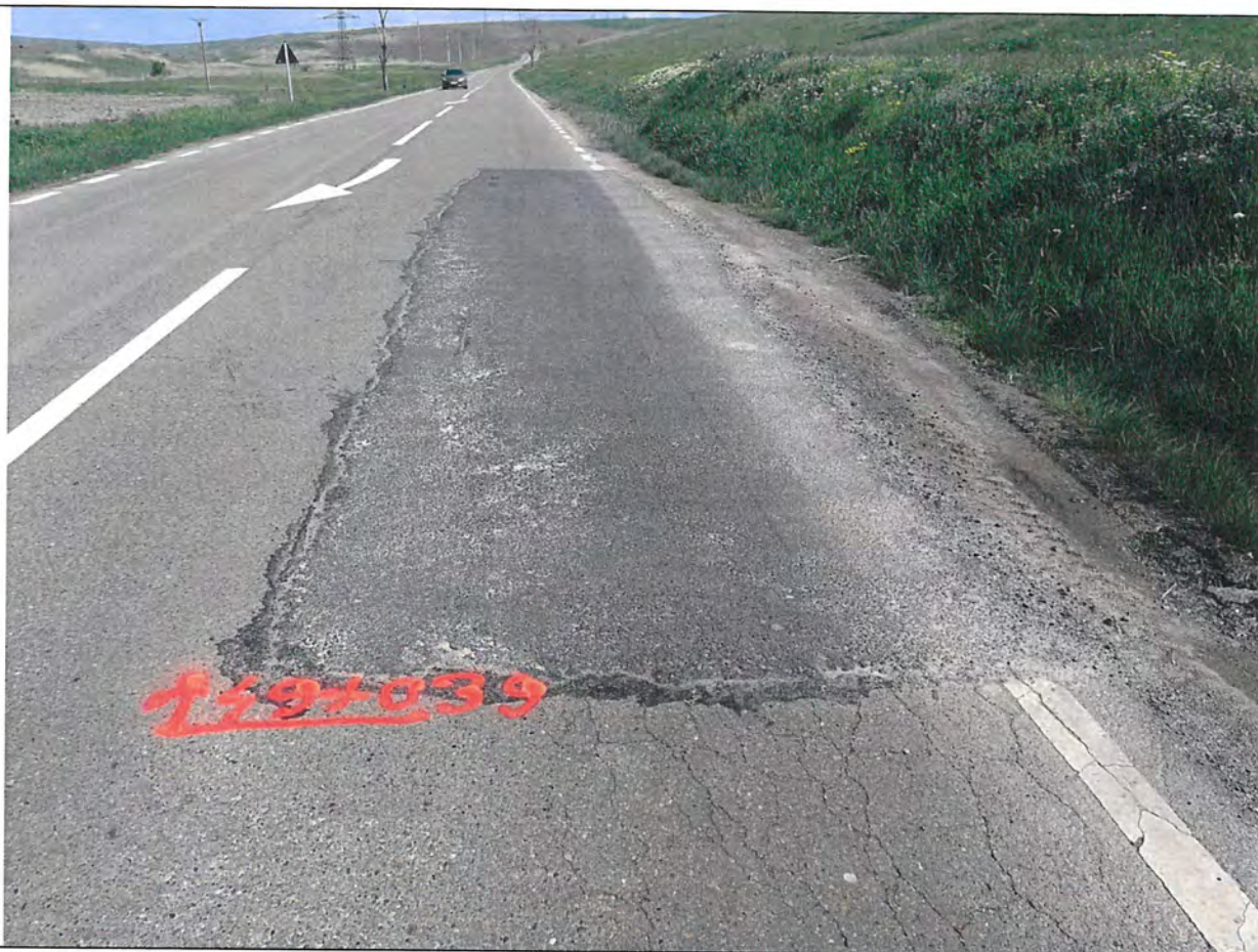
Foto 21: Drumul National DN 29, km 49+000 - 50+000— Lucrari de reparatii prin plombare. Multiple faiantari pe zonele marginale.
