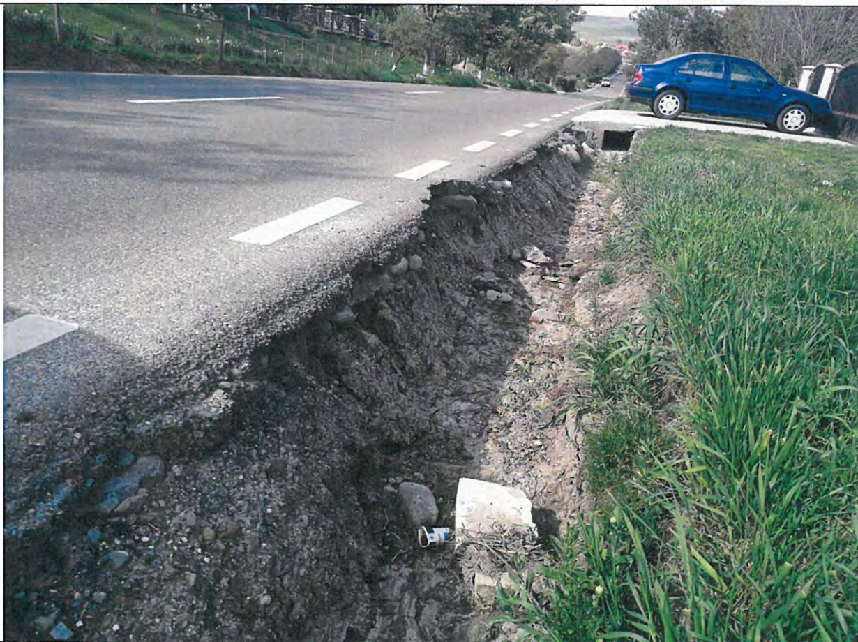
Foto 74: Drumul National DN 29, km 62+000 - 63+000 – Subspalari ale sistemului rutier cu risc avansat de cedare a partii carosabile.
