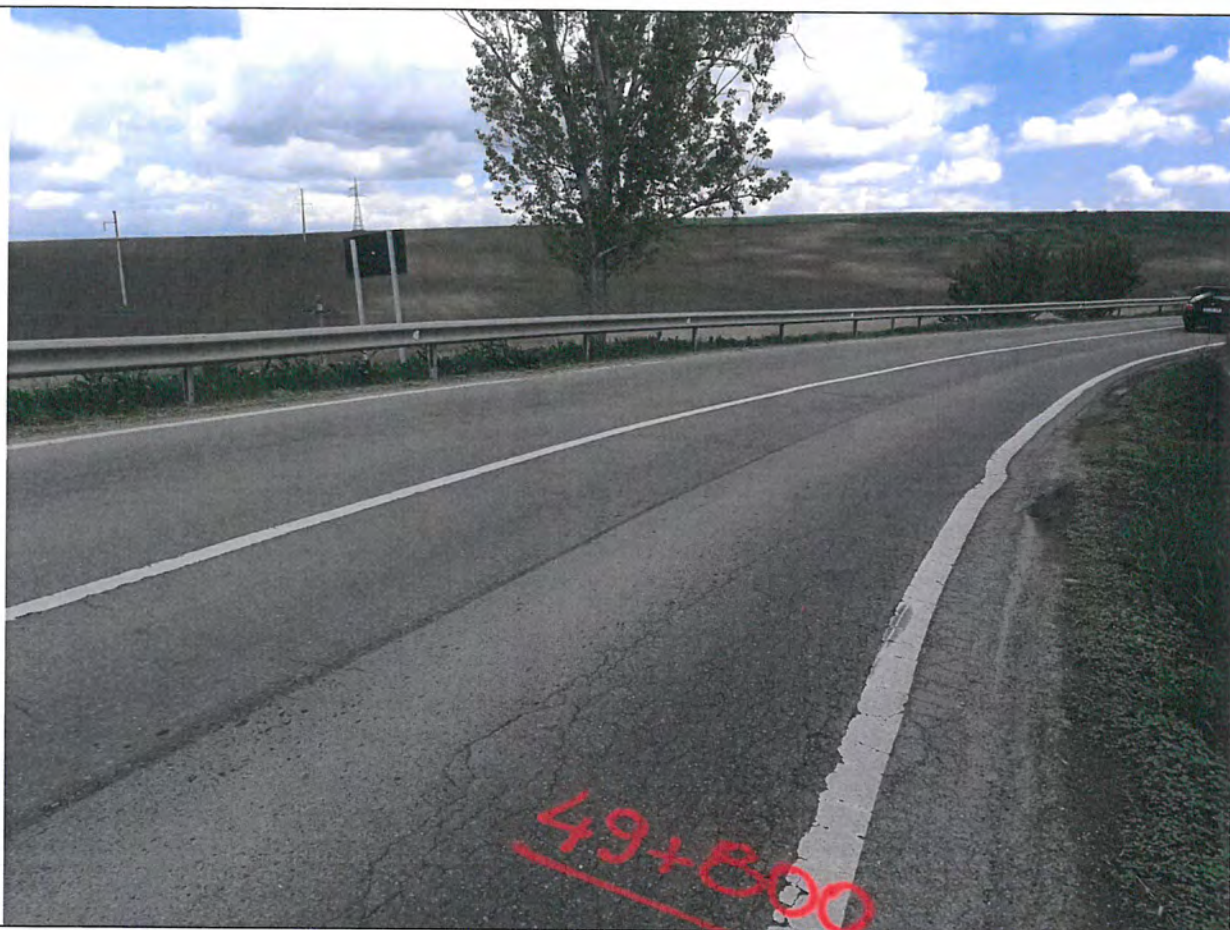
Foto 23: Drumul National DN 29, km 49+000 - 50+000– Acostamente denivelate cu panta inspre partea carosabila. Faientari, gropi la nivelul acostamentelor.
