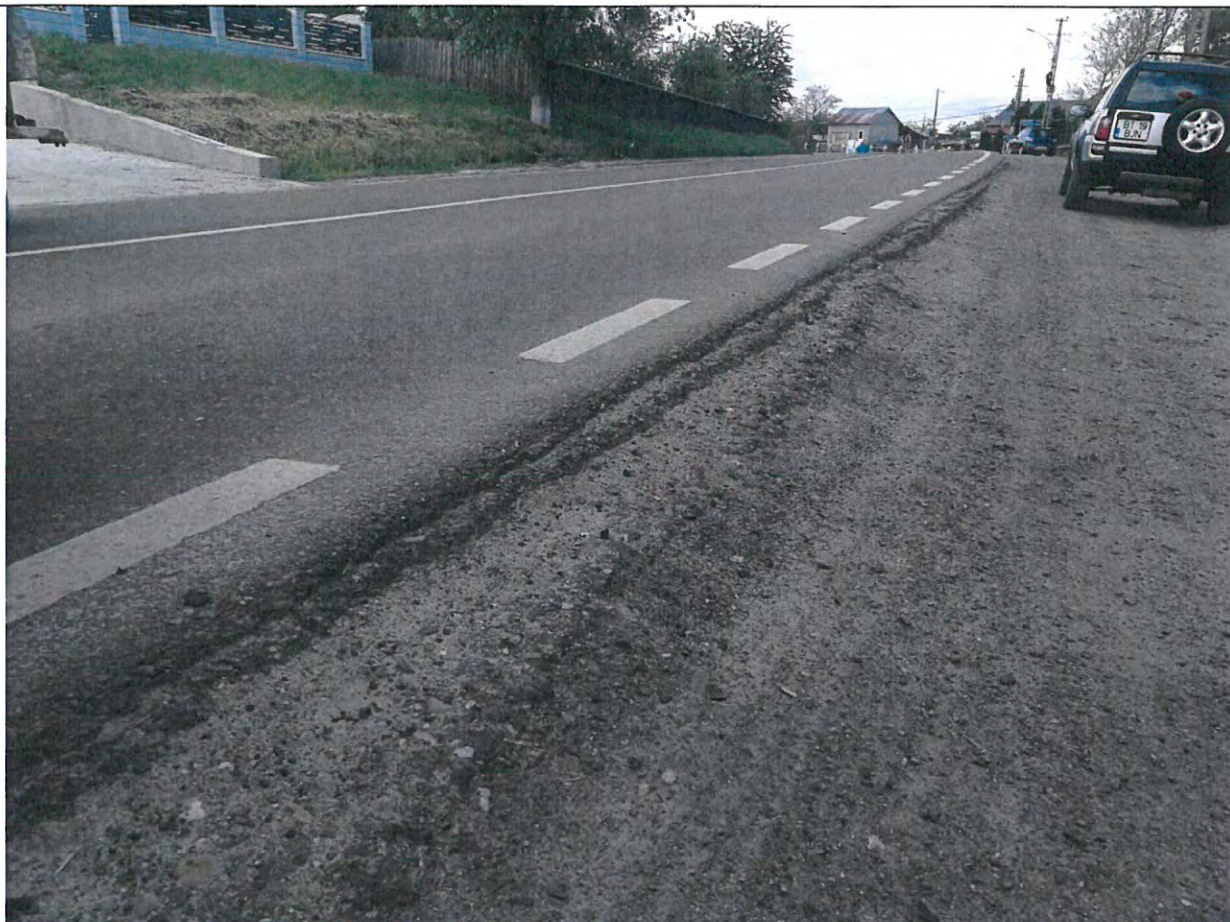
Foto 77: Drumul National DN 29, km 63+000 - 64+000 – Turnari succesive covoare asfaltice. Diferenta semnificativa de nivel intre partea carosabila si acostament.
