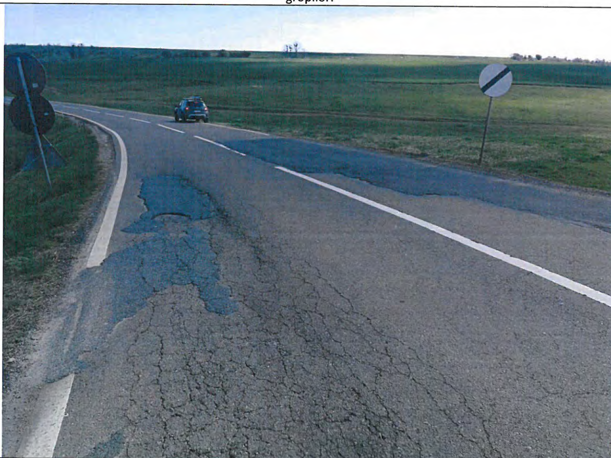
Foto 42: Drumul National DN 29, km 54+000 - 55+000 - Fagase longitudinale, faientari avansate, risc de aparitie a gropilor. Lucrari de reparatie prin plombari pe suprafete extinse.
