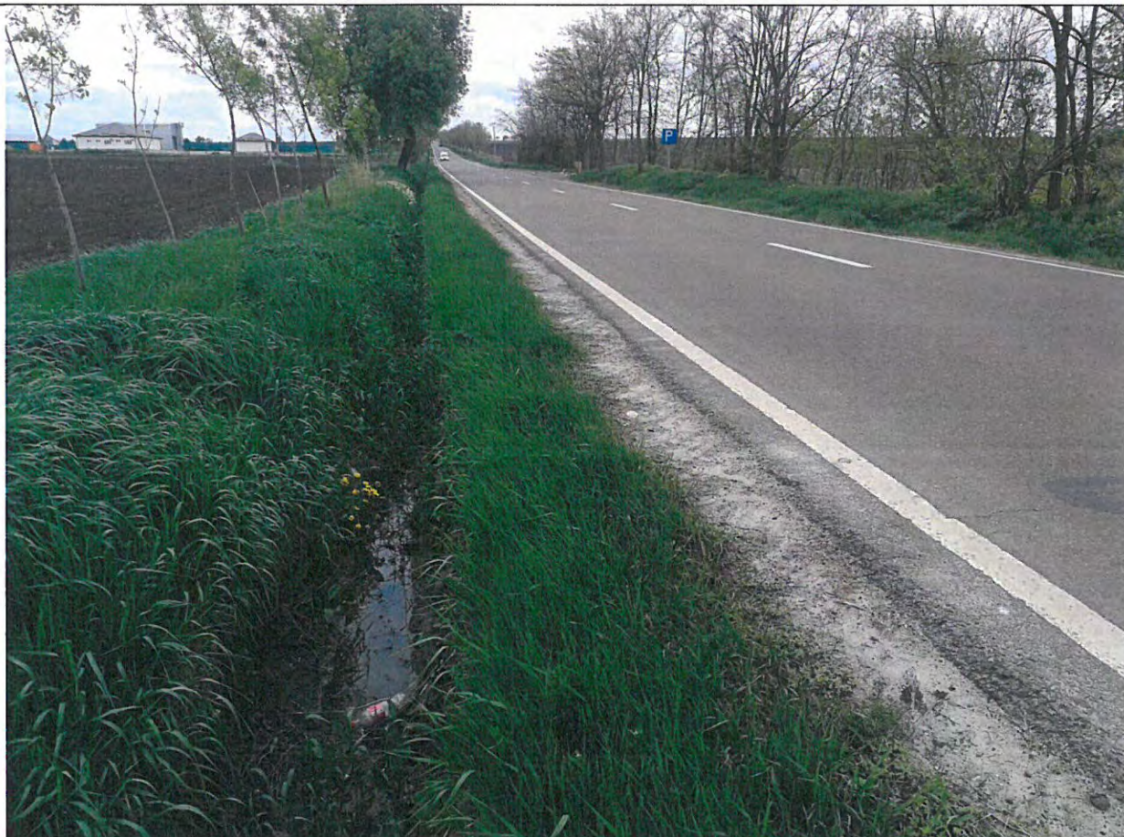
Foto 96: Drumul National DN 29, km 67+000 - 68+000 – Acostamente inierbate. Santuri colmatate, apele stagneaza la nivelul acestora.
