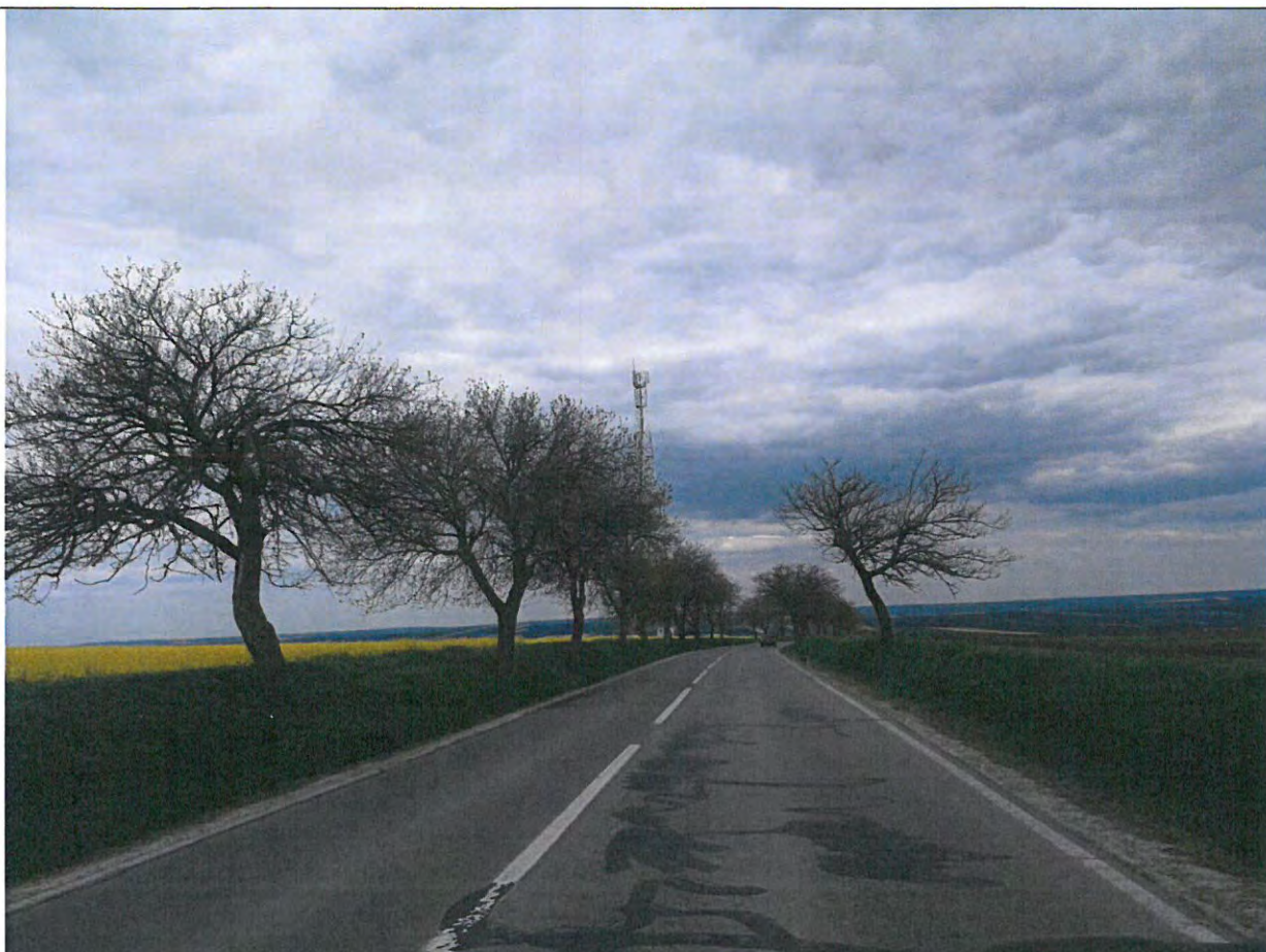
Foto 111: Drumul National DN 29, km 72+000 - 73+000 – Multiple fisuri la nivelul partii carosabile colmatate cu mastic bituminos. Fagase longitudinale pe zonele marginale. Usoare valuriri.
