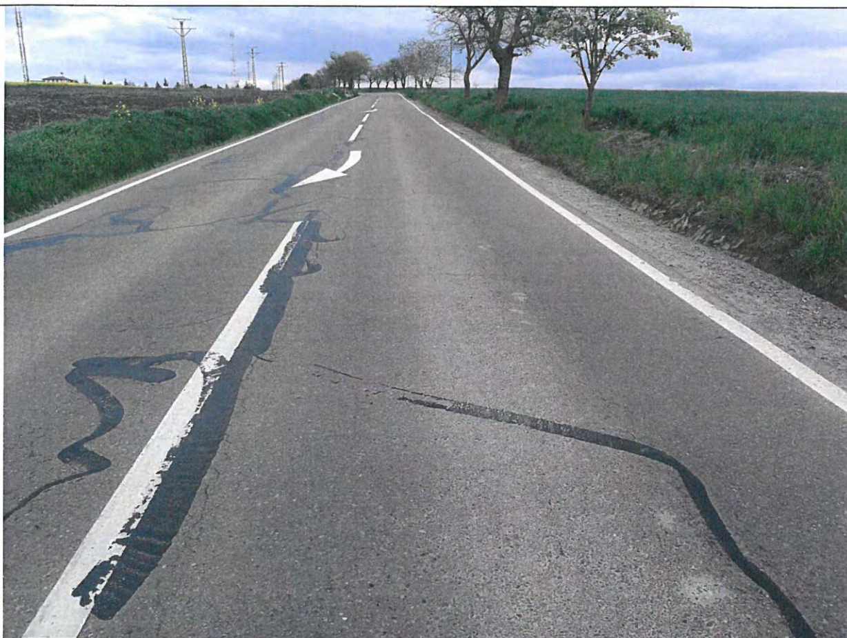
Foto 109: Drumul National DN 29, km 72+000 - 73+000 – Multiple fisuri la nivelul partii carosabile colmatate cu mastic bituminos. Fagase longitudinale pe zonele marginale. Usoare valuriri.
