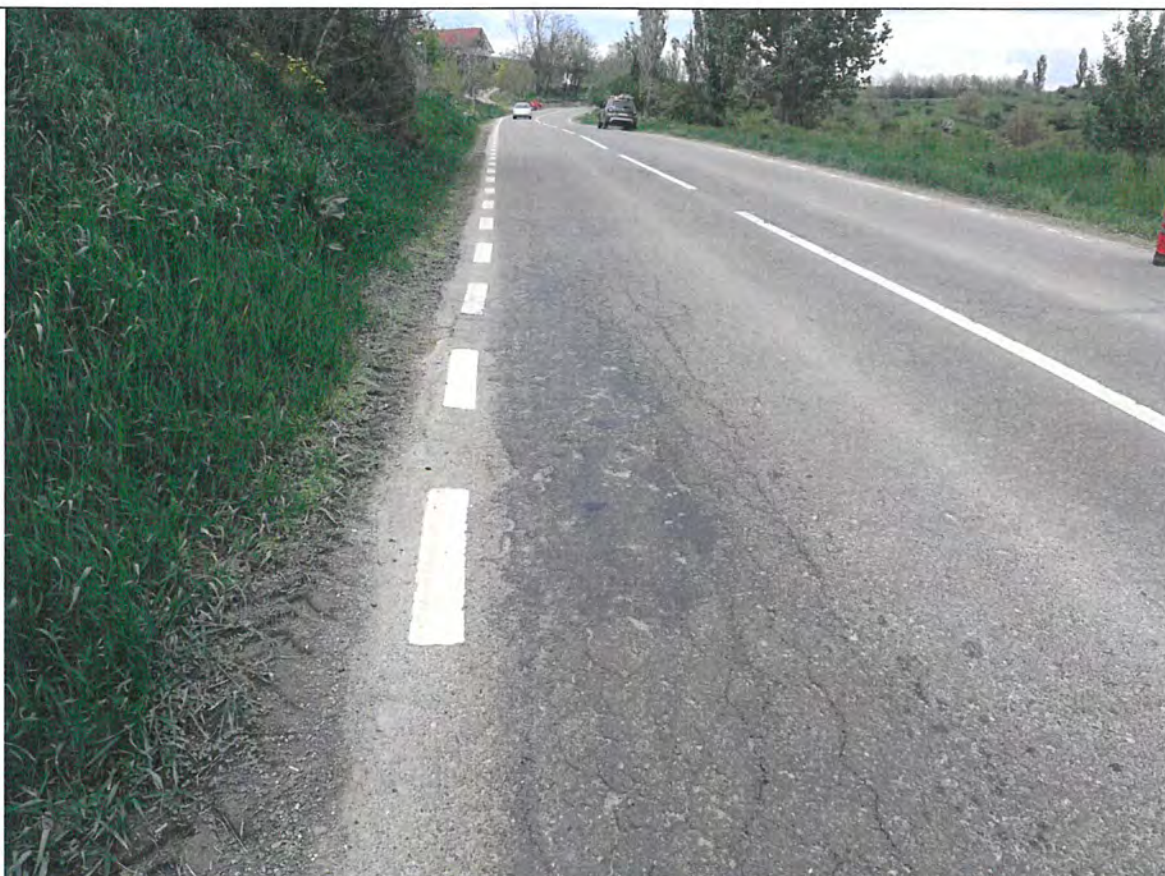
Foto 3: Drumul National DN 29, km 44+100 -45+000– Imbracaminte asfaltica cu fisuri longitudinale faiantari pe suprafete extinse, lucrari de reparatii prin acoperirea faiantarilor cu mastic bituminos. Lipsa sistemelor de colectare a apelor pluviale pe zona de debleu.
