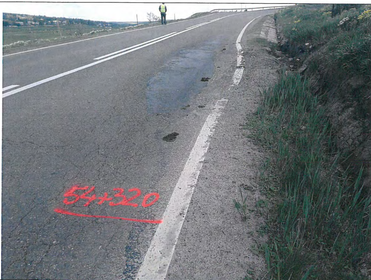
Foto 43: Drumul National DN 29, km 54+000 - 55+000 - Refulari de margine, tasari, faiantari si fisuri.
