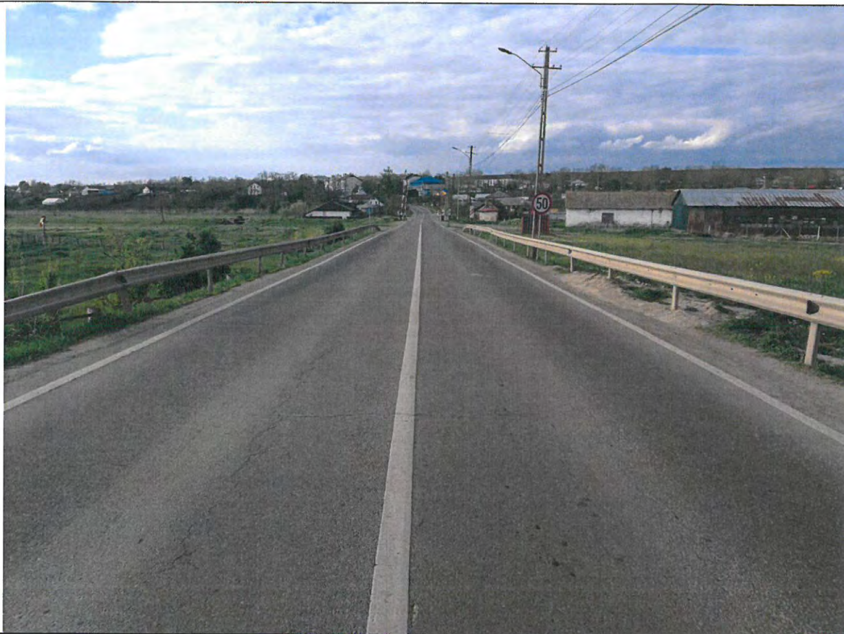
Foto 83: Drumul National DN 29, km 64+000 - 65+000 – Fagase longitudinale, usoare forme de denivelare.
