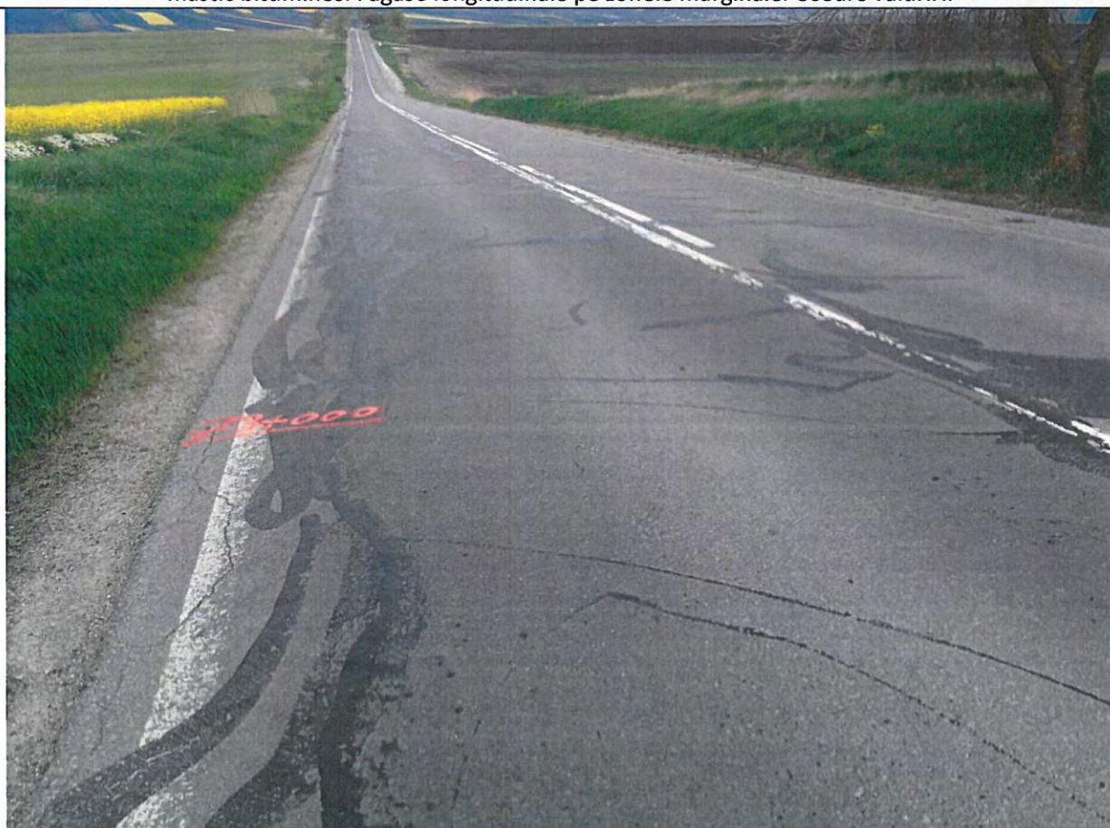
Foto 112: Drumul National DN 29, km 72+000 - 73+000 – Multiple fisuri la nivelul partii carosabile colmatate cu mastic bituminos. Fagase longitudinale pe zonele marginale. Usoare valuriri.
