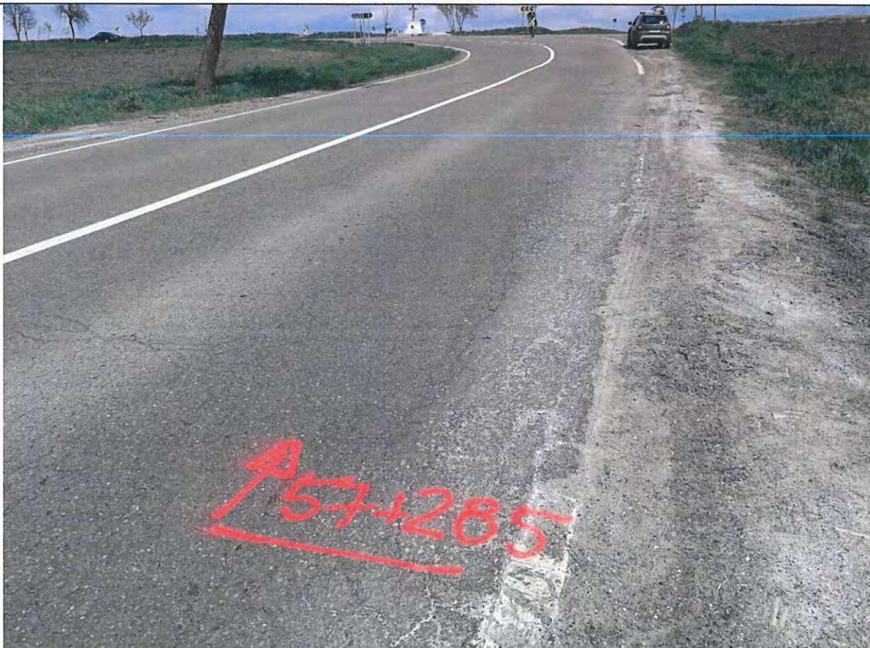
Foto 54: Drumul National DN 29, km 57+000 - 58+000 – Fagase longitudinale, acostamente cu panta inspre partea carosabila, borduri din beton delimitatoare a partii carosabile.
