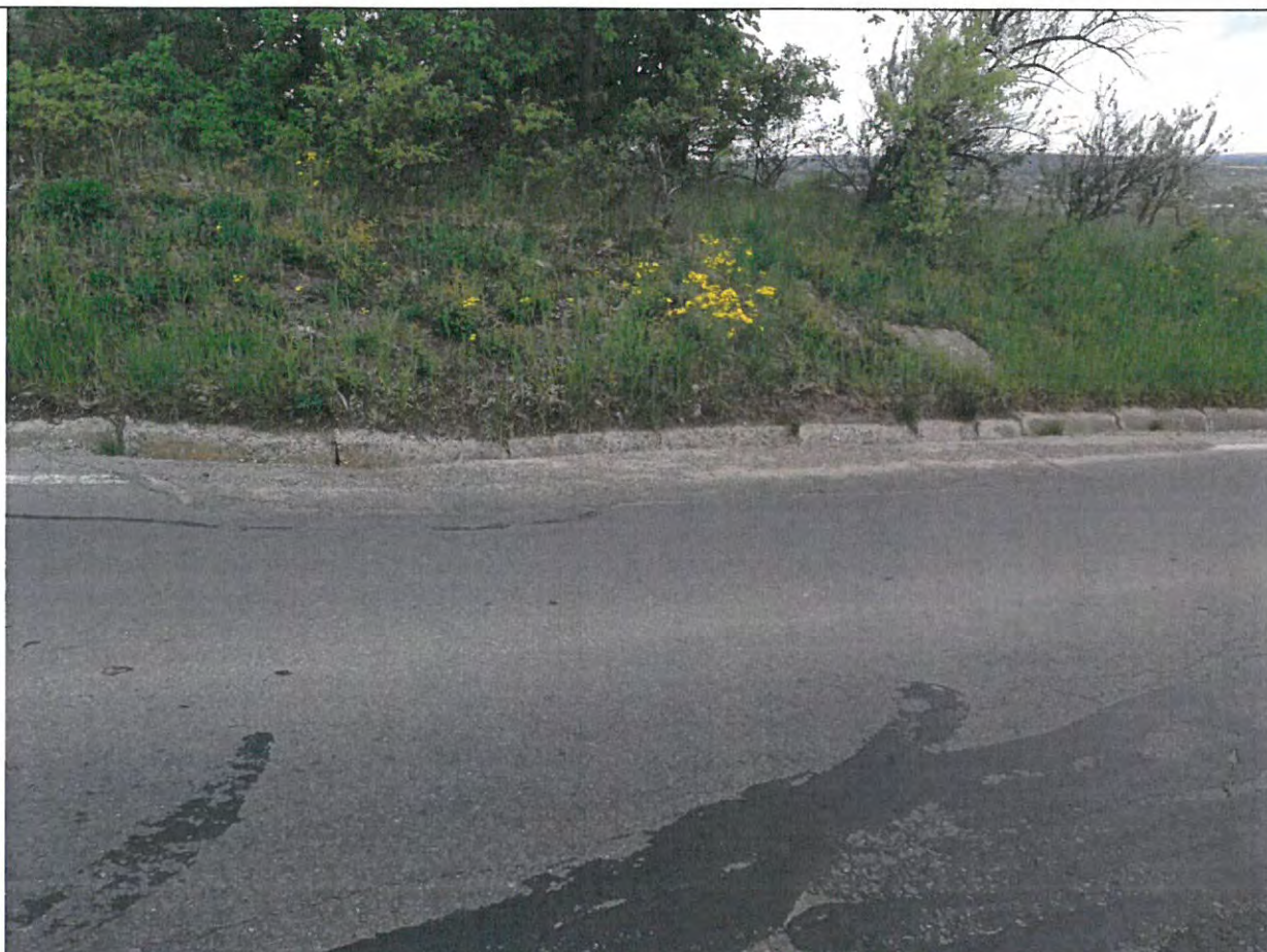
Foto 119: Drumul National DN 29, km 74+000 - 75+000 – Multiple fisuri la nivelul partii carosabile colmatate cu mastic bituminos. Fagase longitudinale pe zonele marginale. Denivelari ale sistemului rutier.
