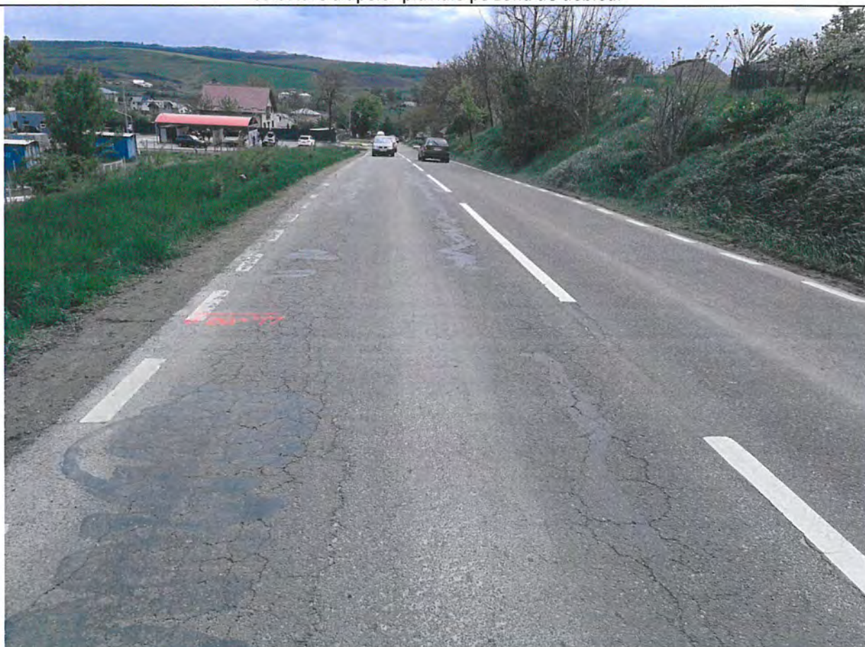
Foto 4: Drumul National DN 29, km 44+100 -45+000– Imbracaminte asfaltica cu fisuri longitudinale si transversale, faiantari pe suprafete extinse, lucrari de reparatii prin acoperirea faiantarilor cu mastic bituminos.
