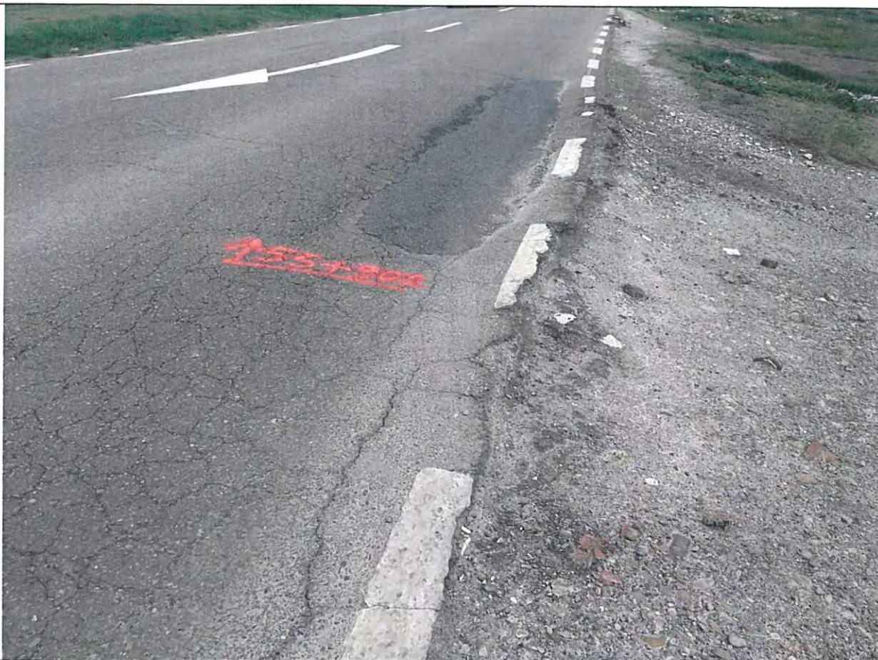
Foto 47: Drumul National DN 29, km 55+000 - 56+000 - Refulari si fagase marginale. Faientari pe suprafete extinse.
