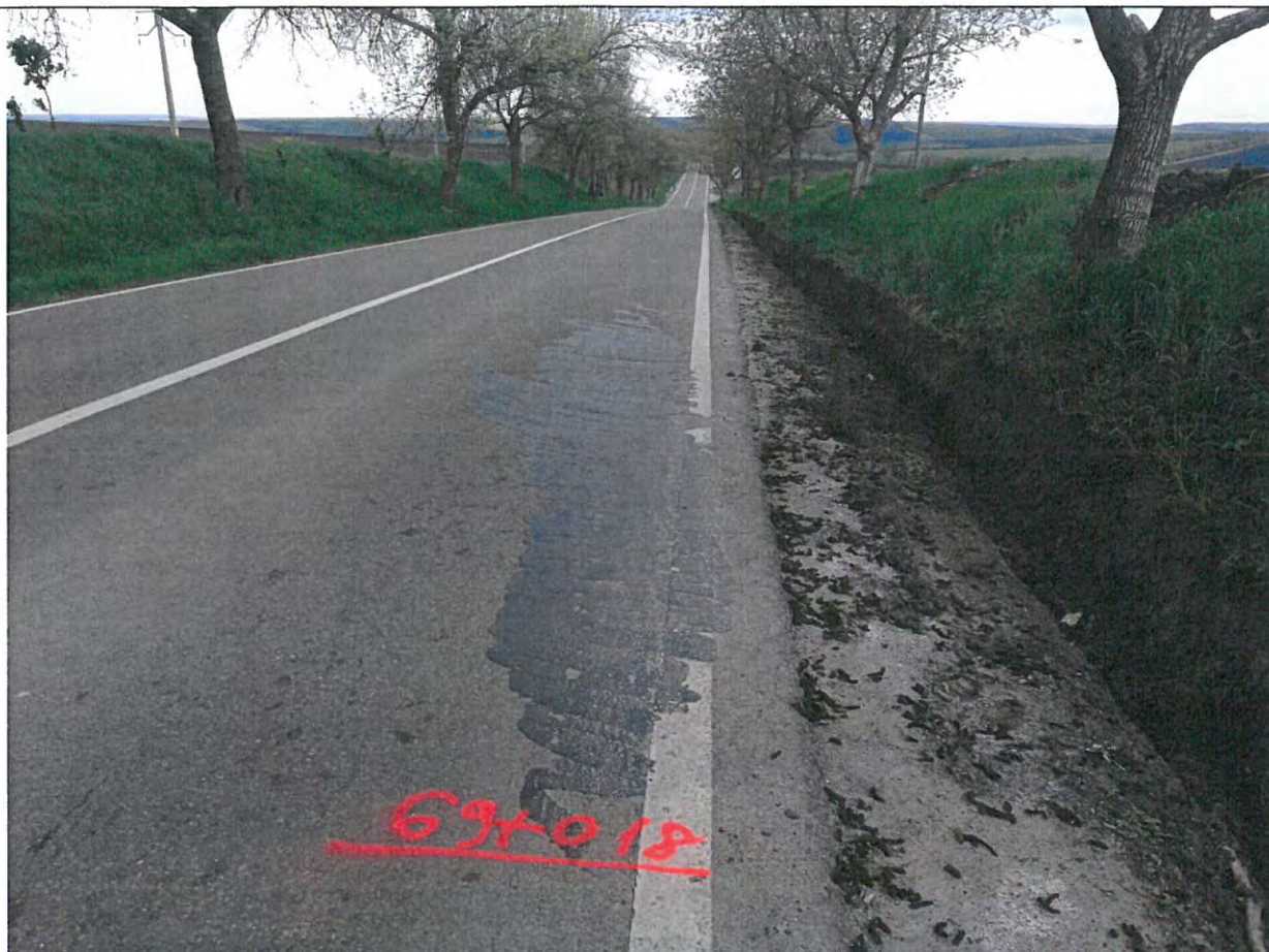
Foto 101: Drumul National DN 29, km 69+000 - 70+000 – Fagase longitudinale marginale.
