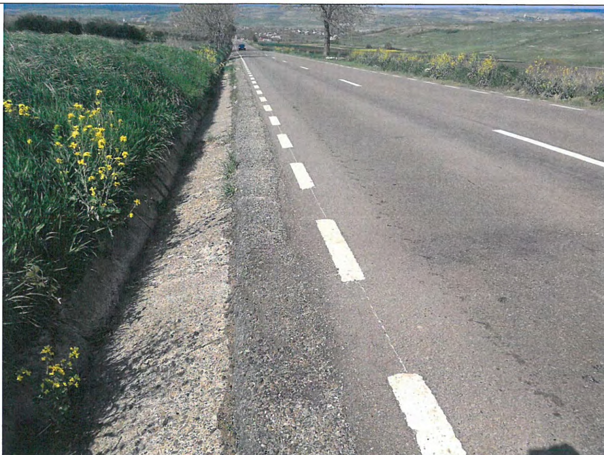
Foto 71: Drumul National DN 29, km 61+000 - 62+000 – Fagase longitudinale. Acostament din mixtura asfaltica denivelat.
