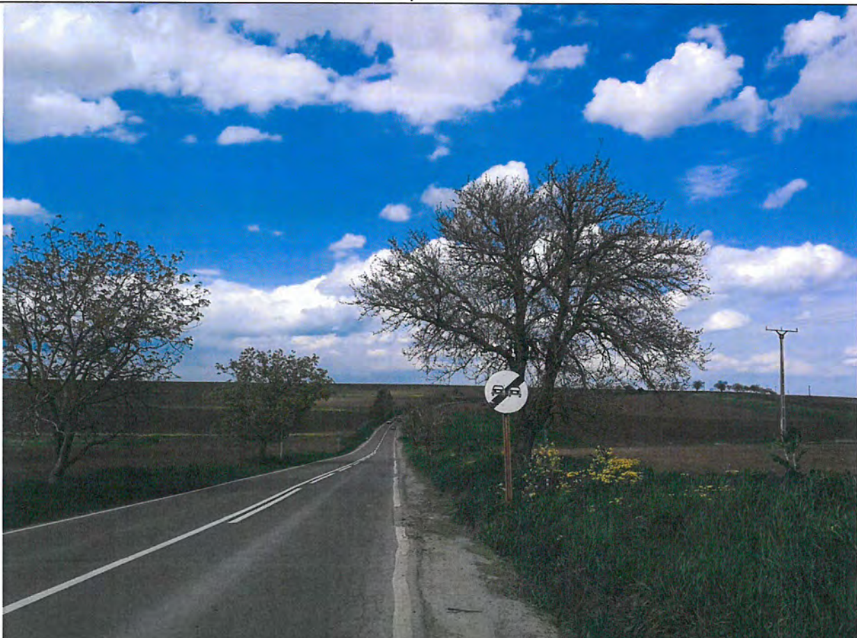
Foto 32: Drumul National DN 29, km 51+000 - 52+000 - Fagase longitudinale, rupturi de margine, refulari.
