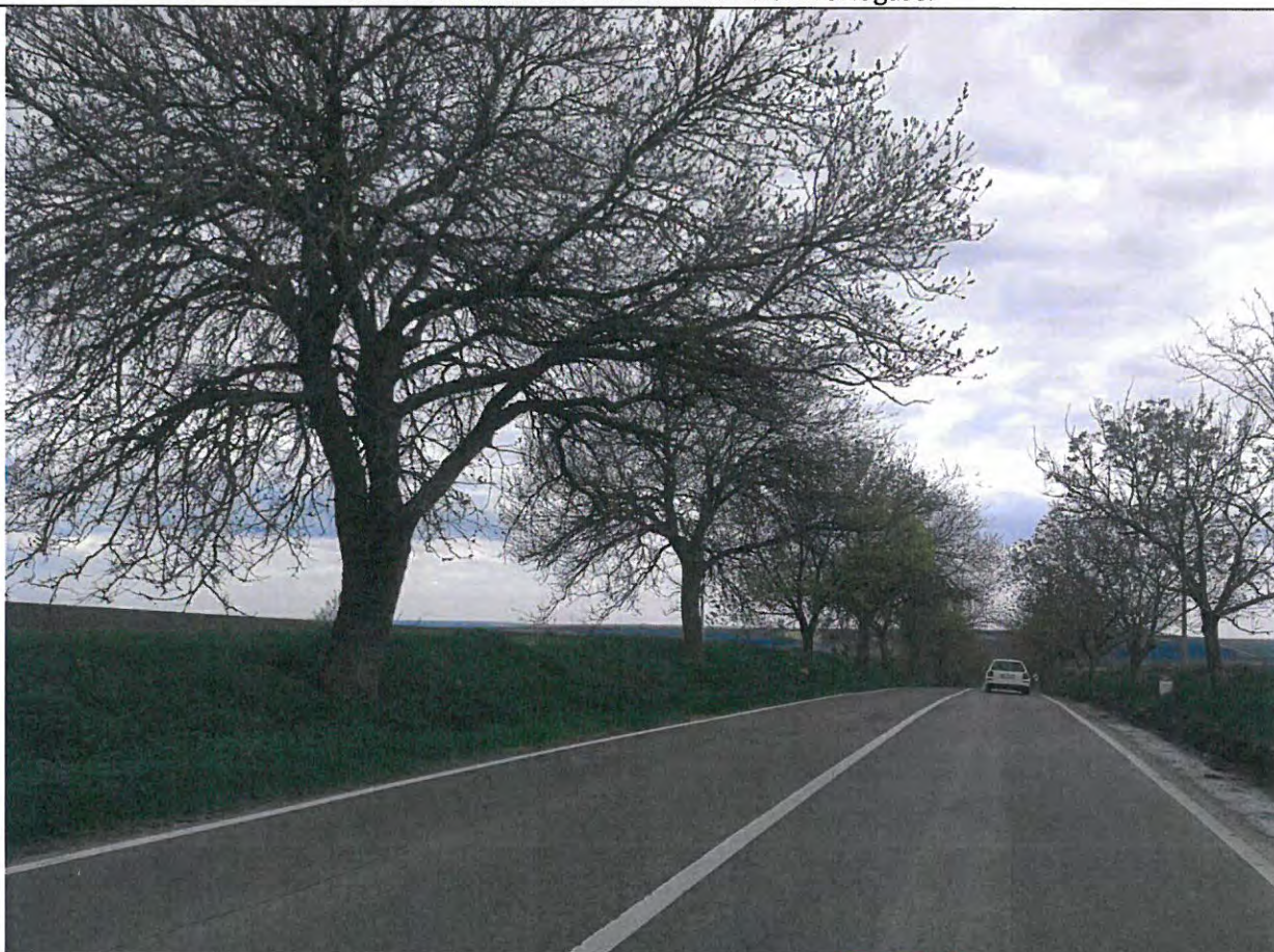
Foto 100: Drumul National DN 29, km 68+000 - 69+000 –Tronson caracterizat de usoare forme de valuriri si fagase.
