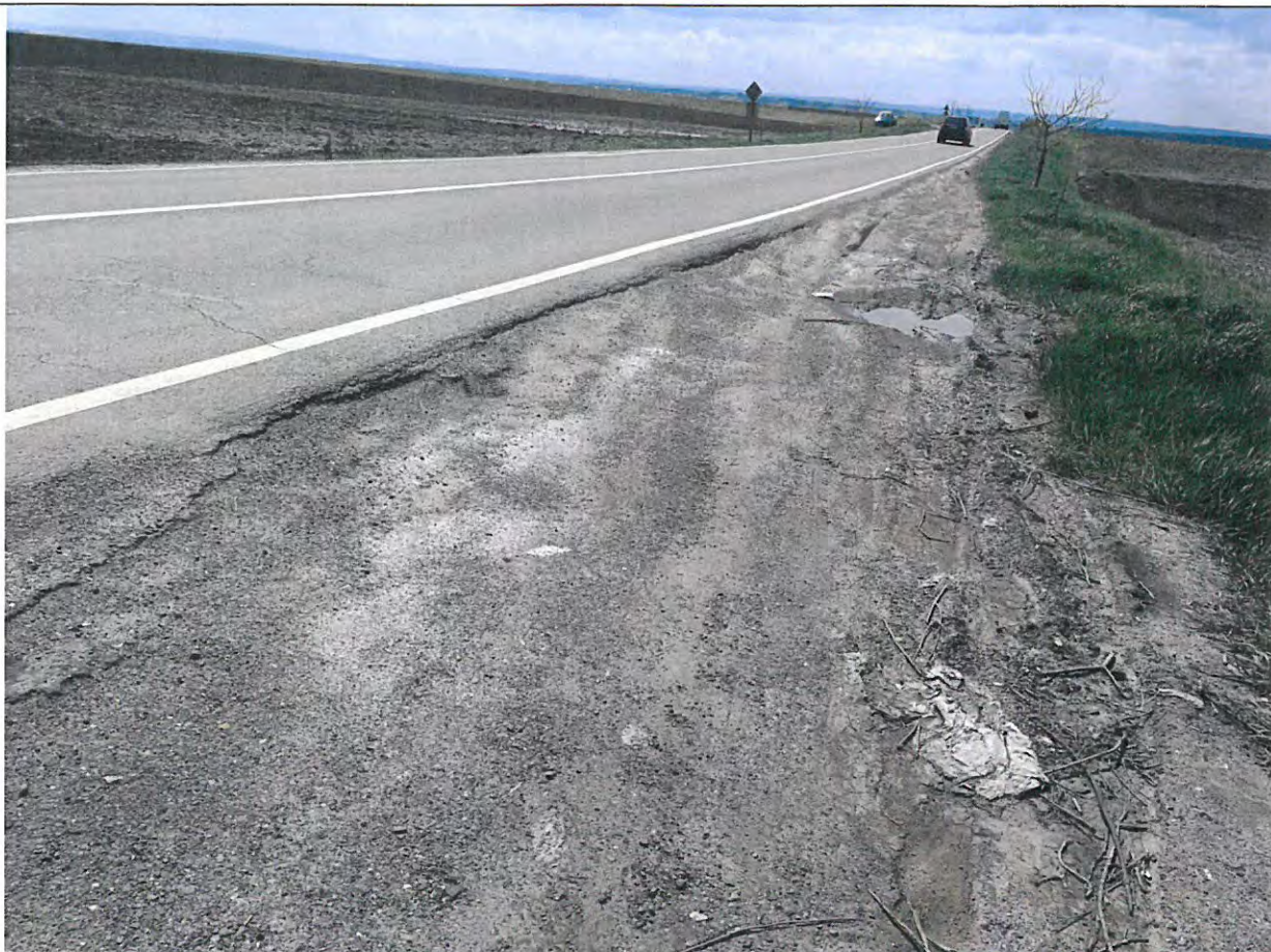
Foto 53: Drumul National DN 29, km 57+000 - 58+000 – Acostamente denivelate din pamant distruse, gropi la nivelul acestora.
