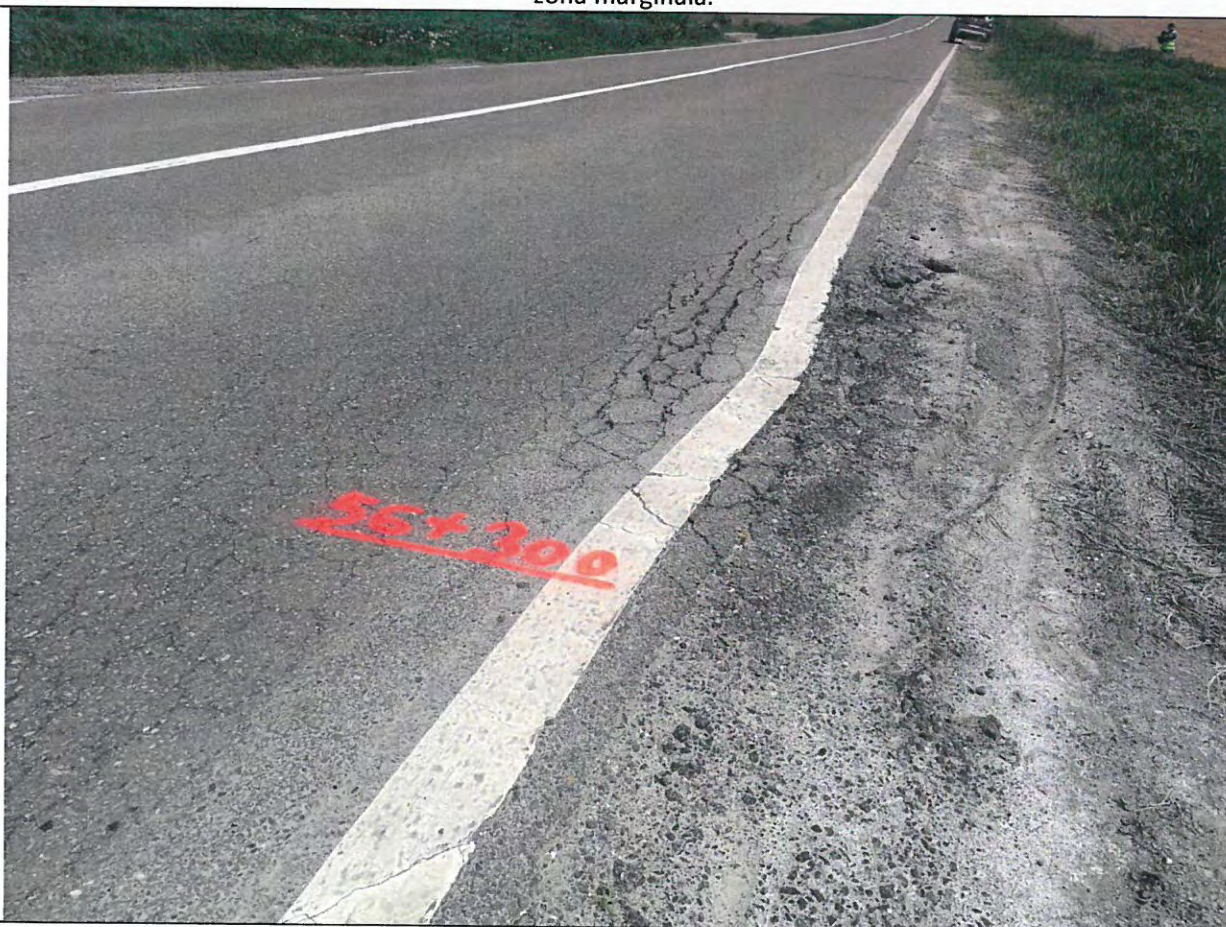
Foto 50: Drumul National DN 29, km 56+000 - 57+000 - Refulari de margine si faiantari.
