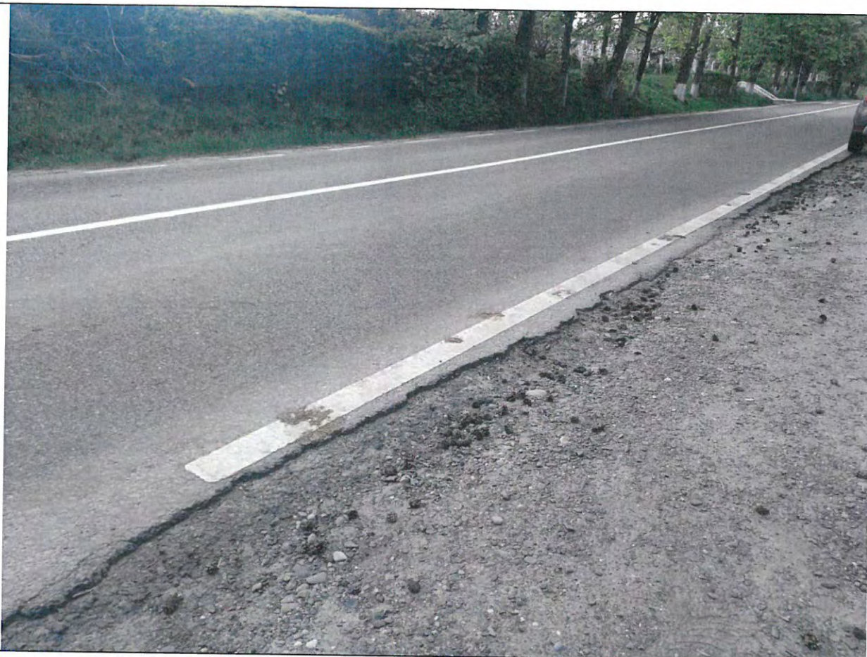
Foto 79: Drumul National DN 29, km 63+000 - 64+000 – Rupturi ale stratului de rulare pe zona acostamentului.
