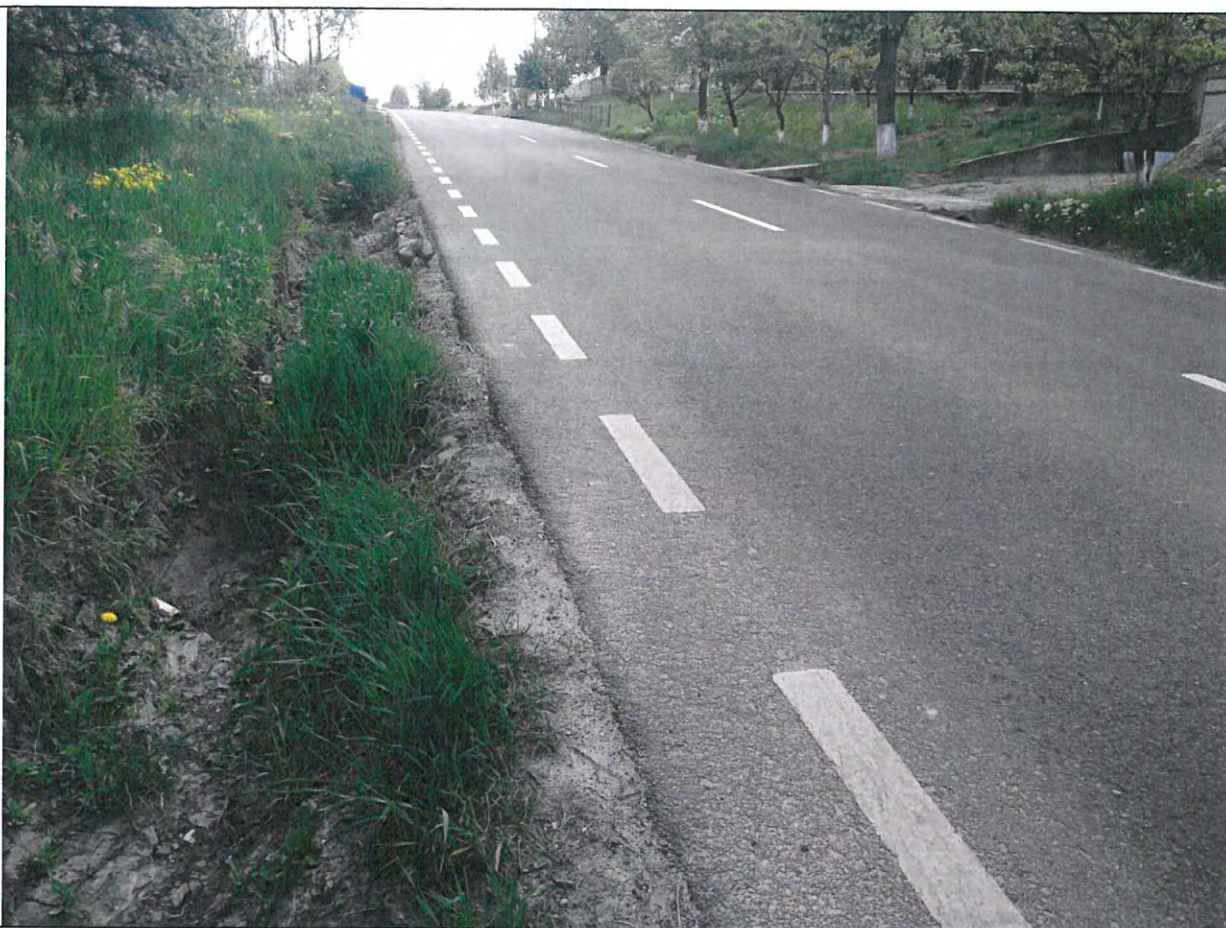
Foto 75: Drumul National DN 29, km 62+000 - 63+000 – Cedari ale acostamentului drumului national. Santuri inierbate si colmatate.
