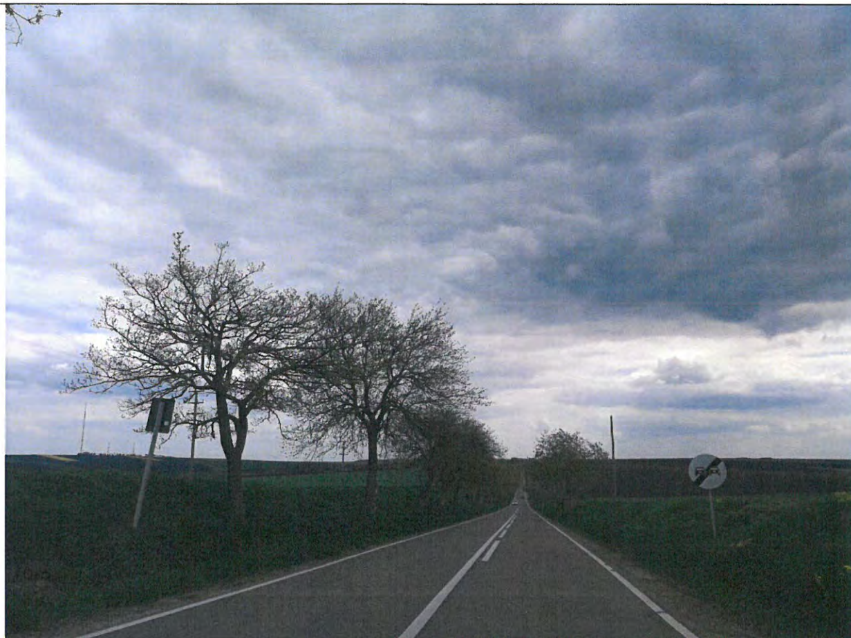
Foto 103: Drumul National DN 29, km 69+000 - 70+000 – Tronson caracterizat de usoare forme de valuriri si fagase.
