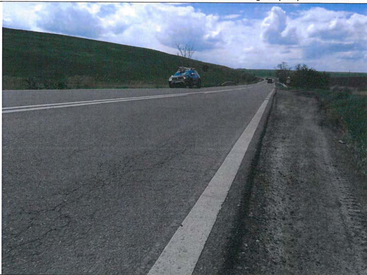
Foto 26: Drumul National DN 29, km 50+000 - 51+000— Fagase longitudinale pe zona de margine.
