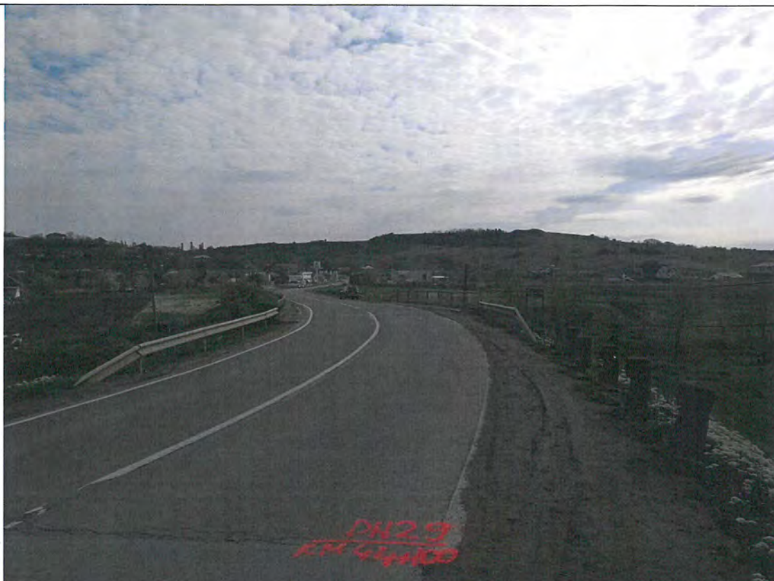
Foto 1: Drumul National DN 29, km 44+100 -45+000 – Inceput proiect DN 29 – Imbracaminte asfaltica cu fisuri longitudinale si transversale, acostamente denivelate care favorizeaza stagnarea apelor in zona drumului national.
