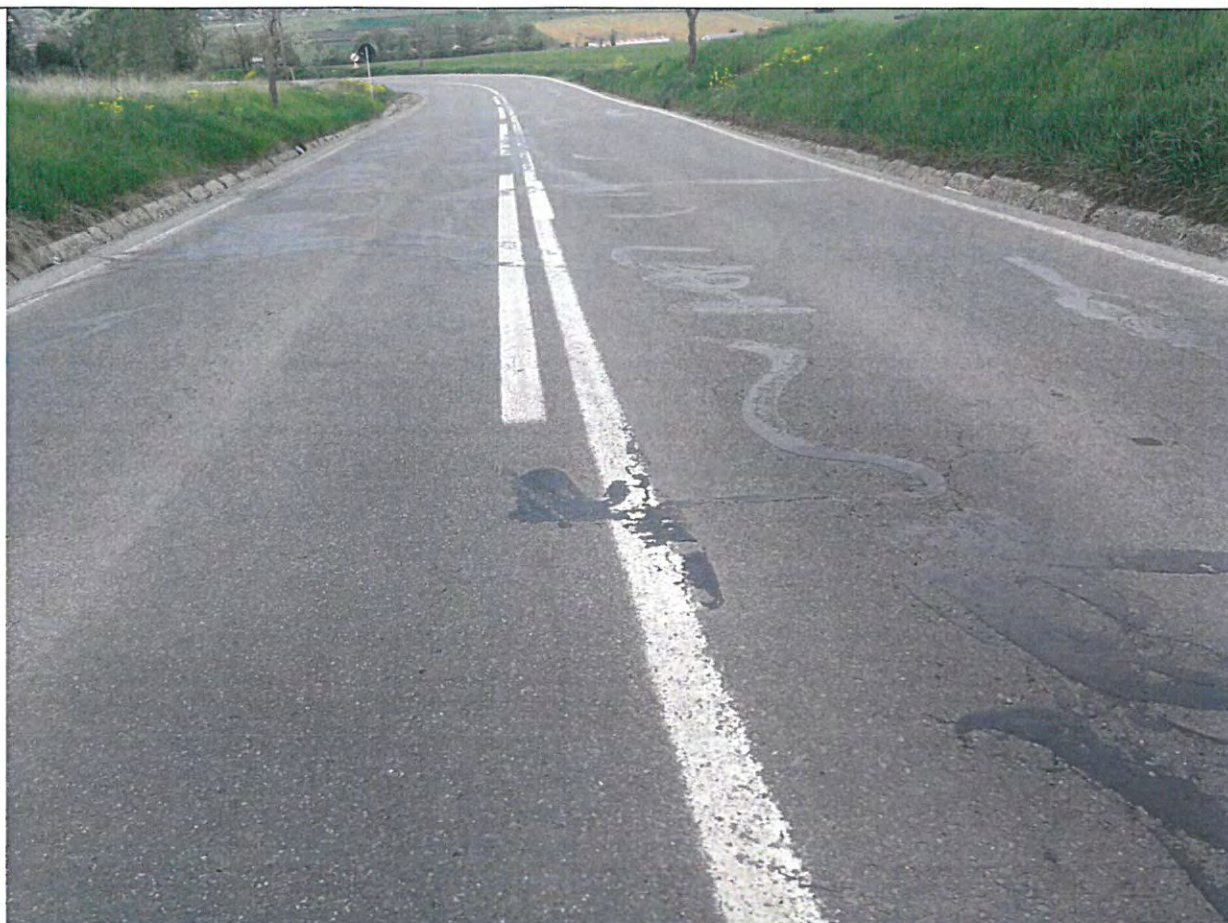
Foto 117: Drumul National DN 29, km 74+000 - 75+000 – Multiple fisuri la nivelul partii carosabile colmatate cu mastic bituminos. Fagase longitudinale pe zonele marginale. Usoare valuriri.
