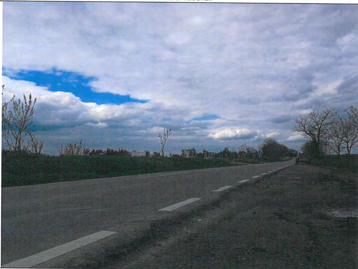
Foto 10: Drumul National DN 29, km 46+000 -47+000— Acostamente denivelate, rupturi de margine a mixturii asfaltice. Gropi la nivelul acostamentelor.
