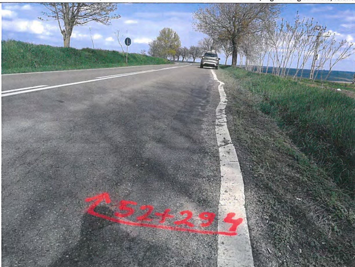
Foto 34: Drumul National DN 29, km 52+000 - 53+000 - Refulari de margine, fagase longitudinale.
