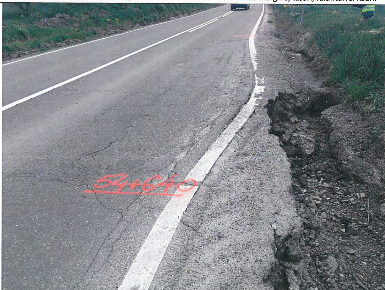
Foto 44: Drumul National DN 29, km 54+000 - 55+000 - Acostament cedat cu posibilitate de avansare spre zona mediana a drumului national. Refulari si tasari de margine.
