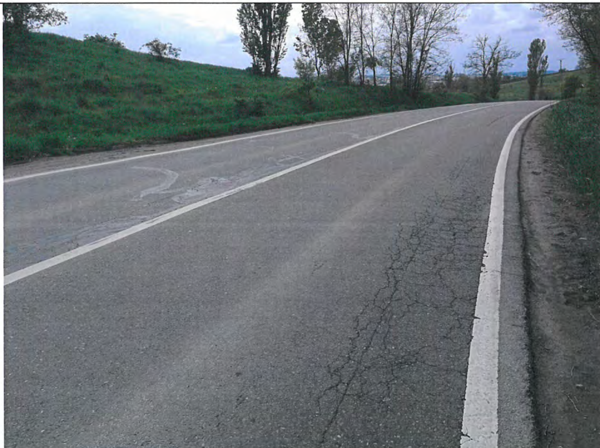
Foto 6: Drumul National DN 29, km 45+000 -46+000– Acostamente denivelate din pamant. Faientari marginale.
