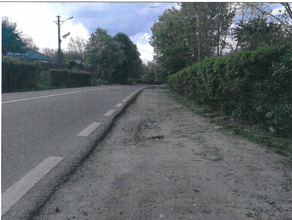
Foto 81: Drumul National DN 29, km 64+000 - 65+000 – Acostamente din pamant denivelate. Diferenta semnificativa de nivel intre partea carosabila si acostamente datorata turnarilor succesive de covoare asfaltice.
