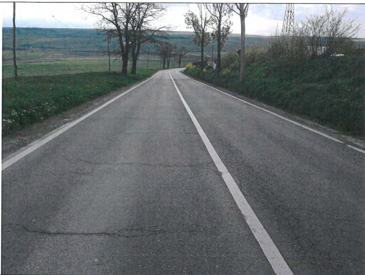
Foto 17: Drumul National DN 29, km 48+000 - 49+000— Multiple fisuri transversale pe banda stanga de circulatie. Faientari pe zona mediana si pe banda dreapta.
