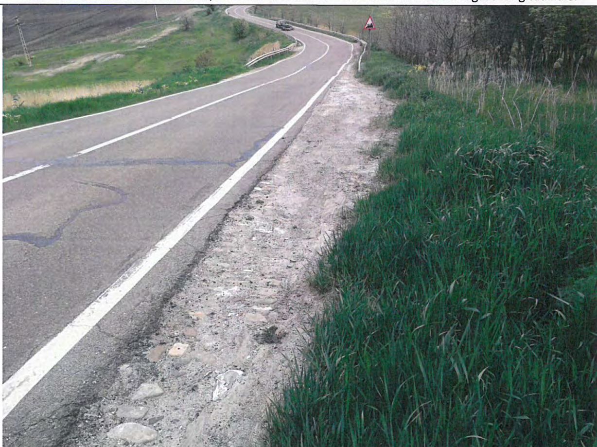
Foto 108: Drumul National DN 29, km 71+000 - 72+000 – Acostament pavat cu piatra. Taluze inierbate. Valuriri la nivelul partii carosabile.
