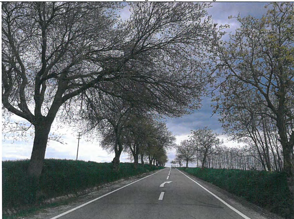
Foto 105: Drumul National DN 29, km 70+000 - 71+000 – Multiple fisuri la nivelul partii carosabile colmatate cu mastic bituminos. Fagase longitudinale pe zonele marginale. Usoare valuriri.
