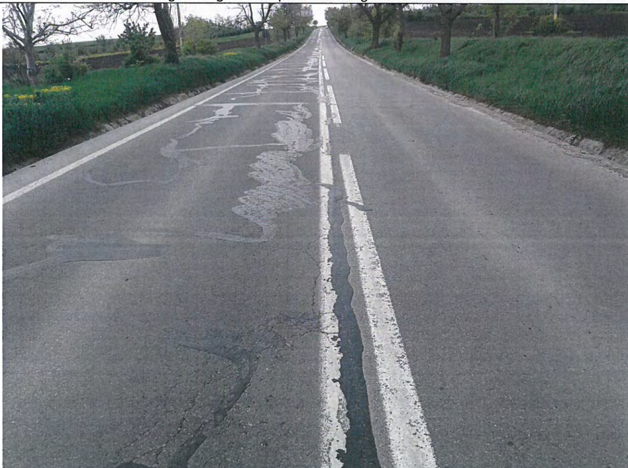
Foto 120: Drumul National DN 29, km 74+000 - 75+000 – Multiple fisuri la nivelul partii carosabile colmatate cu mastic bituminos. Fagase longitudinale pe zonele marginale. Usoare valuriri.
