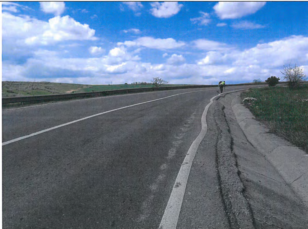
Foto 30: Drumul National DN 29, km 51+000 - 52+000 – Turnari succesive straturi asfaltice, refulari de margine, tasari longitudinale.
