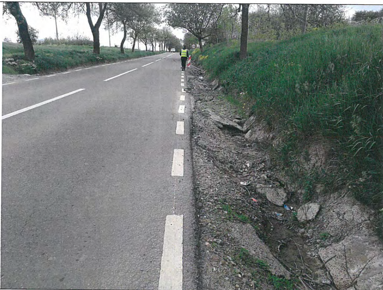
Foto 89: Drumul National DN 29, km 66+000 - 67+000 – Sisteme de colectare si evacuare a apelor si acostamente distruse.
