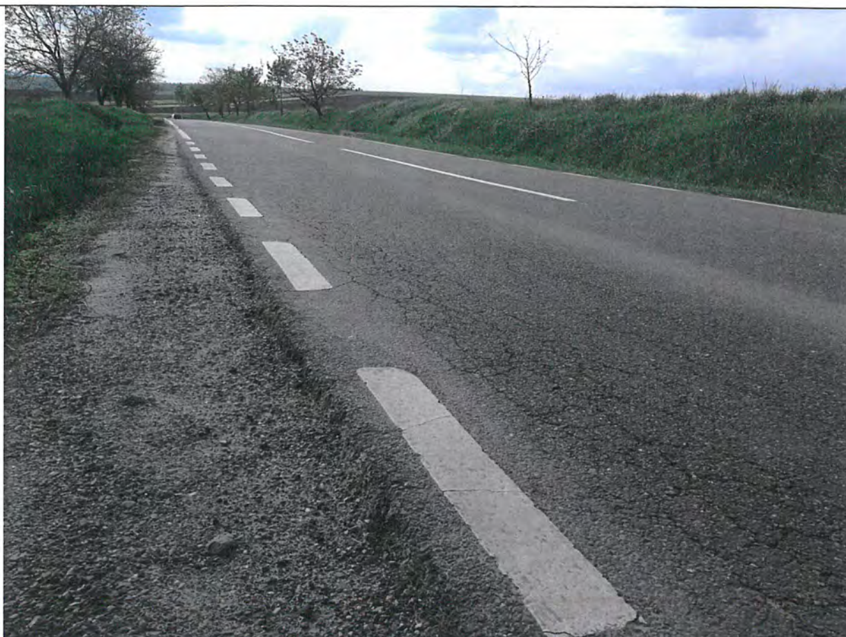
Foto 33: Drumul National DN 29, km 52+000 - 53+000 - Acostamente denivelate, fagase longitudinale, faiantari.
