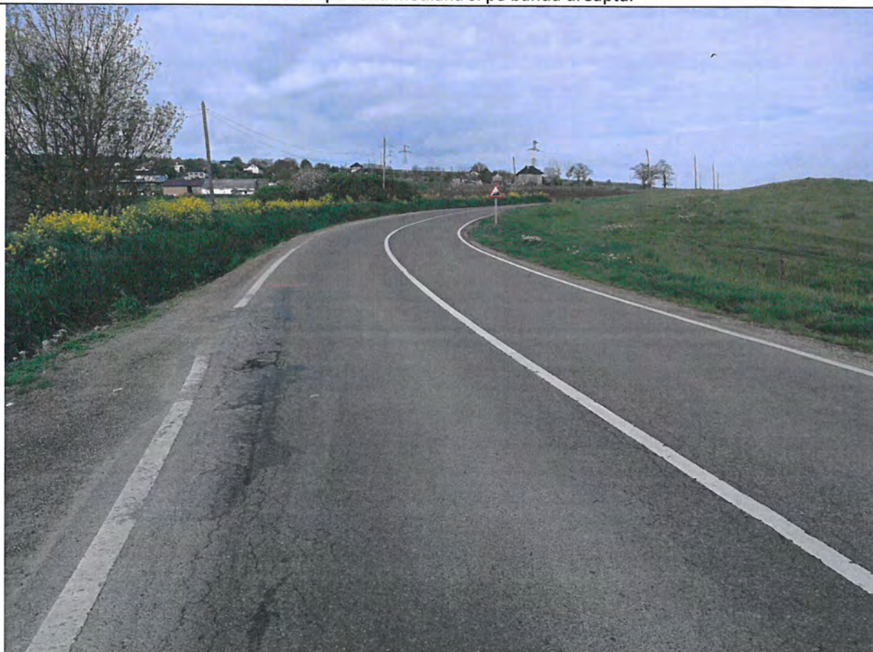
Foto 18: Drumul National DN 29, km 48+000 - 49+000— Refulari de margine, fisuri si faientari pe zona marginala. Tasari longitudinale.
