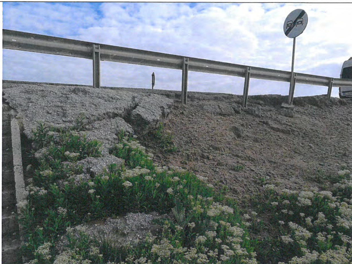
Foto 19: Drumul National DN 29, km 48+000 - 49+000– Terasamente cedate la nivelul rampelor de acces. Parapet metalic afectat de cedarea terasamentului.
