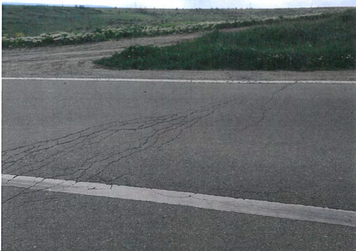
Foto 31: Drumul National DN 29, km 51+000 - 52+000 – Fisuri transversale, faiantari in panza de paianjen si in placi.
