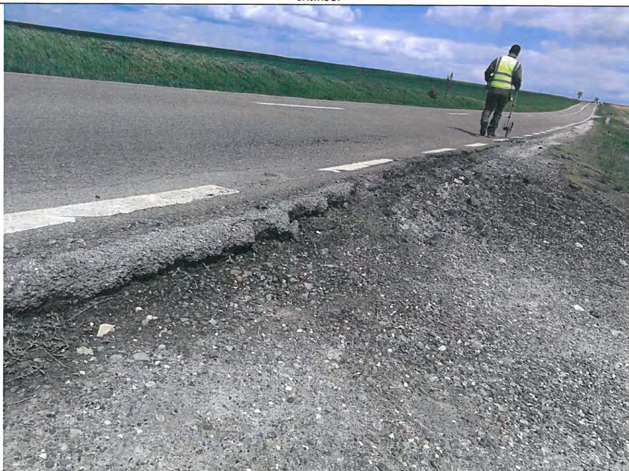
Foto 48: Drumul National DN 29, km 55+000 - 56+000 - Refulari si fagase marginale. Faientari pe suprafete extinse. Rupturi de margine.
