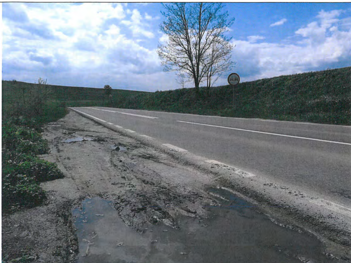
Foto 27: Drumul National DN 29, km 50+000 - 51+000– Acostamente distruse cu gropi de dimensiuni mari.
