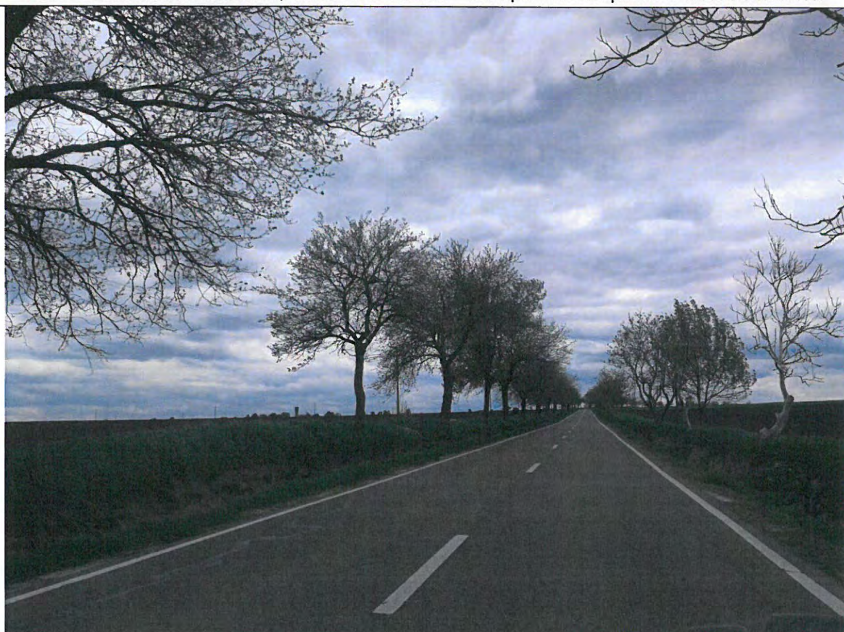
Foto 98: Drumul National DN 29, km 68+000 - 69+000 – Multiple fisuri acoperite cu mastic bituminos. Tronson caracterizat de usoare forme de valuriri si fagase.
