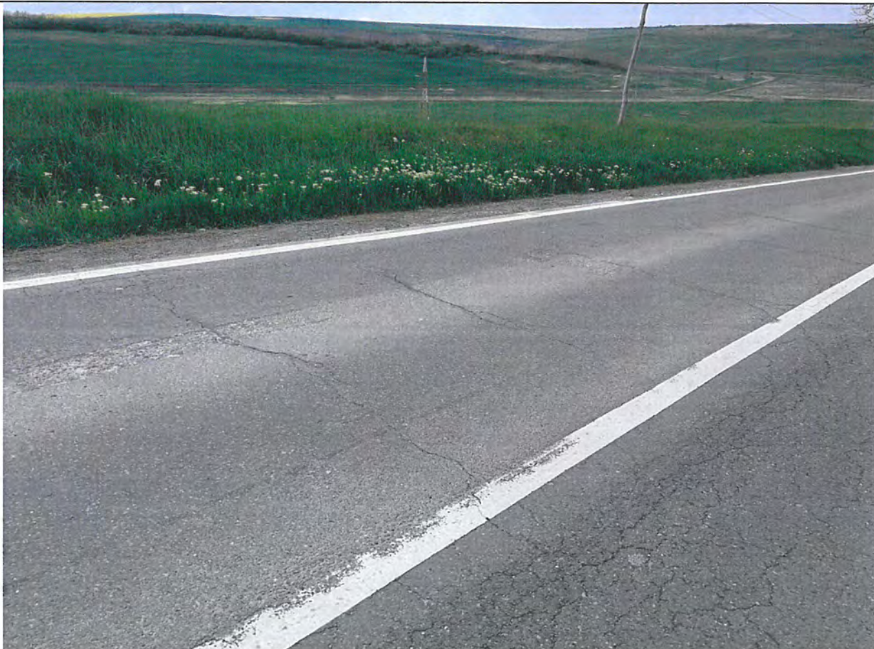
Foto 16: Drumul National DN 29, km 47+000 - 48+000— Fisuri transversale, faiantari pe zona mediana.
