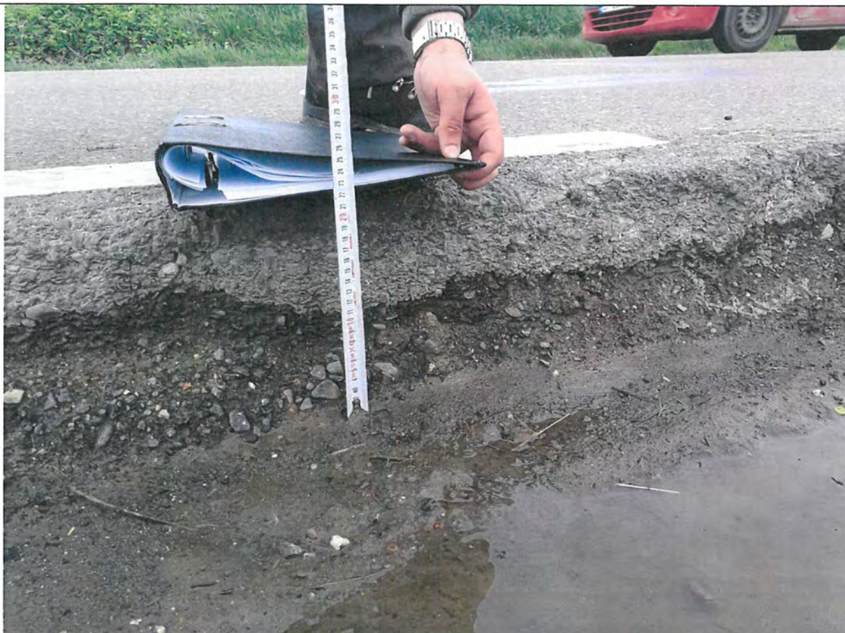
Foto 11: Drumul National DN 29, km 46+000 -47+000– Diferente semnificative (cca. 23cm) între partea carosabilă și acostament.
