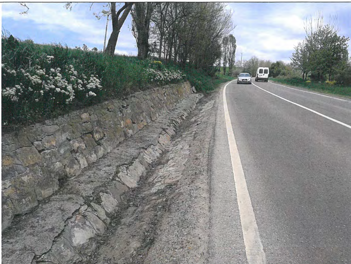
Foto 5: Drumul National DN 29, km 45+000 -46+000– Sant de debleu avand sectiunea pavata cu piatra. Cale de rulare aflata intr-o stare tehnica corespunzatoare.
