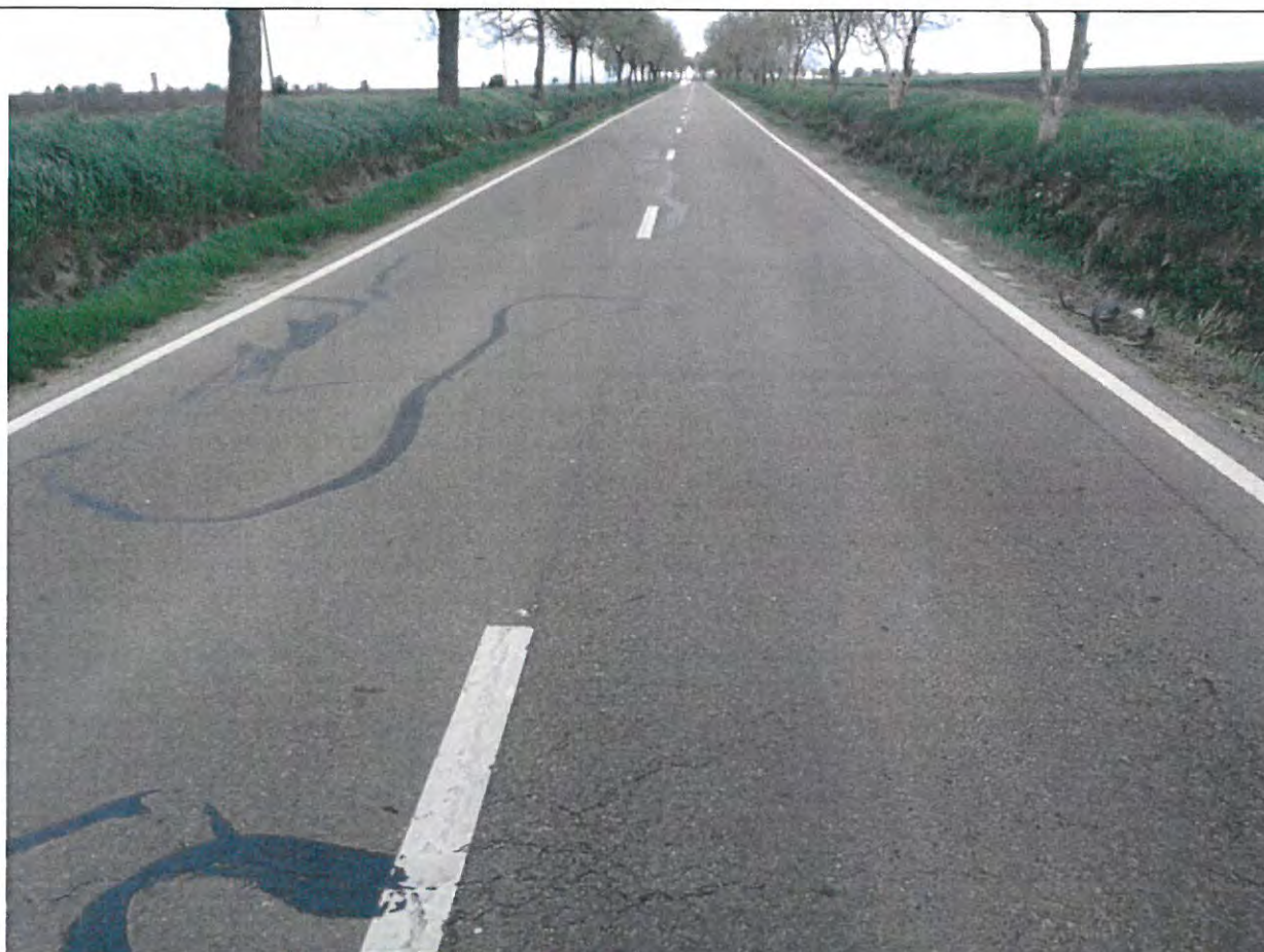
Foto 99: Drumul National DN 29, km 68+000 - 69+000 – Multiple fisuri acoperite cu mastic bituminos. Tronson caracterizat de usoare forme de valuriri si fagase.
