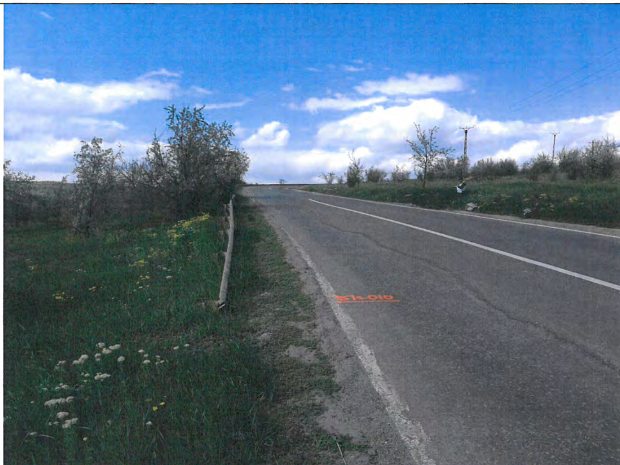
Foto 29: Drumul National DN 29, km 51+000 - 52+000 – Banda de circulatie stanga afectata in timp de cedari ale terasamentului de rambleu.
