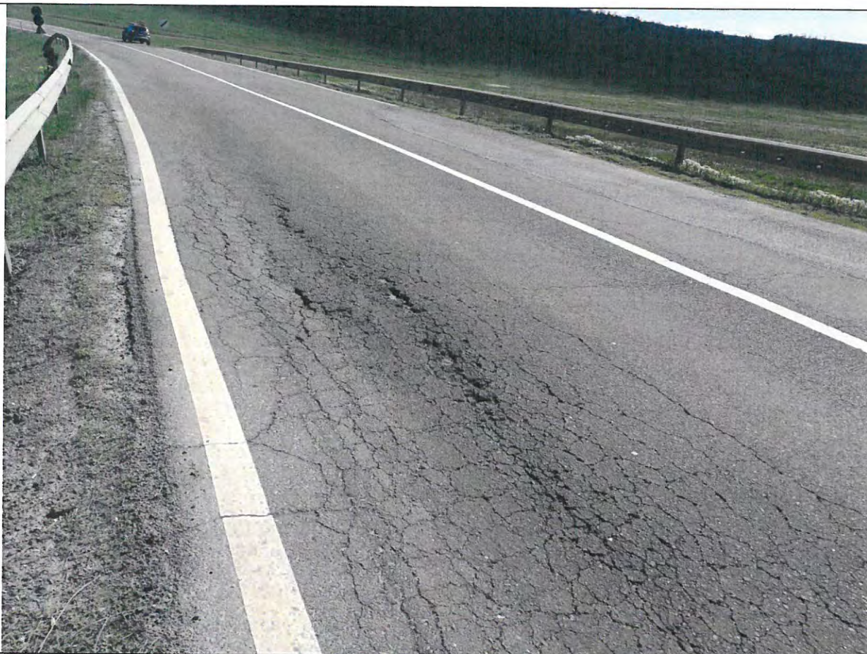
Foto 41: Drumul National DN 29, km 54+000 - 55+000 - Fagase longitudinale, faientari avansate, risc de aparitie a gropilor.
