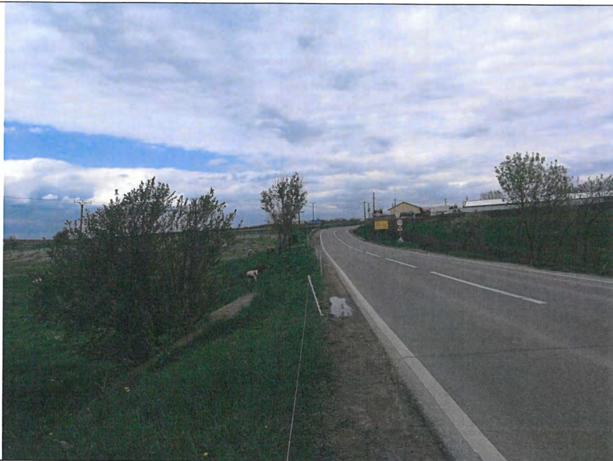
Foto 7: Drumul National DN 29, km 45+000 -46+000– Acostamente din pamant care favorizeaza stagnarea si infiltrarea apelor in corpul drumului national. Taluz de rambleu inierbat.
