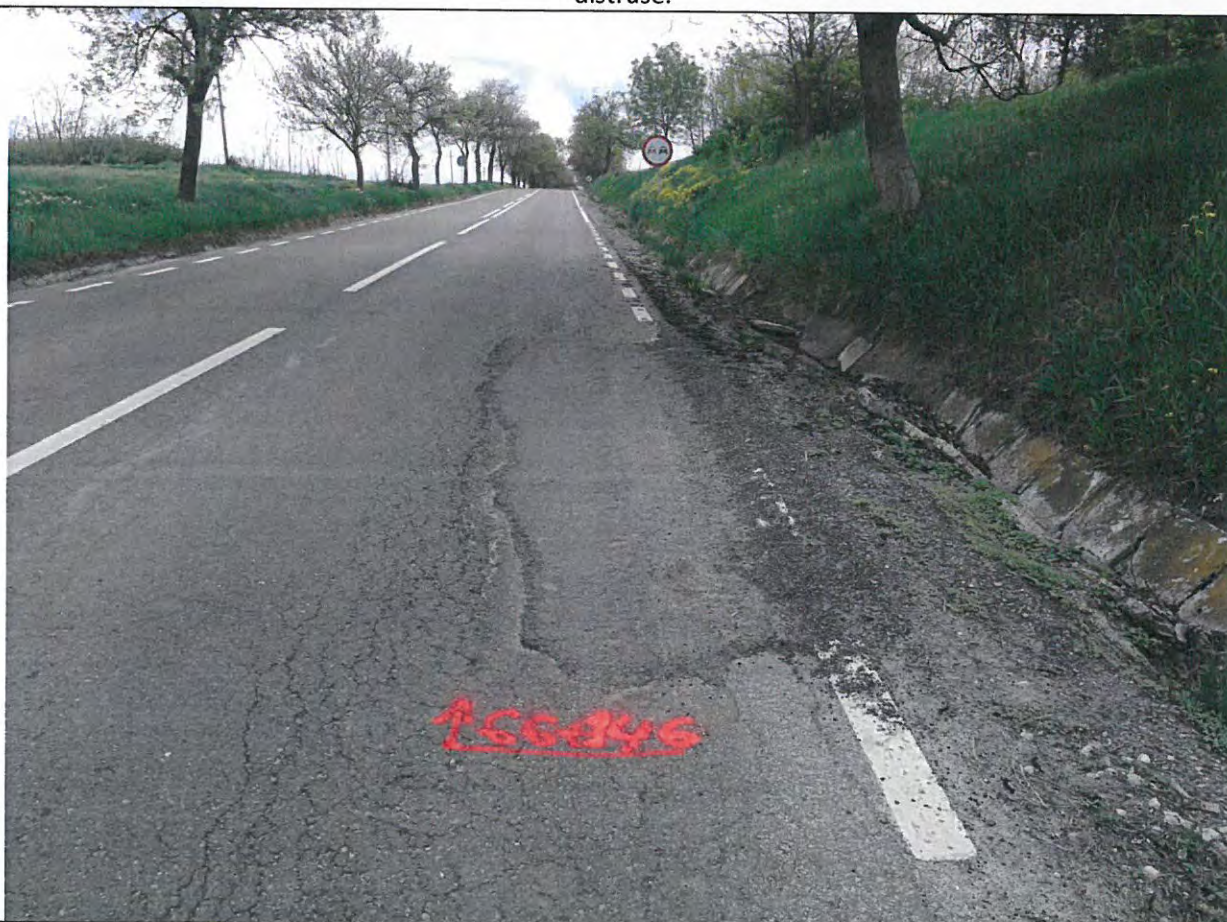
Foto 90: Drumul National DN 29, km 66+000 - 67+000 – Sisteme de colectare si evacuare a apelor si acostamente distruse. Faiantari si plombări la nivelul partii carosabile.
