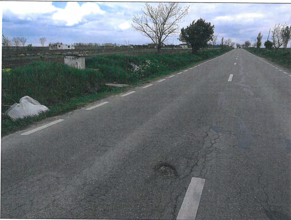
Foto 9: Drumul National DN 29, km 46+000 -47+000— Fisuri longitudinale, gropi si faiantari pe zona mediana a drumului national.
