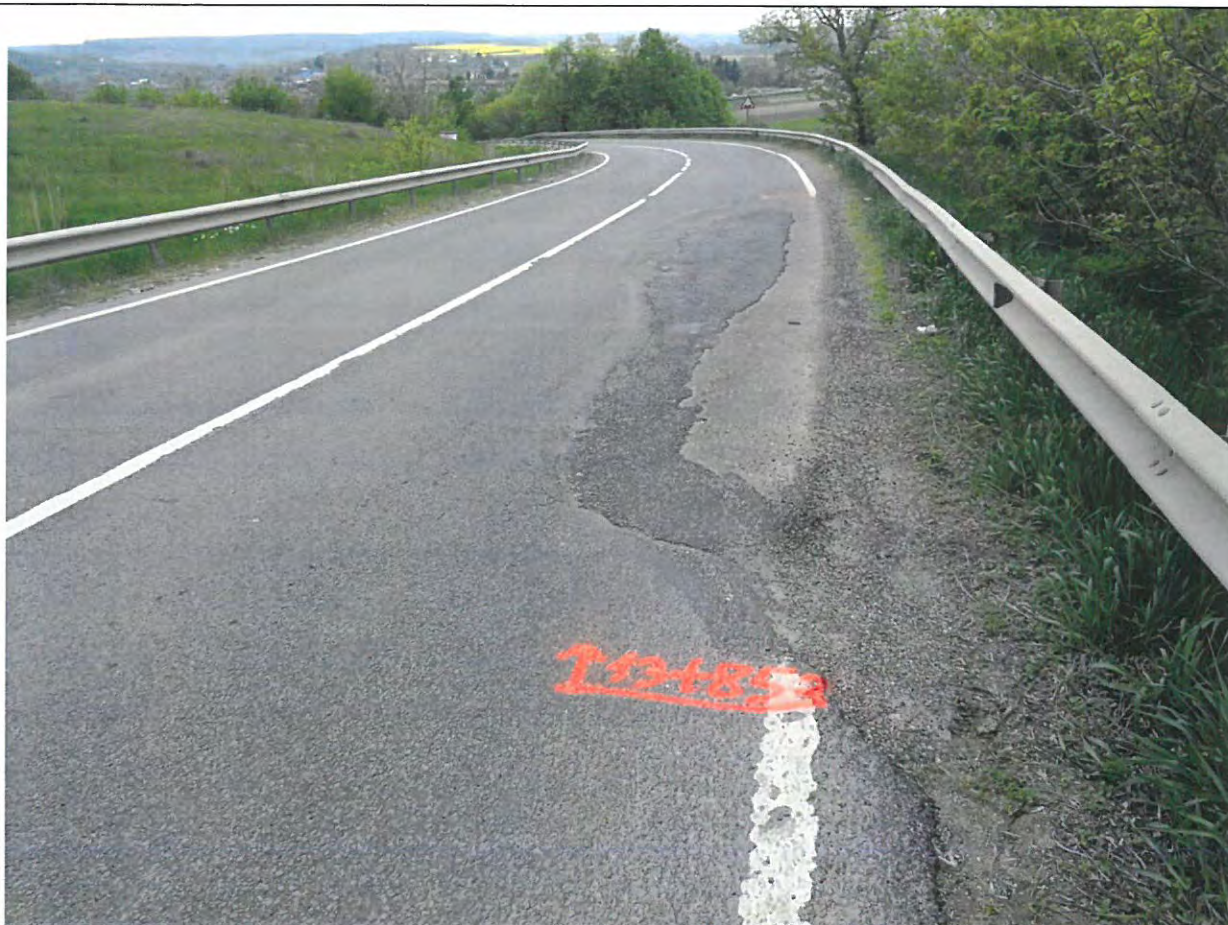
Foto 31: Drumul National DN 29B, km 13+000 -14+000 – Desprindere mixtura asfaltica.
