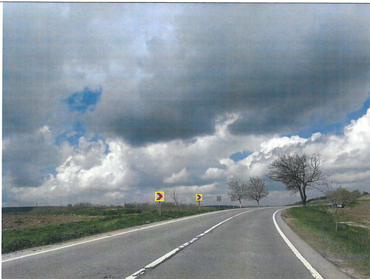
Foto 49: Drumul National DN 29B, km 18+000 -19+000 – Fisuri longitudinale colmate cu mastic bituminos.
