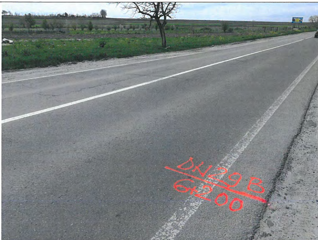
Foto 1: Drumul National DN 29B, km 6+200 -7+000 – Inceput proiect DN 29B – Imbracaminte asfaltica cu fisuri longitudinale si transversale, acostamente denivelate care favorizeaza stagnarea apelor in zona drumului national.
