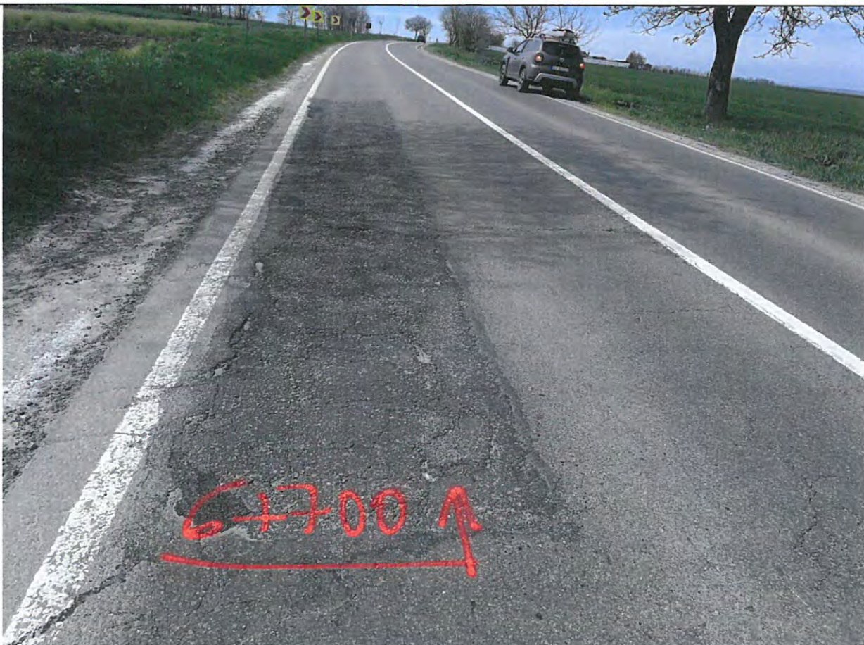
Foto 4: Drumul National DN 29B, km 6+200 -7+000 – Lucrari de reparatii locale prin plombari marginale, lipsa sistemelor de colectare si evacuare a apelor pe zona de debleu.
