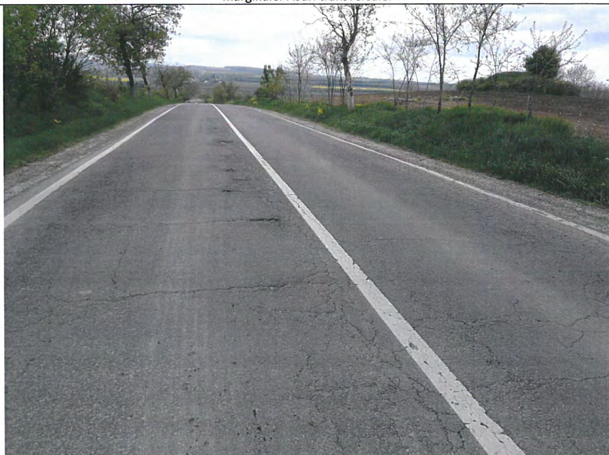
Foto 30: Drumul National DN 29B, km 13+000 -14+000 – Multiple gropi si fisuri. Fagase longitudinale marginale.
