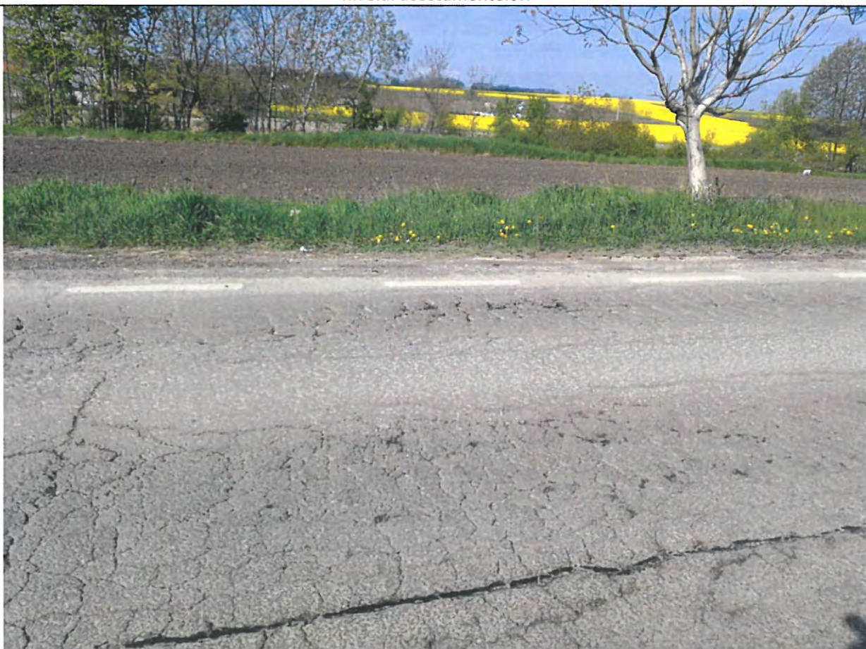
Foto 38: Drumul National DN 29B, km 15+000 -16+000 . Faiantari pe suprafete extinse, fagase marginale.
