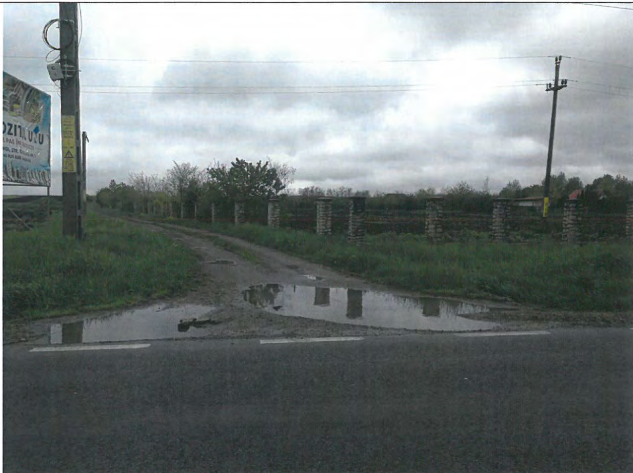
Foto 93: Drumul National DN 29B, km 29+000 -30+000 – Intersectie cu drum local neamenajata. Apele stagneaza la nivelul drumului local.
