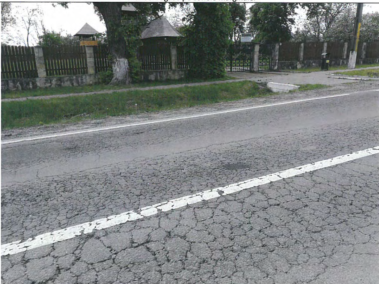
Foto 64: Drumul National DN 29B, km 21+000 -22+000 – Faientari pronuntate pe suprafete extinse.
