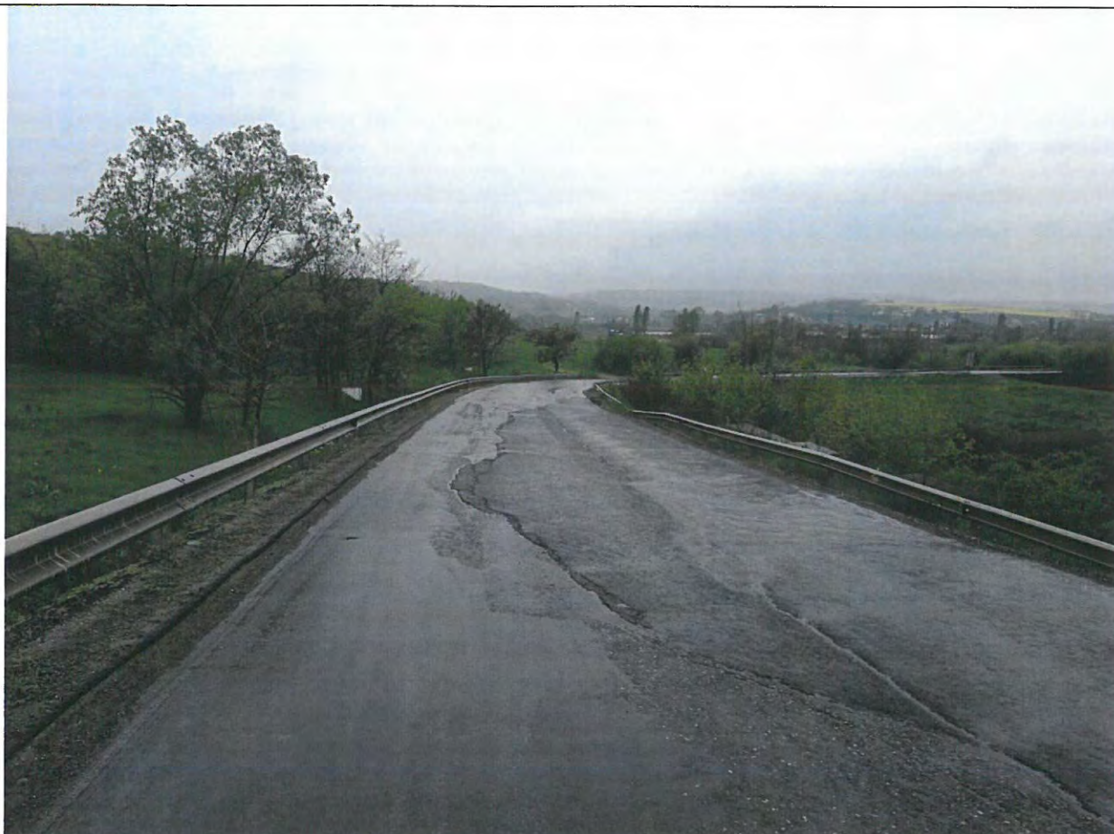
Foto 33: Drumul National DN 29B, km 14+000 -15+000 – Sector de drum caracterizat de tasari si denivelari accentuate cu potential de cedare a drumului national.
