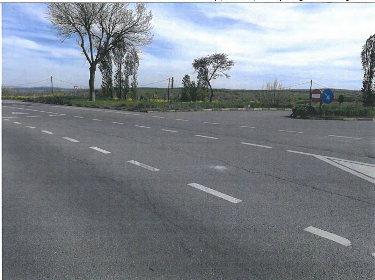
Foto 18: Drumul National DN 29B, km 10+000 -11+000 – Intersectie DN 29B – DN 29C stanga. Fisuri longitudinale la nivelul partii carosabile.
