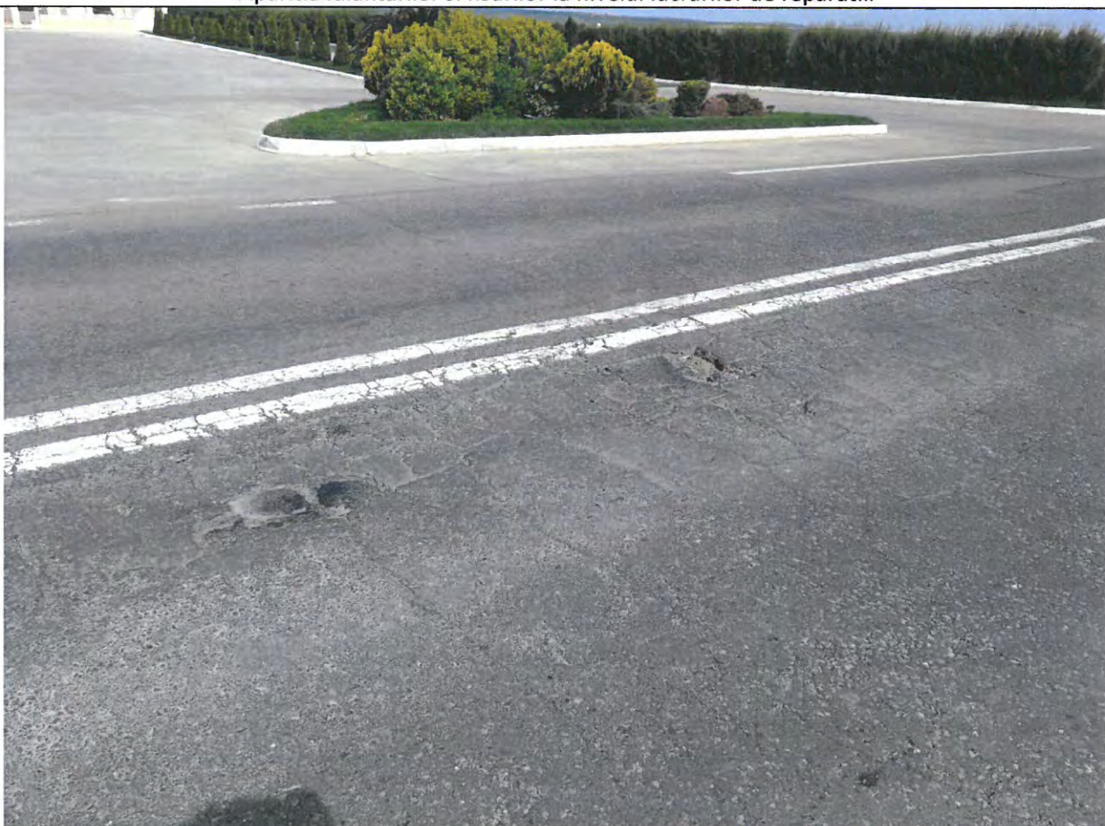
Foto 14: Drumul National DN 29B, km 9+000 -10+000 – Gropi pe zona mediana, multiple fisuri longitudinale si transversale.
