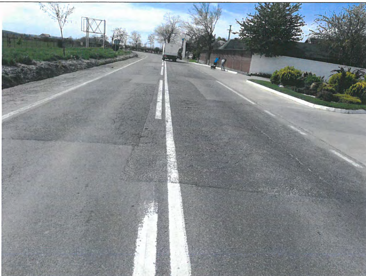
Foto 13: Drumul National DN 29B, km 9+000 -10+000 – Lucrari de reparatii pe zone extinse prin plombari. Aparitia faiantarilor si fisurilor la nivelul lucrarilor de reparatii.
