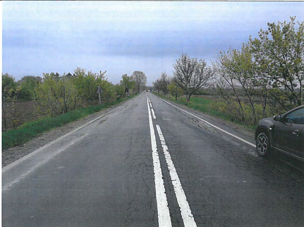
Foto 36: Drumul National DN 29B, km 14+000 -15+000 – Fagase longitudinale pe zonele marginale. Faiantari pe suprafete extinse.
