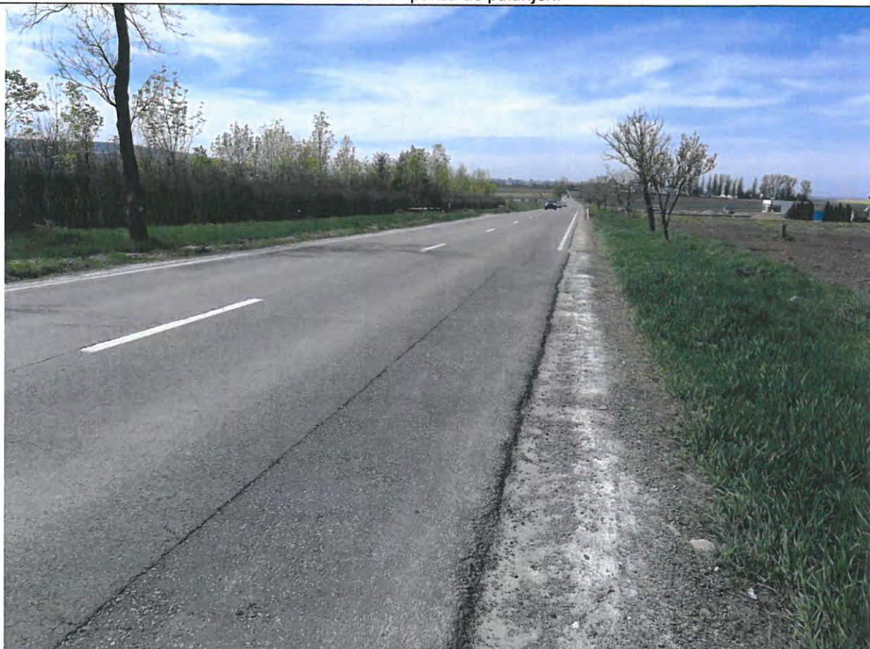
Foto 10: Drumul National DN 29B, km 8+000 -9+000 – Acostamente denivelate, lucrari de plombari marginale, santuri complet inierbate.
