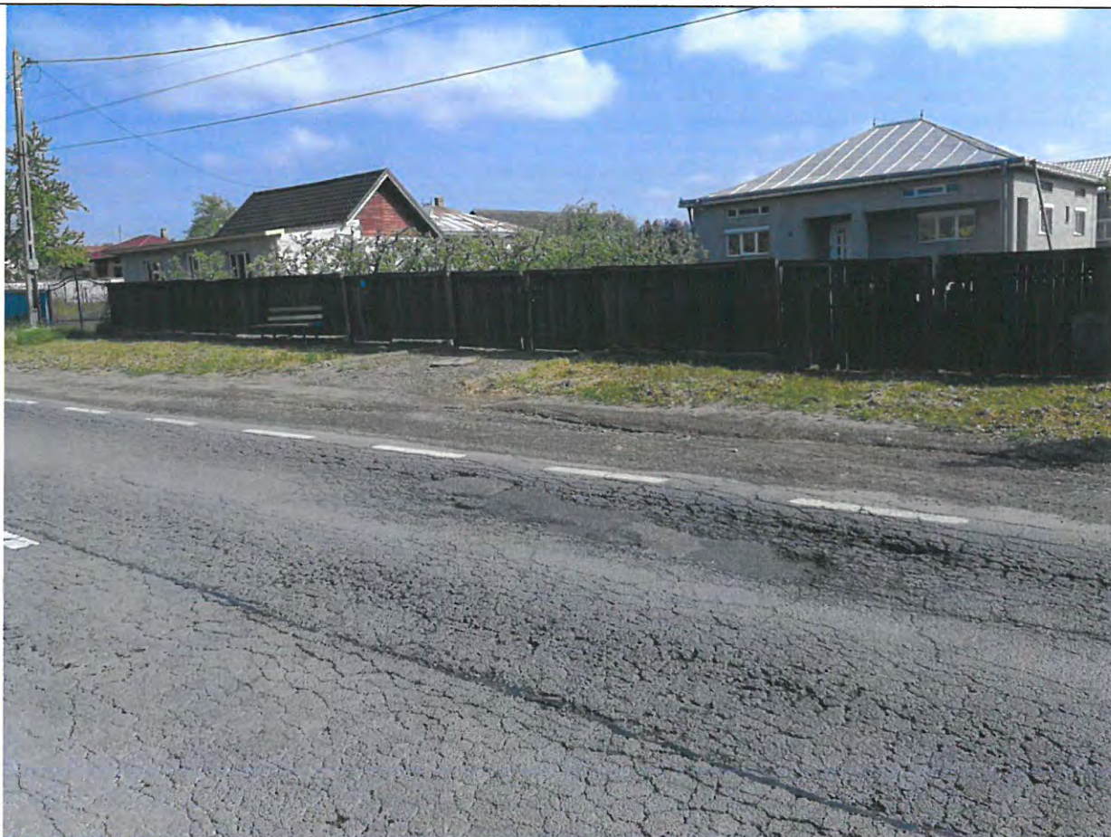
Foto 39: Drumul National DN 29B, km 15+000 -16+000 – Faientari pe suprafete extinse, fagase avansate pe zonele marginale.
