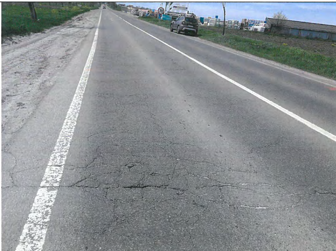
Foto 2: Drumul National DN 29B, km 6+200 -7+000 – Fisuri transversale si longitudinale. Faientari in placi, acostamente din pamant denivelate si degradare. Santuri din pamant cu vegetatie abundenta.
