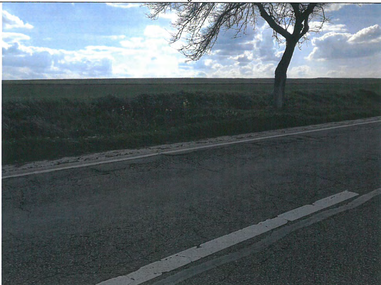
Foto 70: Drumul National DN 29B, km 23+000 -24+000 – Faientari pe zone extinse, fagase longitudinale marginale.
