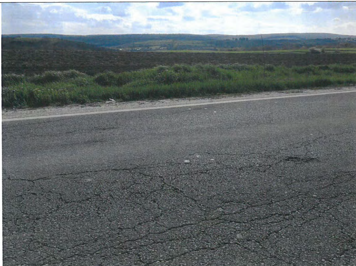
Foto 74: Drumul National DN 29B, km 24+000 -25+000 – Fisuri longitudinale si transversale.
