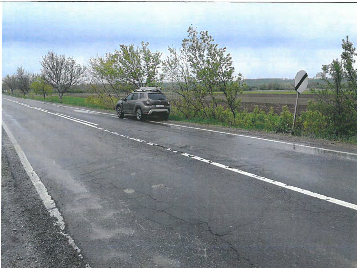
Foto 35: Drumul National DN 29B, km 14+000 -15+000 – Fisuri, gropi si faiantari la nivelul partii carosabile.
