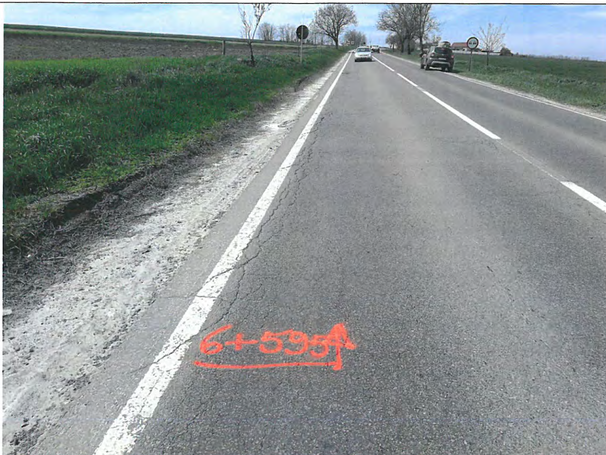
Foto 3: Drumul National DN 29B, km 6+200 -7+000 – Fisuri transversale longitudinale pe zonele marginale. Faientari in panaza de paianjen. Santuri inierbate .
