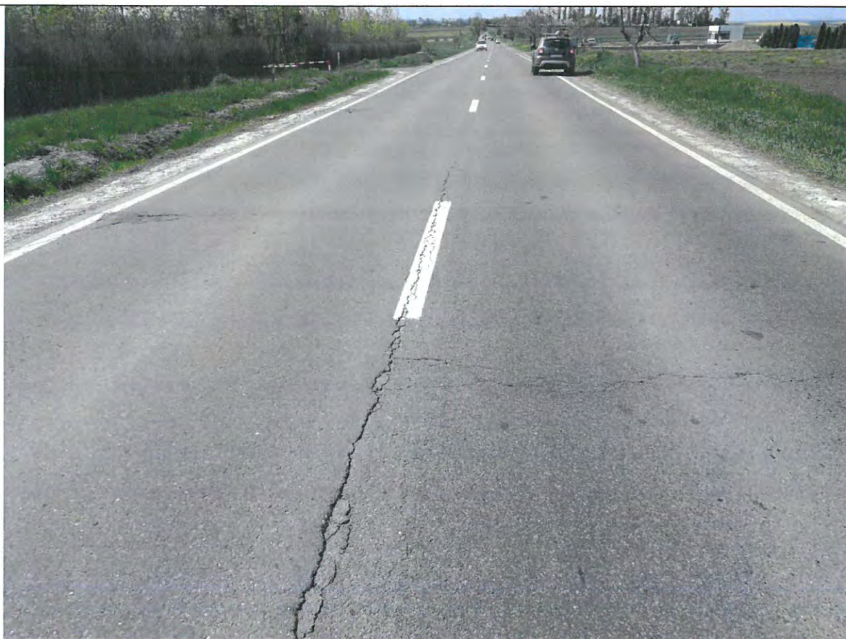
Foto 11: Drumul National DN 29B, km 8+000 -9+000 – Fisuri longitudinale pe zona mediana. Fisuri transversale.
