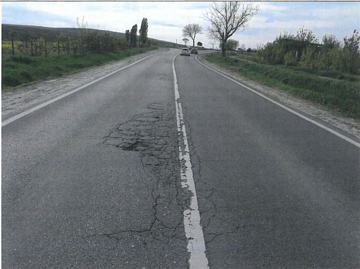
Foto 17: Drumul National DN 29B, km 10+000 -11+000 –Gropi, fainatari, marcaje longitudinale degradate.
