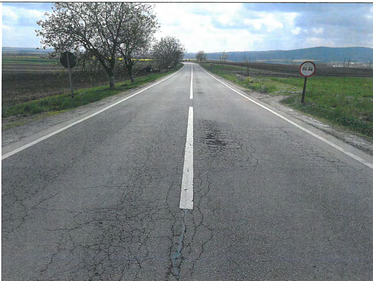
Foto 51: Drumul National DN 29B, km 18+000 -19+000 – Faientari in panza de paianjen si in placi, gropi pe zona mediana.
