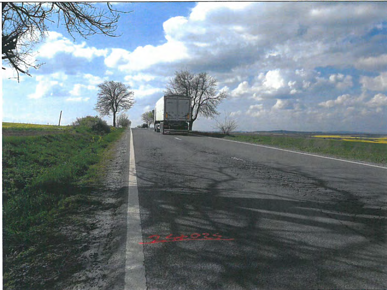
Foto 73: Drumul National DN 29B, km 24+000 -25+000 – Tasari locale, faiantari pe suprafete extinse.
