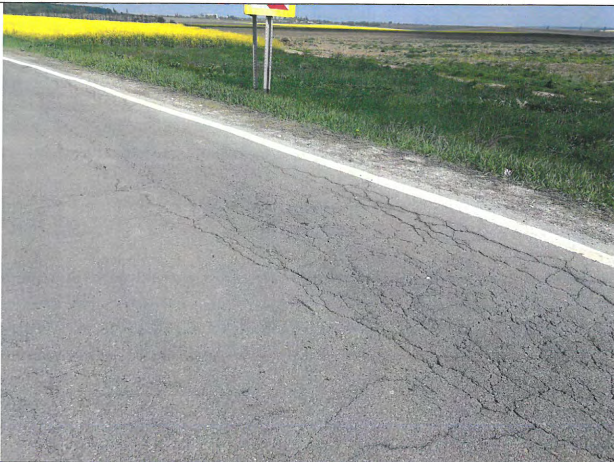
Foto 45: Drumul National DN 29B, km 17+000 -18+000 – Faientari, acostamente din pamant denivelate.
