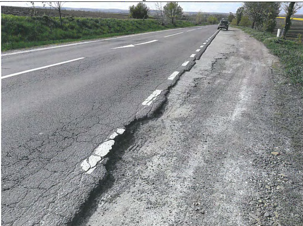
Foto 20: Drumul National DN 29B, km 10+000 -11+000 – Rupturi ale mixturii asfaltice in zona acostamentelor.
