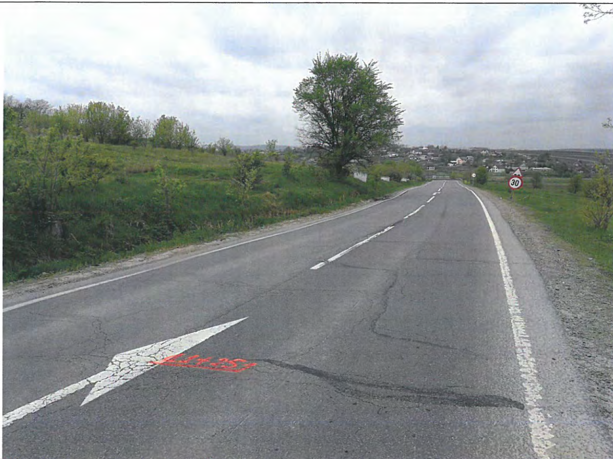
Foto 21: Drumul National DN 29B, km 11+000 -12+000 – Colmatare fisuri cu mastic bituminos. Faientari. Sector de drum caracterizat de numeroase denivelari la nivelul partii carosabile.
