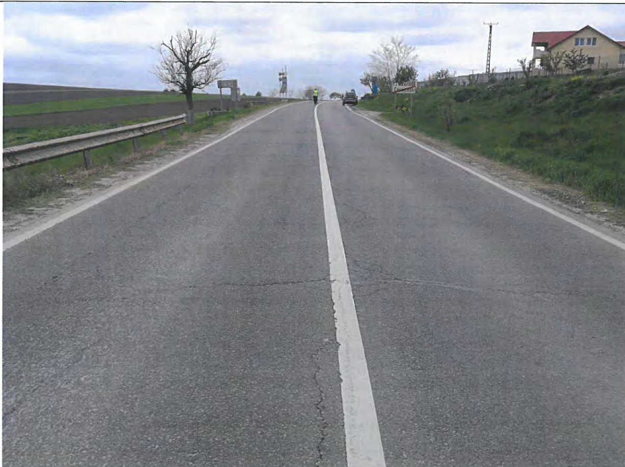
Foto 26: Drumul National DN 29B, km 12+000 -13+000 – Fisuri longitudinale si transversale.
