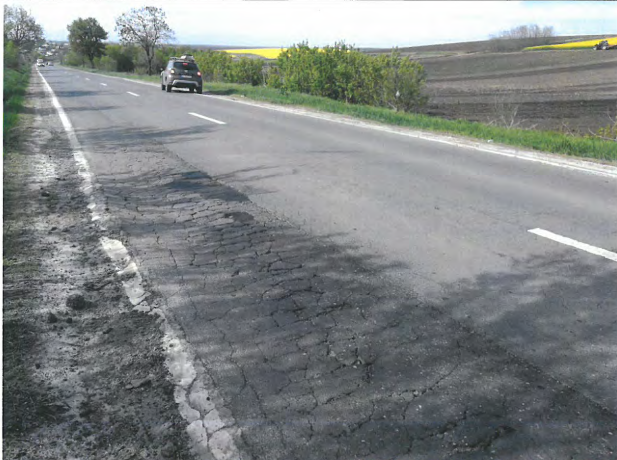
Foto 19: Drumul National DN 29B, km 10+000 -11+000 – Faientari marginale pe zone extinse, fagase si refulari longitudinale.
