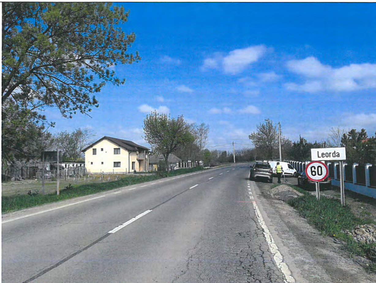
Foto 37: Drumul National DN 29B, km 15+000 -16+000 – Intrare in localitatea Leorda. Faiantari pronuntate la nivelul acostamentelor.
