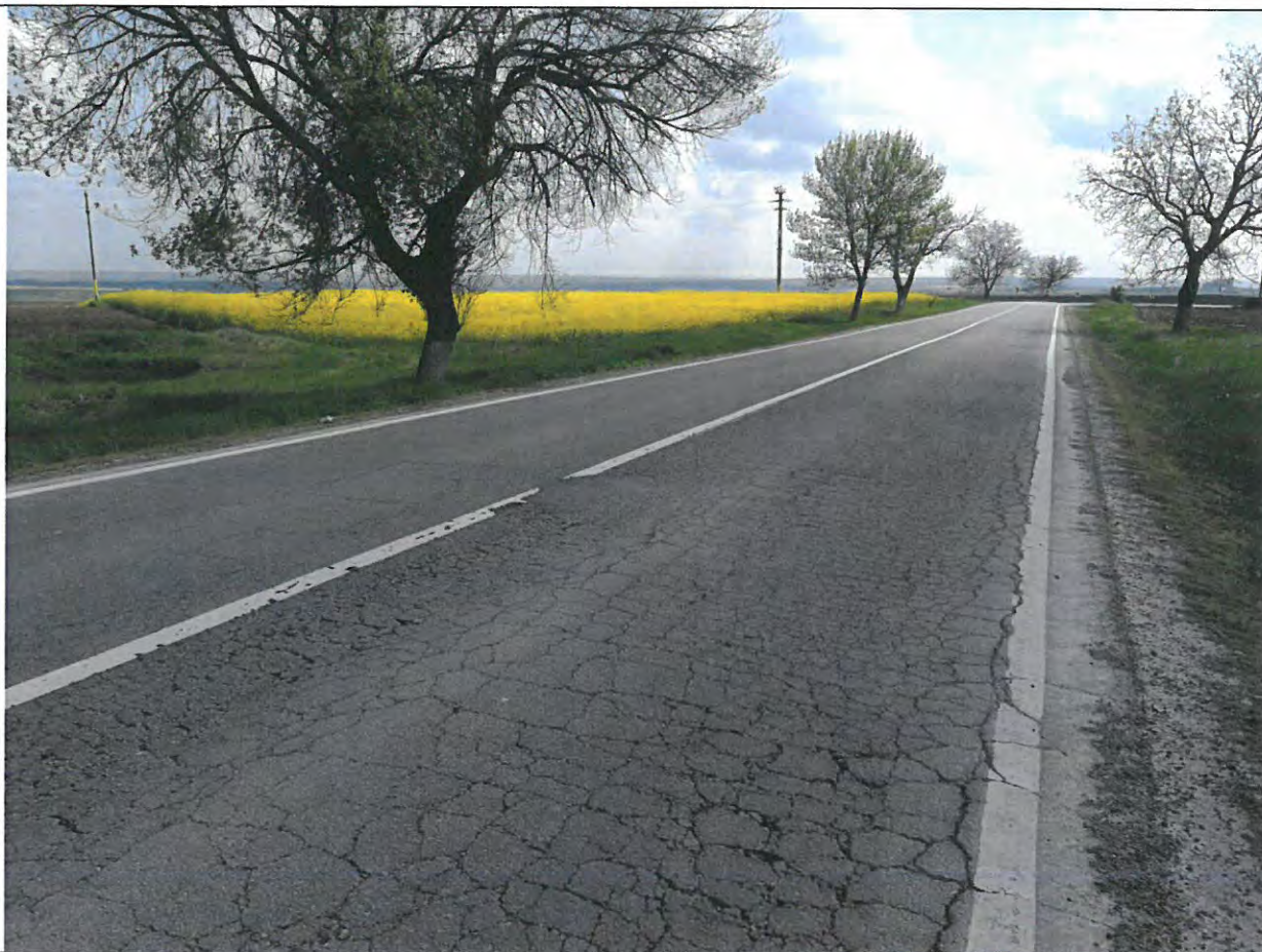
Foto 47: Drumul National DN 29B, km 17+000 -18+000 – Faiantari pe zone extinse, fagase longitudinale.
