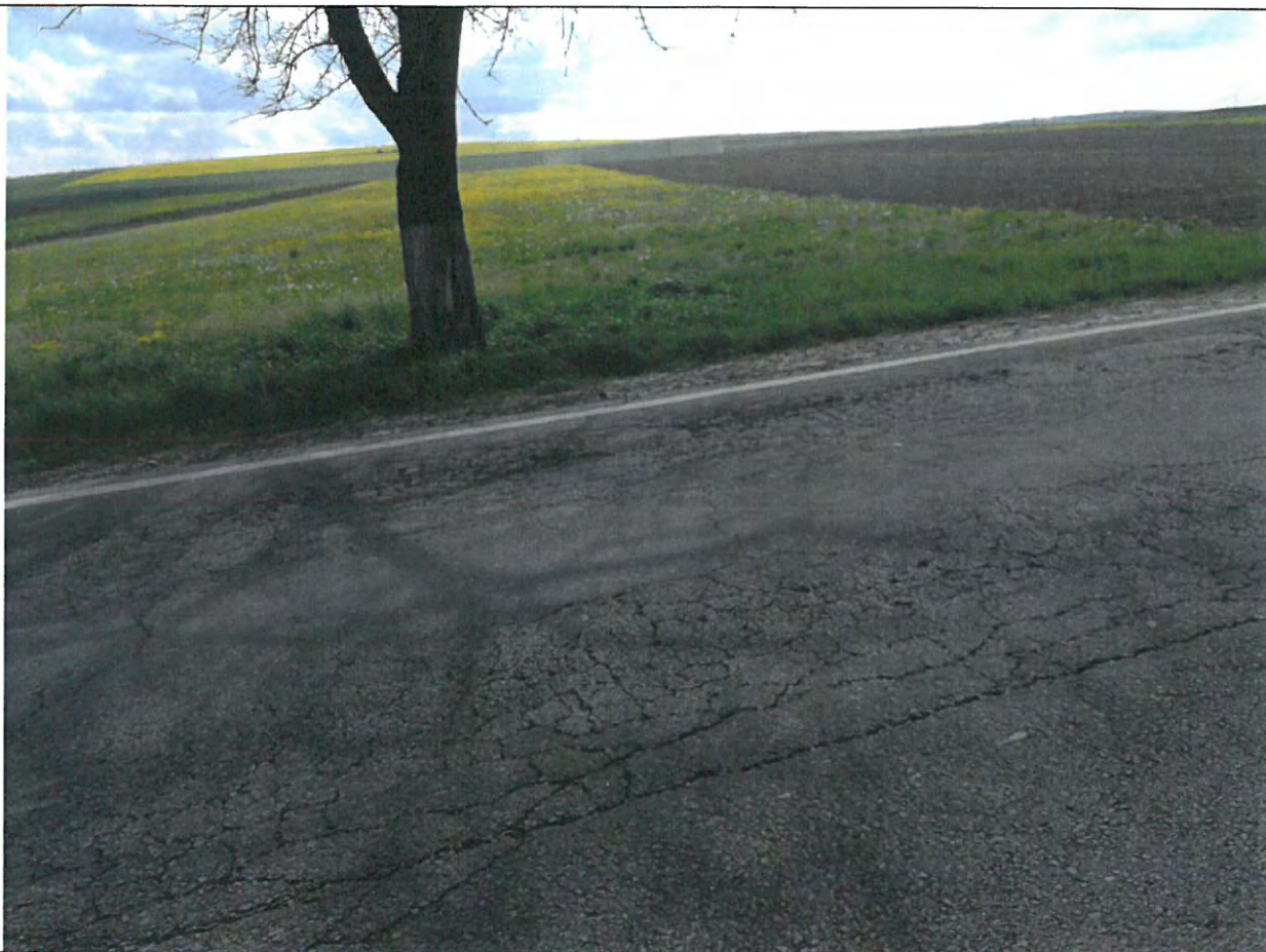
Foto 69: Drumul National DN 29B, km 23+000 -24+000 – Faientari pe zone extinse, fagase longitudinale marginale.
