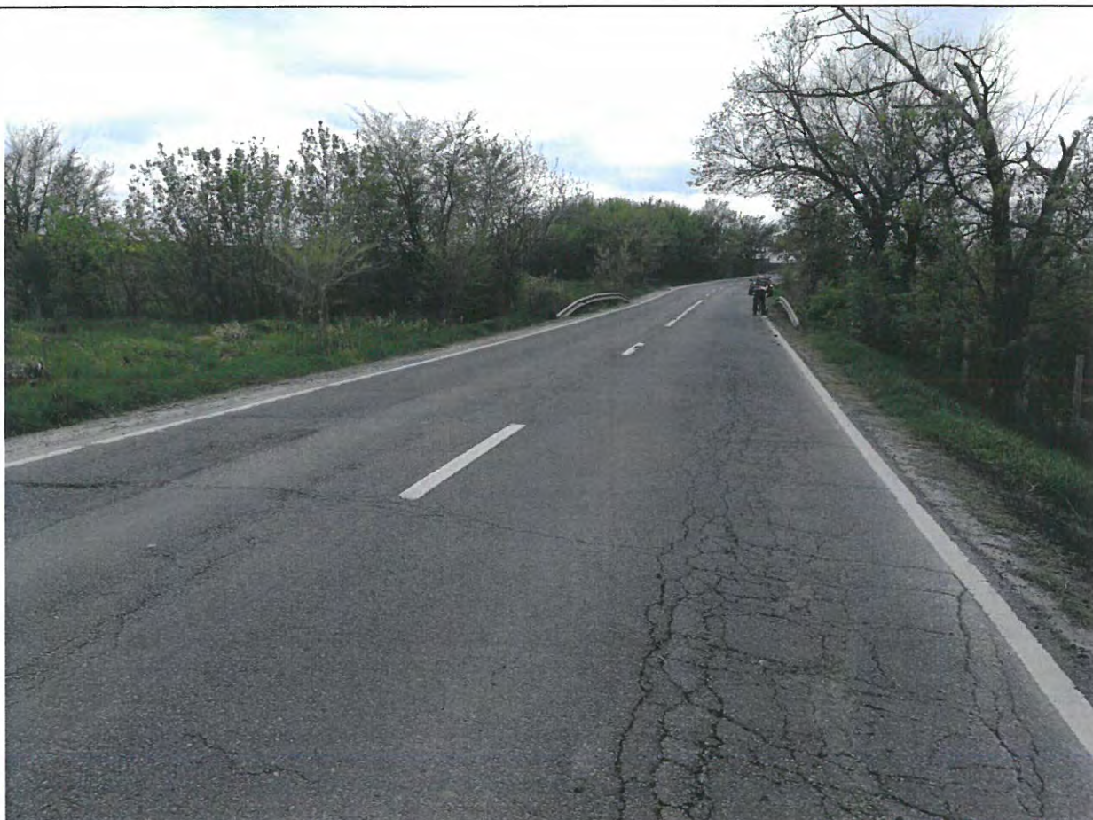
Foto 29: Drumul National DN 29B, km 13+000 -14+000 – Faientari in panza de paianjen sin in placi pe zonele marginale. Fisuri transversale.
