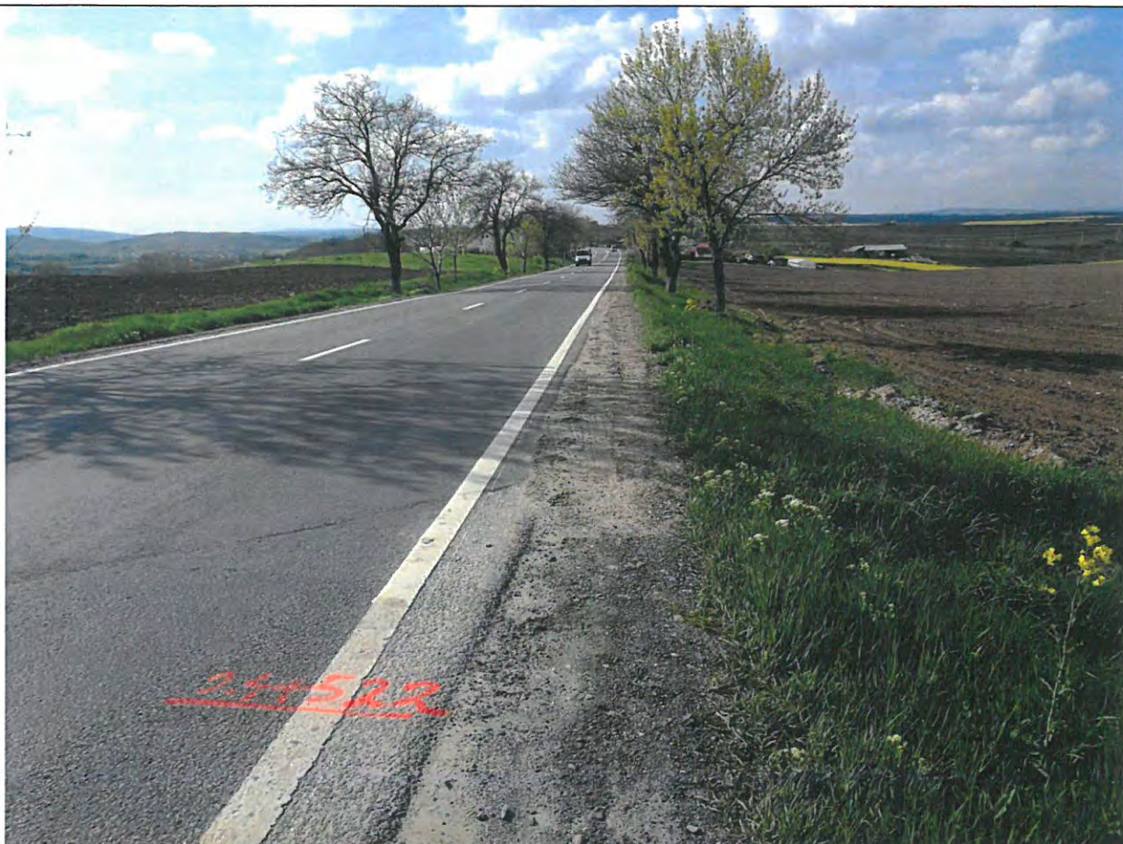
Foto 75: Drumul National DN 29B, km 24+000 -25+000 – Rupturi ale stratului de rulare pe zona acostamentului.
