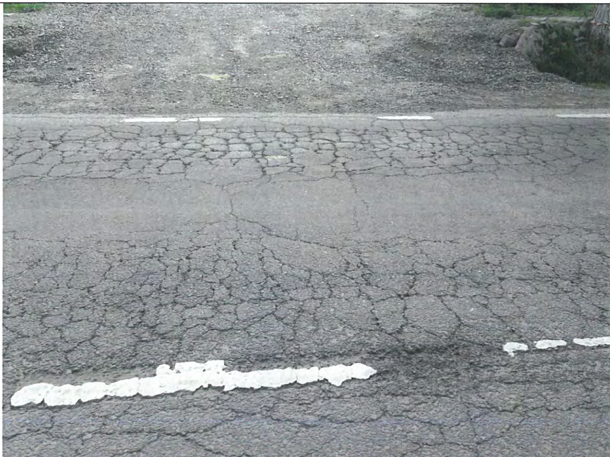
Foto 65: Drumul National DN 29B, km 22+000 -23+000 – Faiantari pronuntate pe suprafete extinse. Fagase longitudinale.
