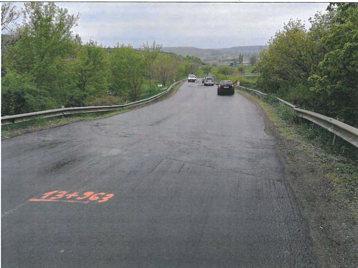
Foto 32: Drumul National DN 29B, km 13+000 -14+000 – Sector de drum caracterizat de tasari si denivelari accentuate cu potential de cedare a drumului national.
