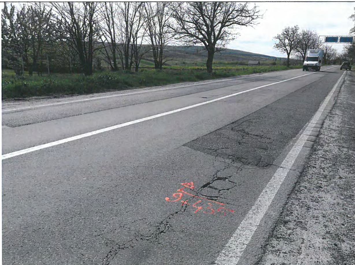
Foto 16: Drumul National DN 29B, km 9+000 -10+000 – Fagase longitudinale pe zona marginala, crapaturi si fisuri.
