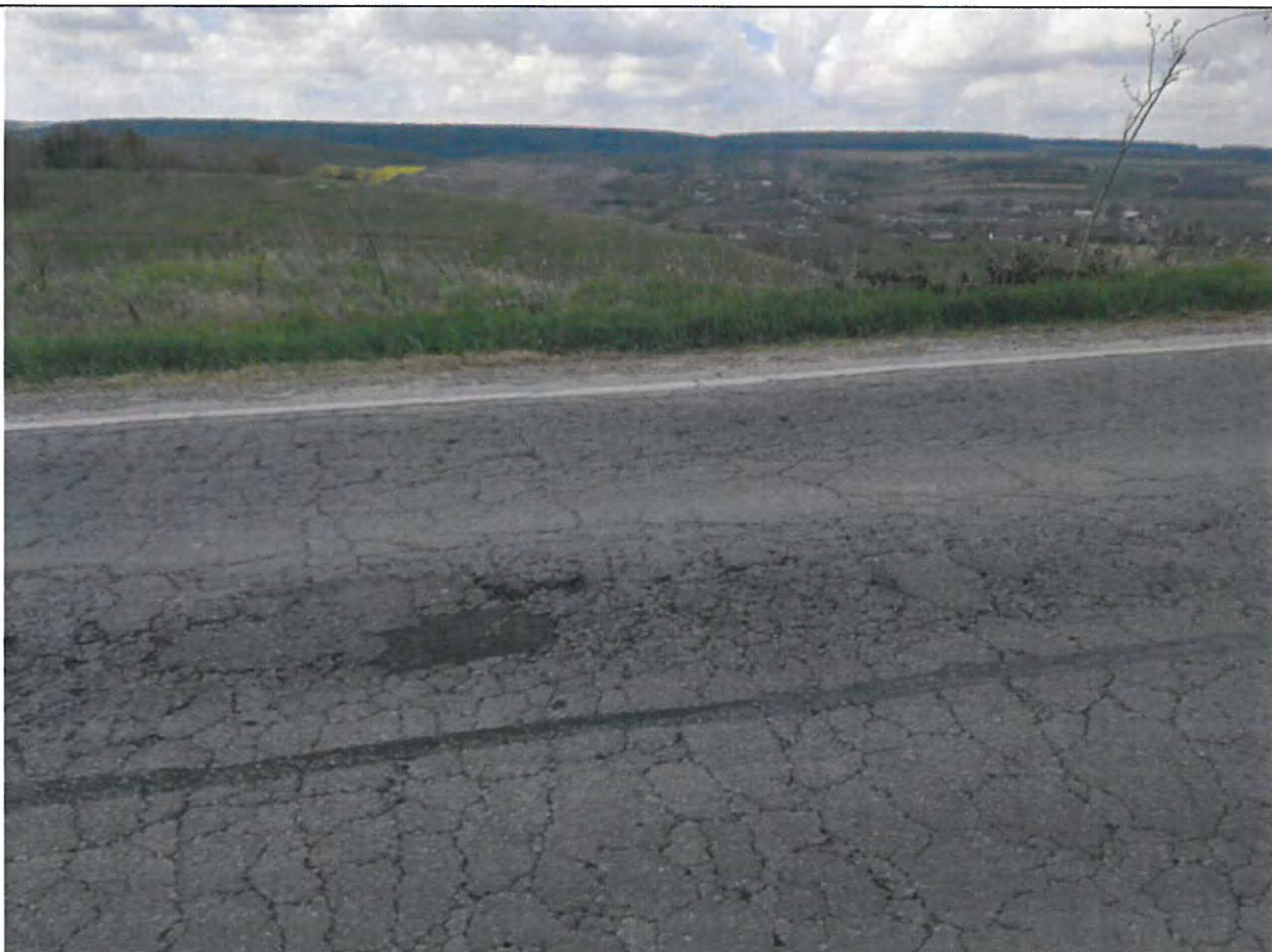
Foto 52: Drumul National DN 29B, km 18+000 -19+000 – Faientari pe suprafete extinse, fagase longitudinale.
