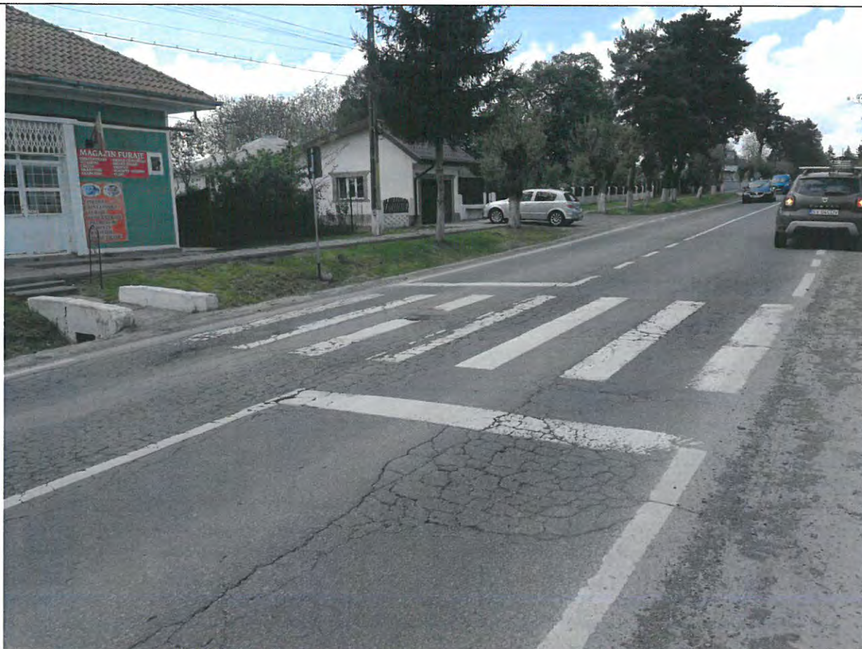
Foto 63: Drumul National DN 29B, km 21+000 -22+000 – Faientari in panza de paianjen si in placi pe suprafete extinse. Fagase pe zonele marginale.
