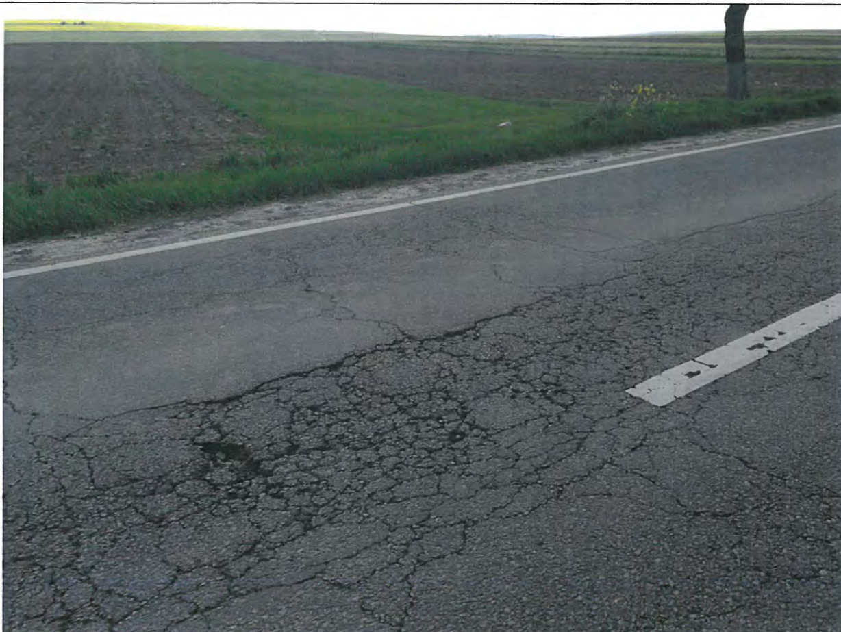
Foto 67: Drumul National DN 29B, km 22+000 -23+000 – Faientari pronuntate pe suprafete extinse. Fagase longitudinale.
