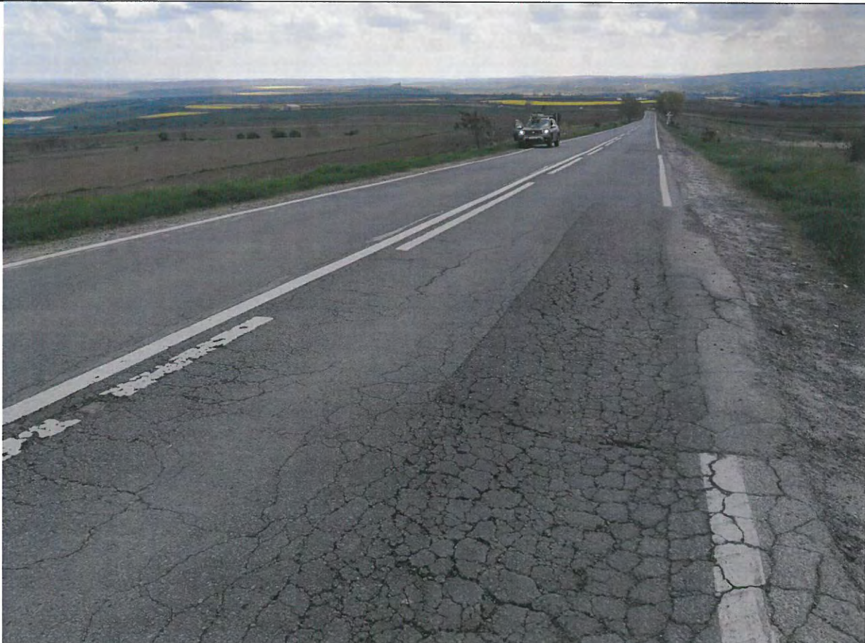
Foto 50: Drumul National DN 29B, km 18+000 -19+000 – Faientari pe suprafete extinse, plombari marginale. Fagase longitudinale.
