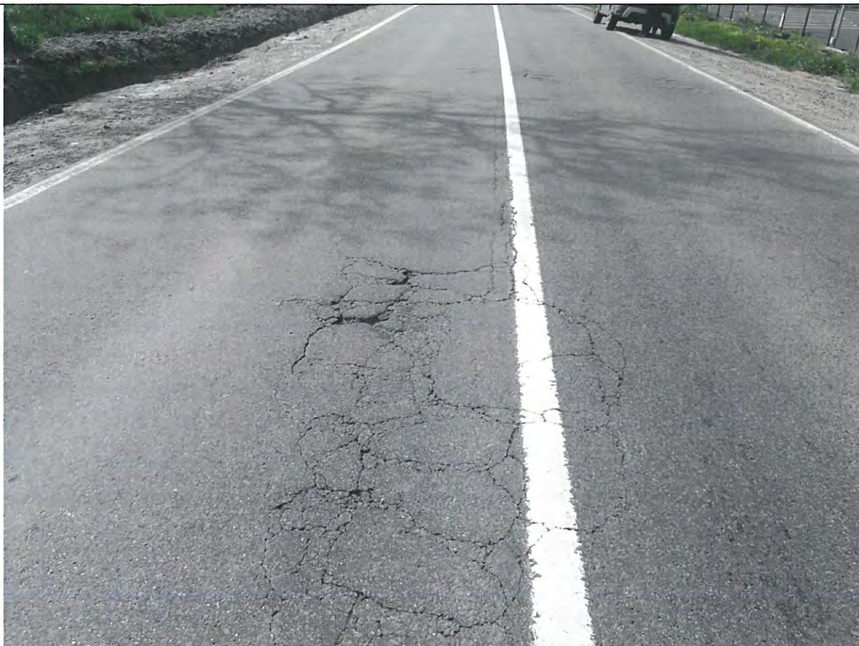
Foto 15: Drumul National DN 29B, km 9+000 -10+000 – Faientari in panza de paianjen si in placi pe zona mediana.
