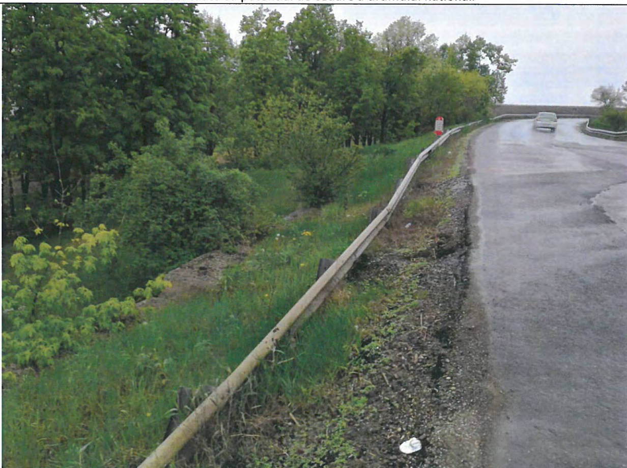
Foto 34: Drumul National DN 29B, km 14+000 -15+000 – Acostament si taluz de rambleu cedat cu extindere spre axul drumului national.
