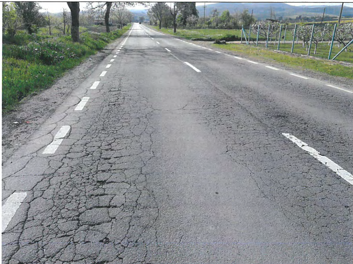
Foto 41: Drumul National DN 29B, km 16+000 -17+000 – Faientari pronuntate pe suprafete extinse, fagase longitudinale.
