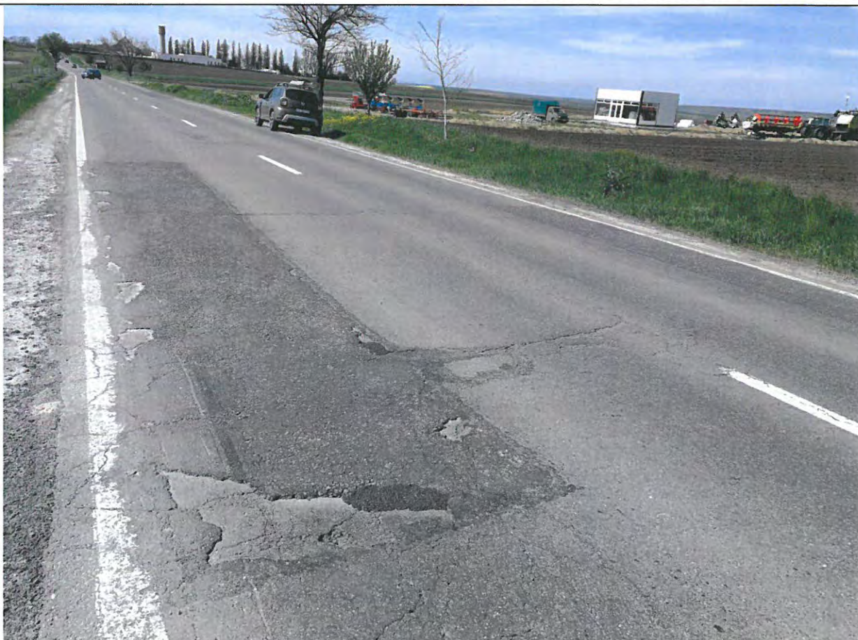
Foto 12: Drumul National DN 29B, km 8+000 -9+000 – Desprinderi locale mixtura lucrari de reparatii. Fisuri transversale. Faientari pe zonele marginale.
