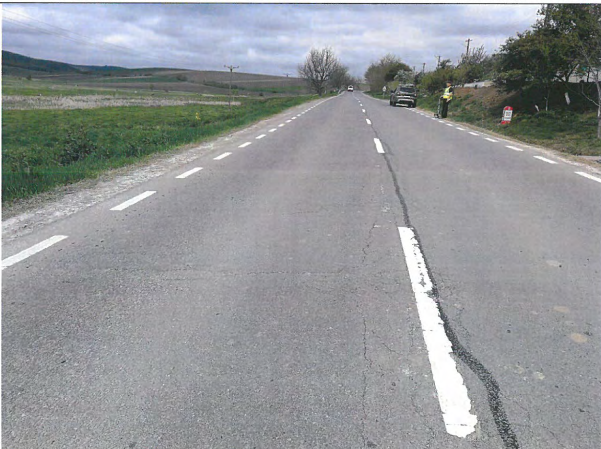
Foto 24: Drumul National DN 29B, km 11+000 -12+000 – Usoare tasari pe zona de debleu. Colmatare fisuri longitudinale cu mastic bituminos.
