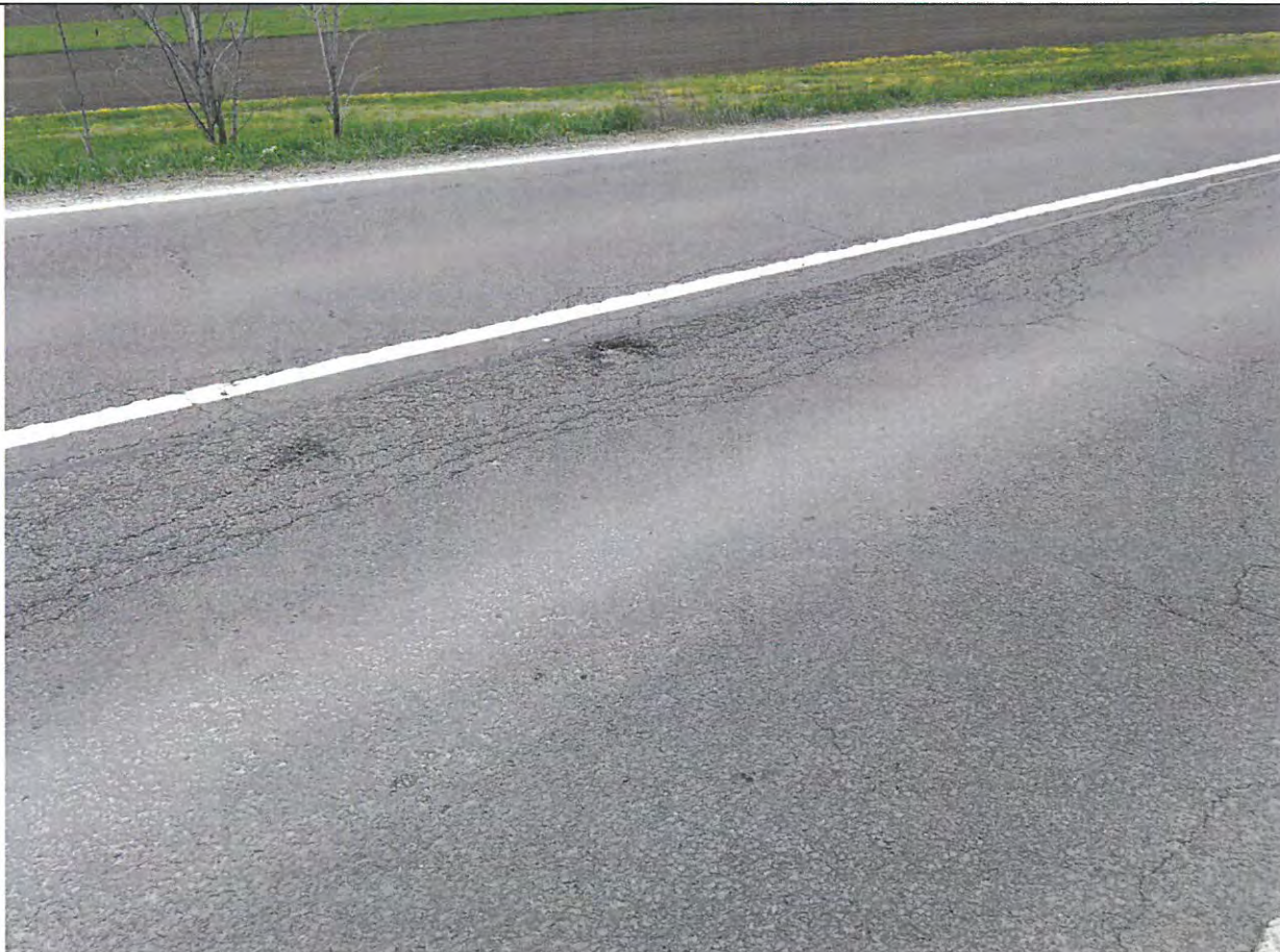
Foto 28: Drumul National DN 29B, km 12+000 -13+000 – Gropi si faiantari pe zona mediana.
