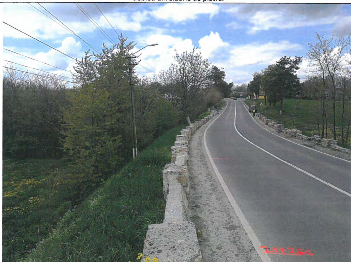
Foto 62: Drumul National DN 29B, km 21+000 -22+000 – Parapet din zidarie de piatra rotit, taluz de rambleu cu pante accentuate.
