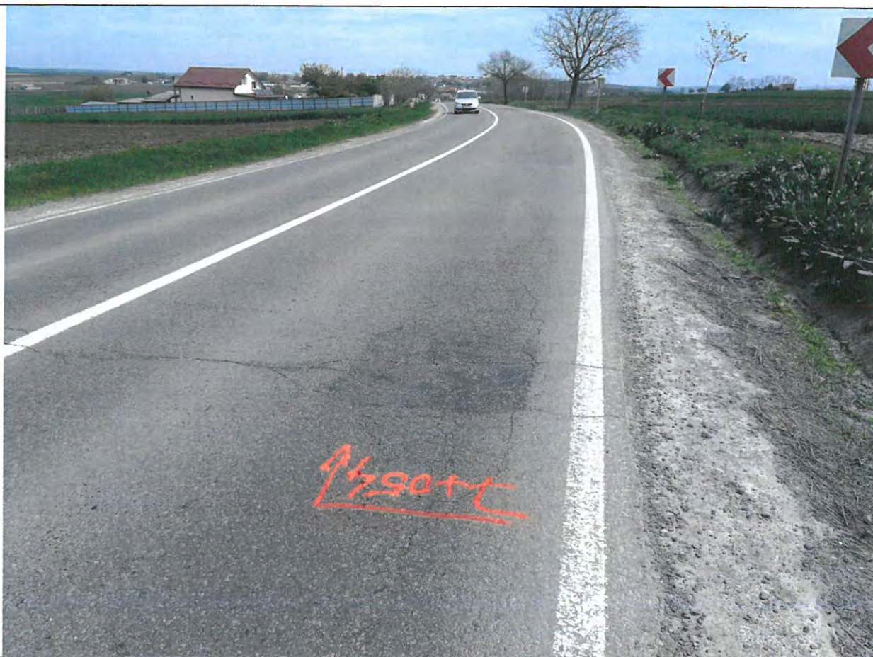
Foto 5: Drumul National DN 29B, km 7+000 -8+000 – Fisuri transversale. Faiantari pe zonele marginale. Fagase longitudinale marginale
