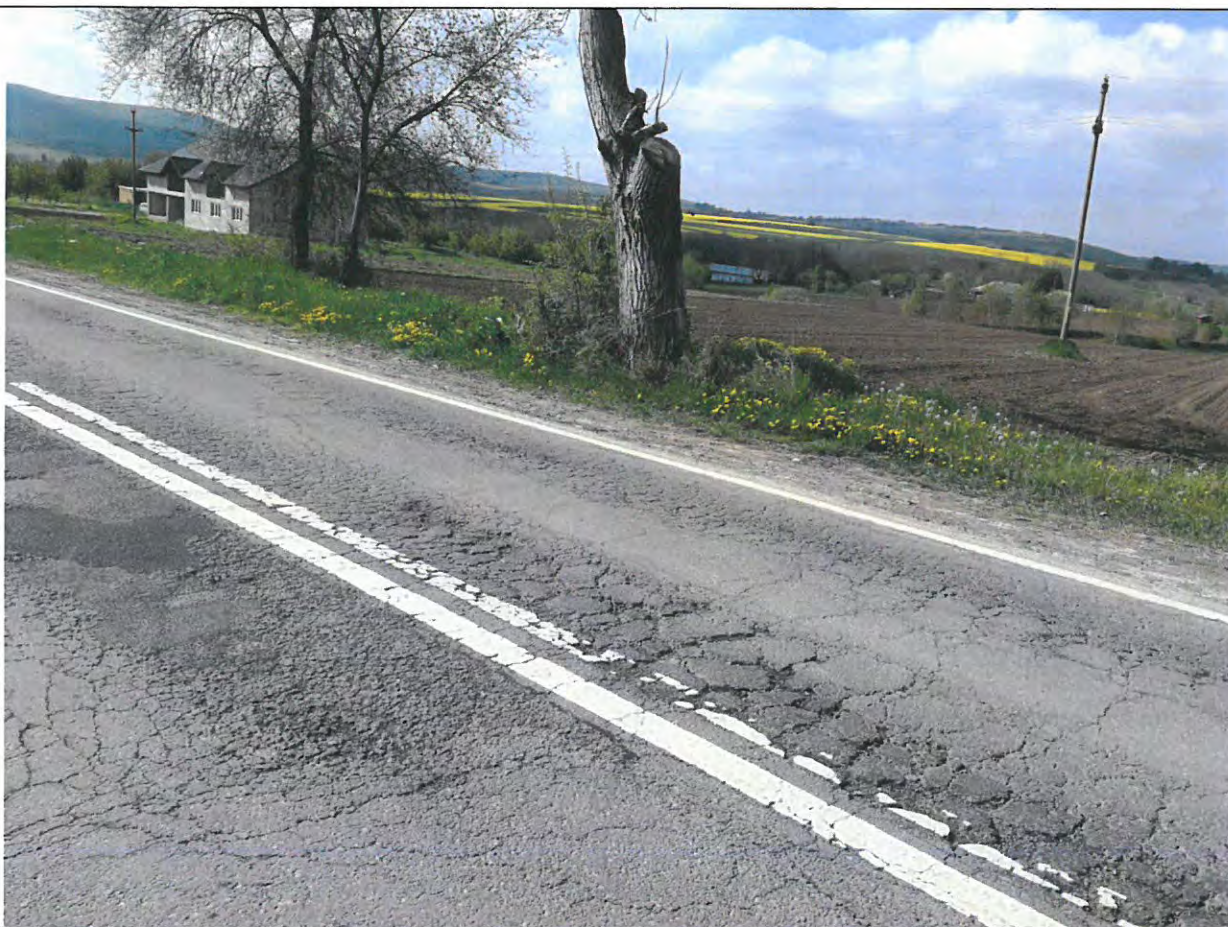
Foto 43: Drumul National DN 29B, km 16+000 -17+000 – Faiantari pronuntate pe suprafete extinse, fagase.
