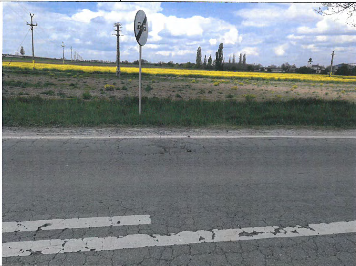
Foto 58: Drumul National DN 29B, km 20+000 -21+000 – Fagase longitudinale, faiantari pe zona mediana.
