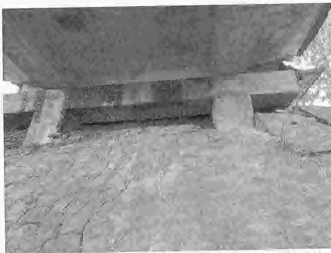
Foto.6 - Defecte de suprafață ale feței văzute: culoare neuniformă, pete negre, impurități, aspect prafuit aspect
