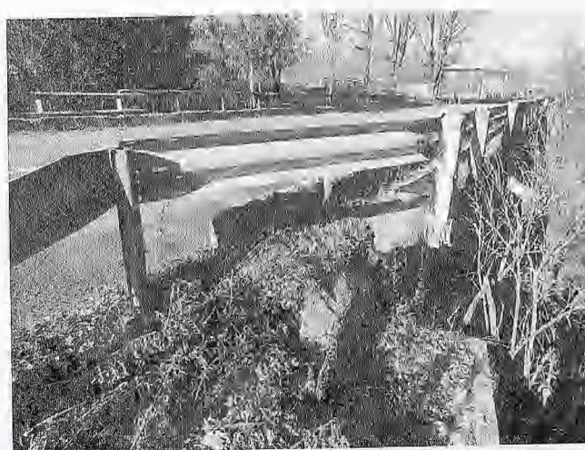
Foto. 4 - Rampe de acces degradate (denivelări și degradări ale căii si acostamentelor, tasări ale terasamentelor, alunecări laterale).
