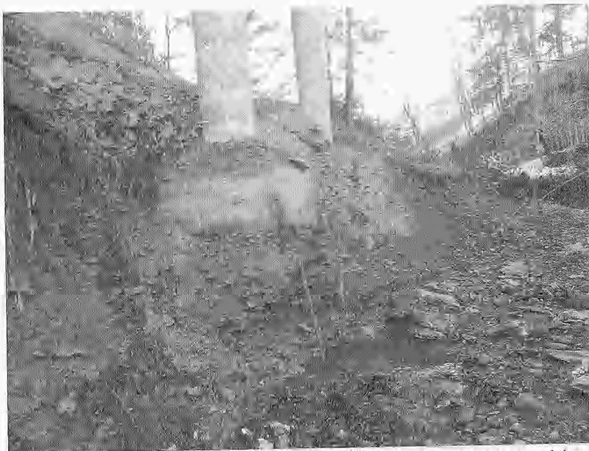
Foto. 9 - Afuierea blocului de fundatie a culeii, coborarea talvegului in zona podului
