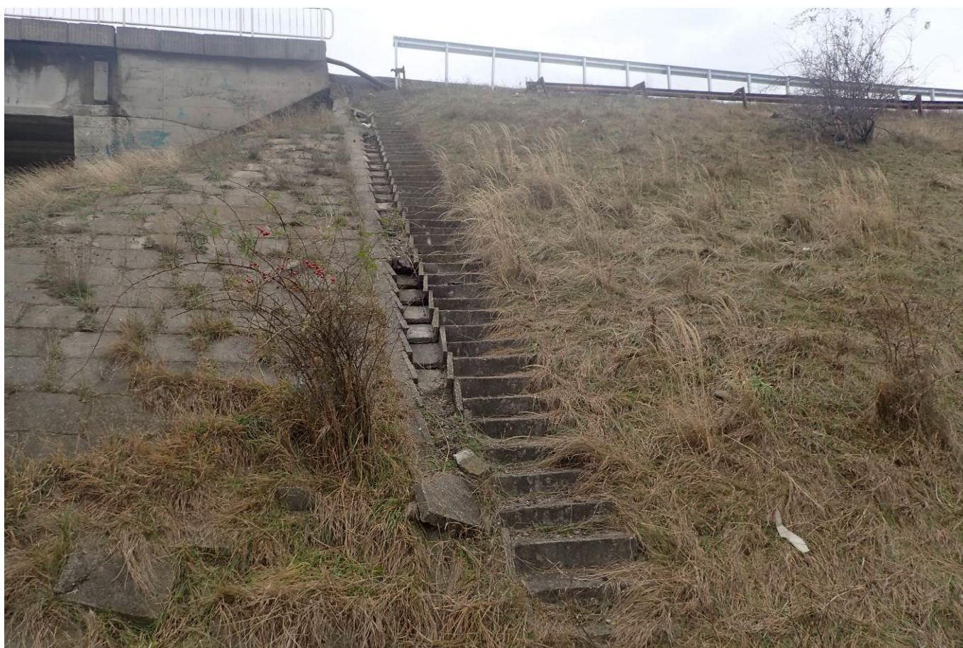
FOTO 22. Vedere a casurilor si scarilor de pe taluz ce prezinta defecte majore si elemente lipsa
