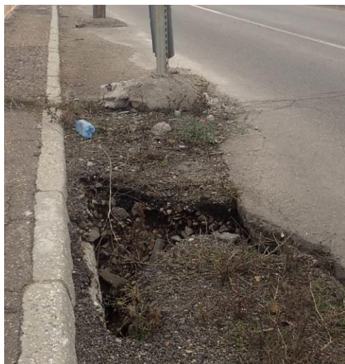
FOTO 28. Groapa in cale in dreptul culei Focsani
