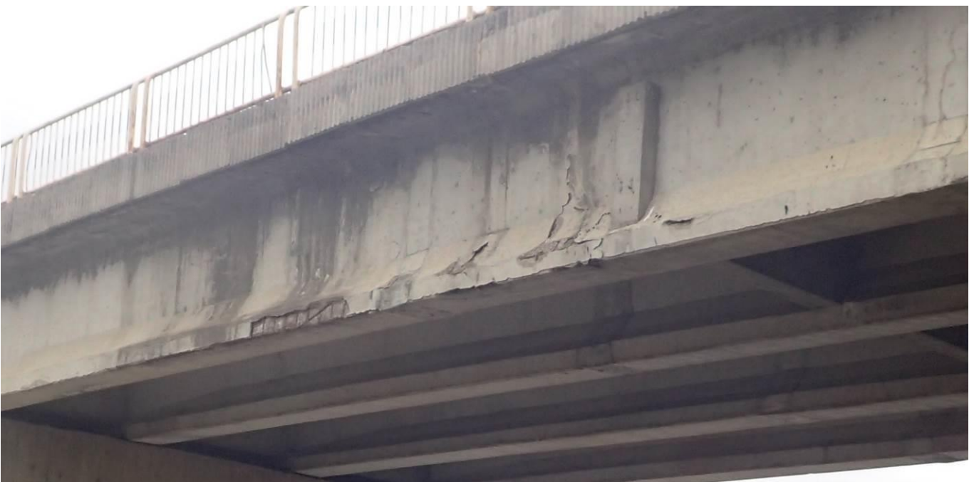
FOTO 6. Grinzile marginale ce prezinta zone cu beton exfoliat si armaturi fara strat de acoperire.
