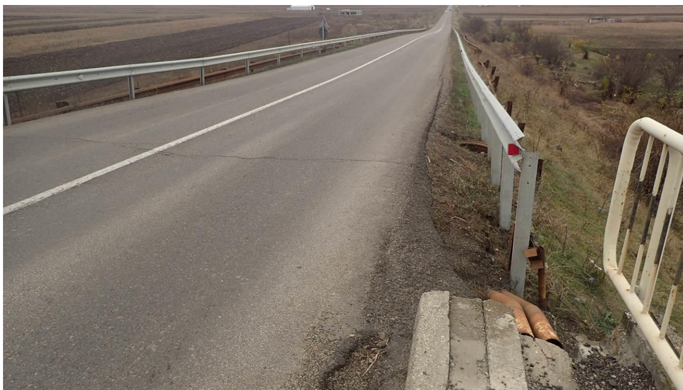
FOTO 20. Tasari accentuate si crapaturi pe rampe in zona placilor de racordare, lipsa acces pe trotuar
