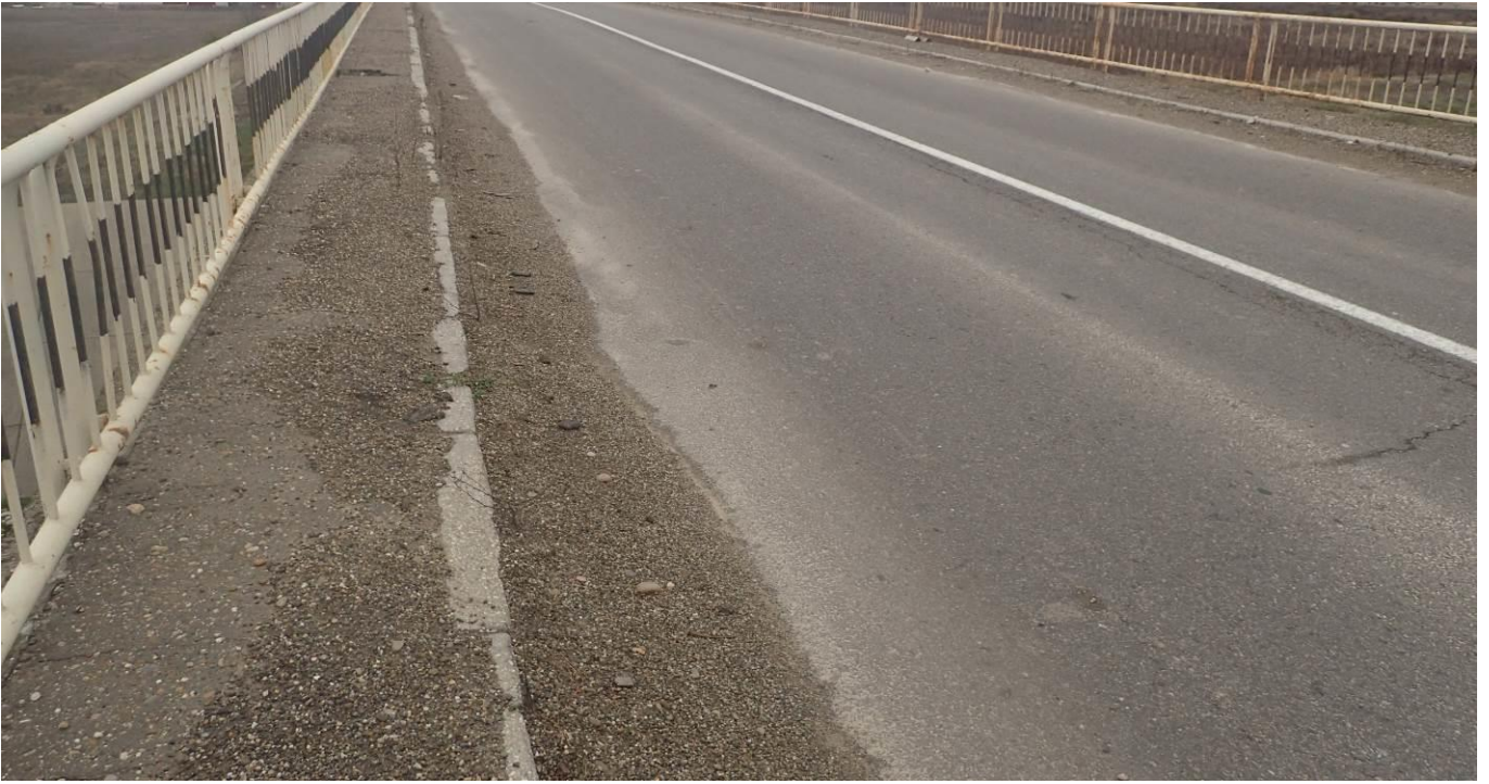
FOTO 23. Vedere cale pe pod cu fisuri pe cale depuneri de material solid in zona bordurilor
