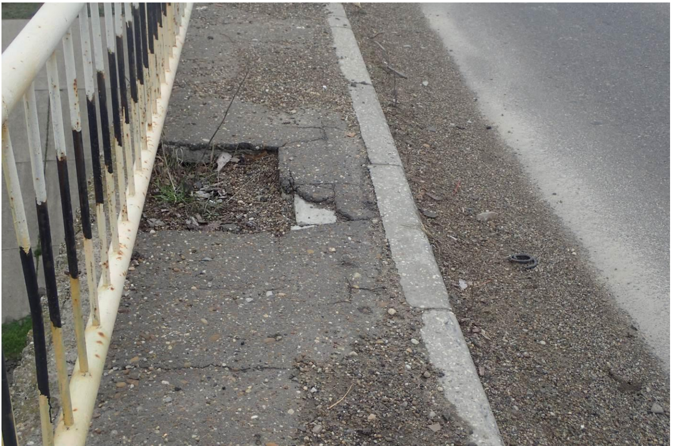
FOTO 26. Trotuar cu gropi – placa de acoperire a golului din trotuar ruptă
