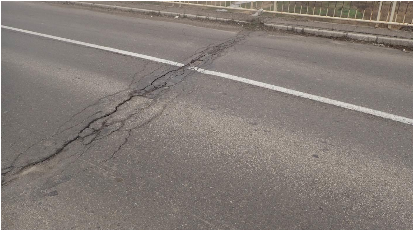
FOTO 25. Vedere in zona rostului de dilatație unde se observă degradări importante
