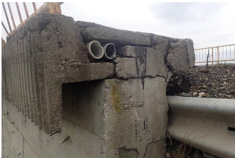
FOTO 29. Aliniere necorespunzatoare pod-rampe
