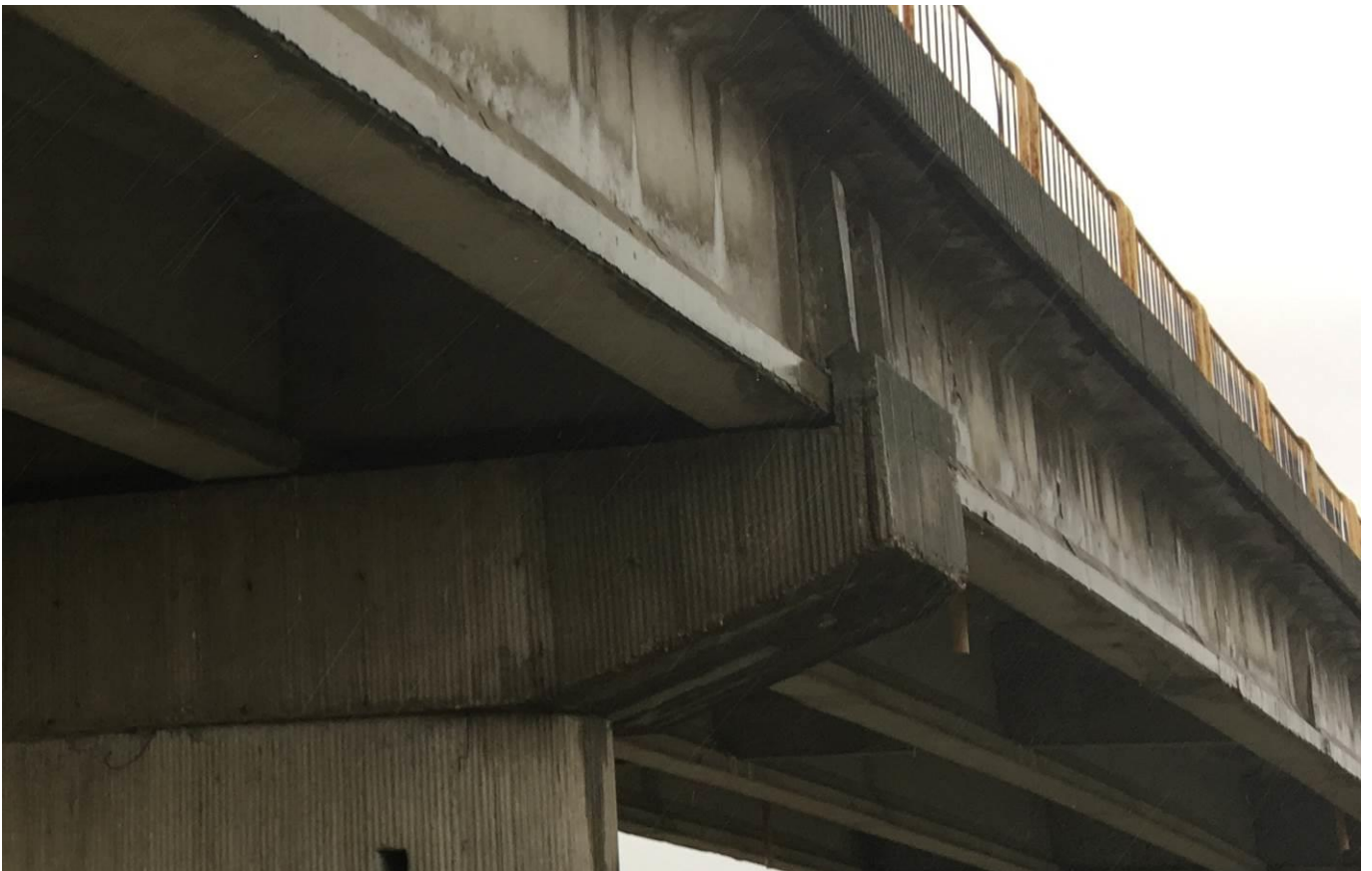
FOTO 12. Vedere rigla pila defecte de suprafata ale fetei vazute (culoare neuniforma, pete negre, impuritati), infiltratii
