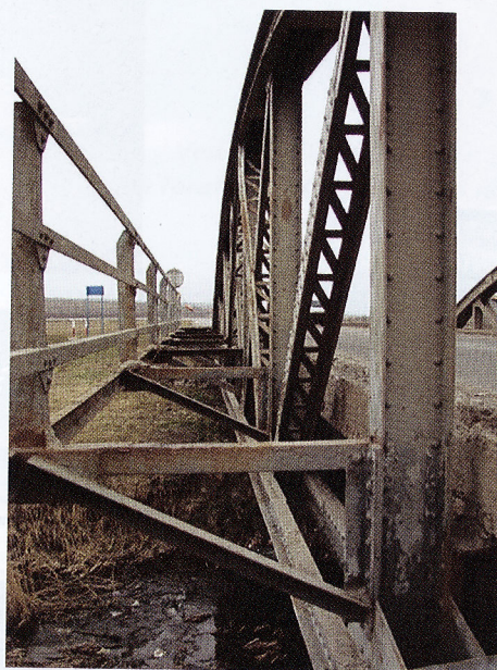
Fig.5. Trotuarele podului sunt puternic degradate
