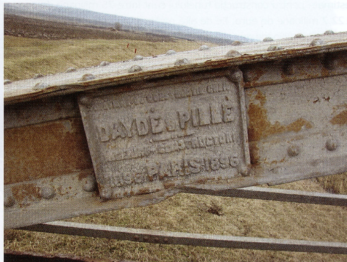
Plăcuța montată la baza uneia dintre arce, cu mențiunea firmei producătoare
