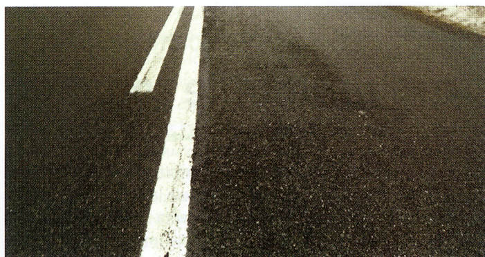
Crăpături și fâgașe, produse de vehiculele grele cu lemne
